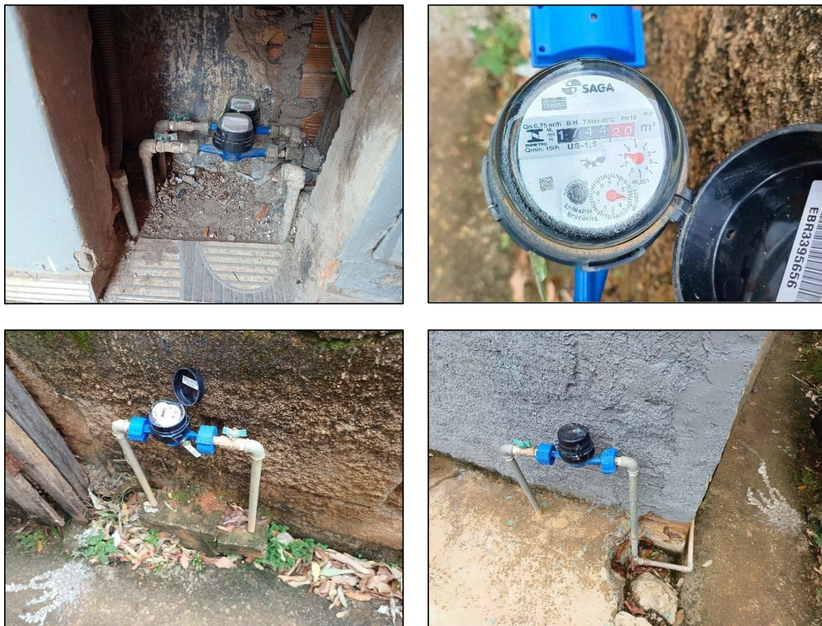
Figura 18 - Hidrômetros na sede.
