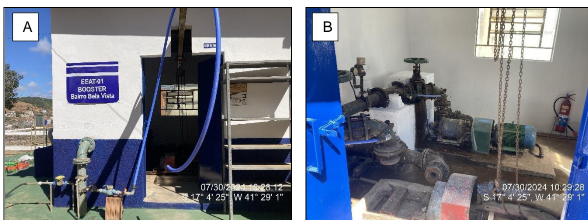
Legenda: A – Entrada da EEAT-01; B – Vista do interior da EEAT-01.
