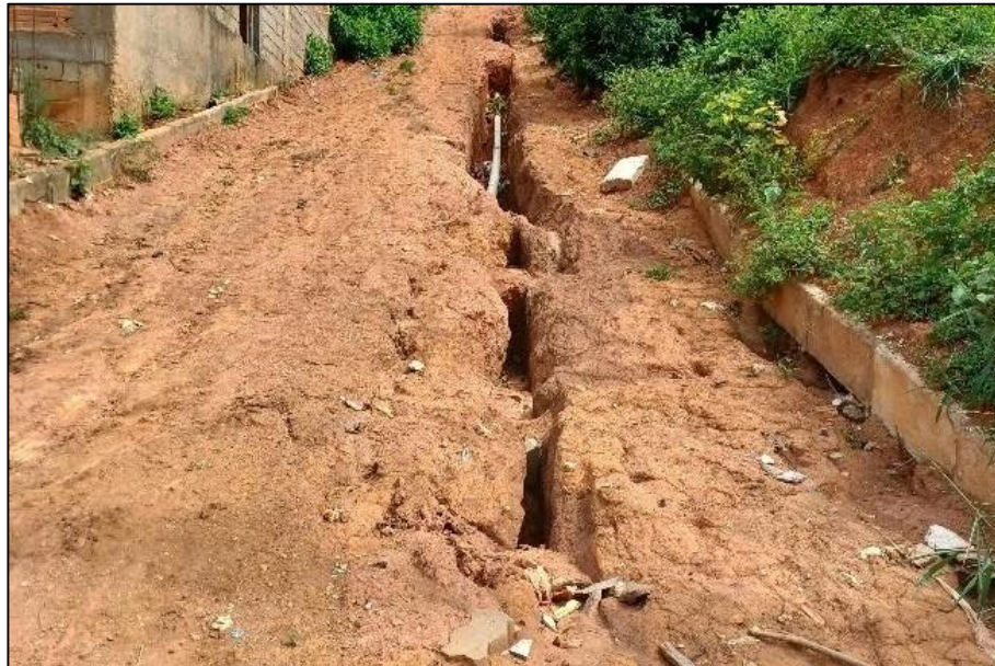
Figura 25 - Rede Coletora exposta, bairro Vila Oeste.
