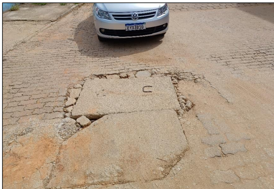
Figura 26 - PV com tampa de concreto necessitando substituição (rua Osório Castro Alves).
