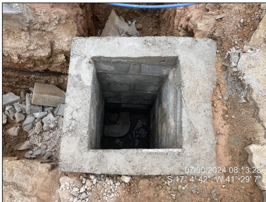
Figura 29 - Ponto de entupimento e onde a rede coletora passava por baixo de um imóvel particular.
