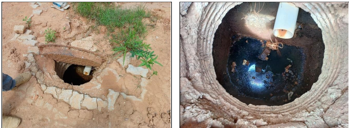
Figura 24 - Lançamento clandestino em rede de drenagem pluvial, próximo ao Fórum (Rua Prof. Teodoro Rezende).
