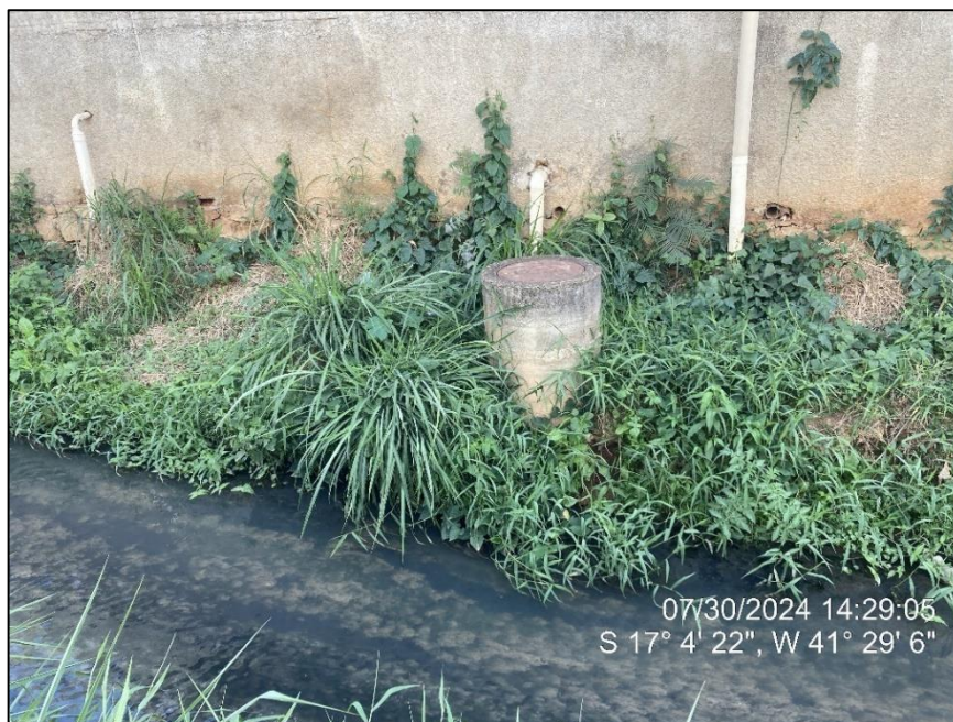
Figura 32 - PV com diâmetro de 80 cm, que dificulta a entrada dos funcionários para limpeza e desentupimento.
