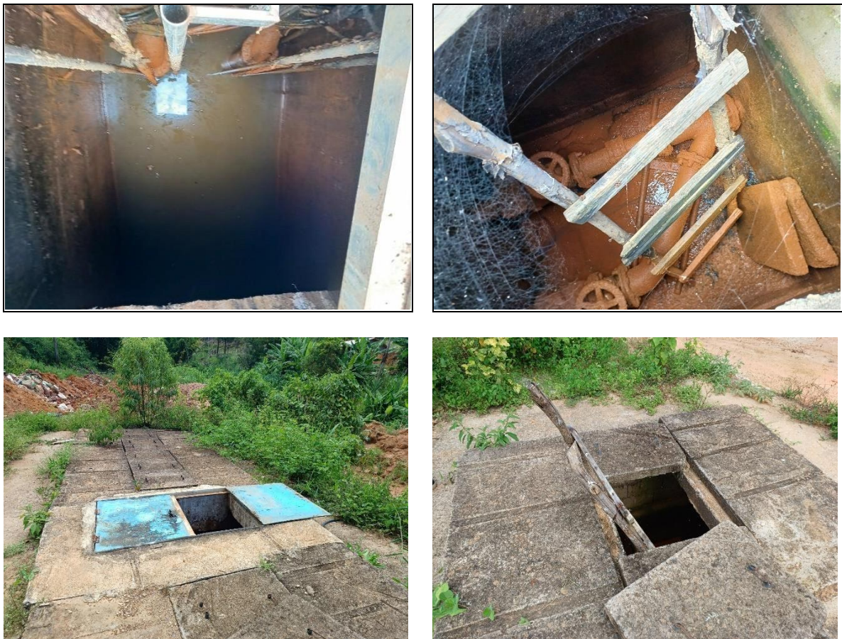
Figura 37 - Elevatória de esgoto bruto final (EEE Final).
