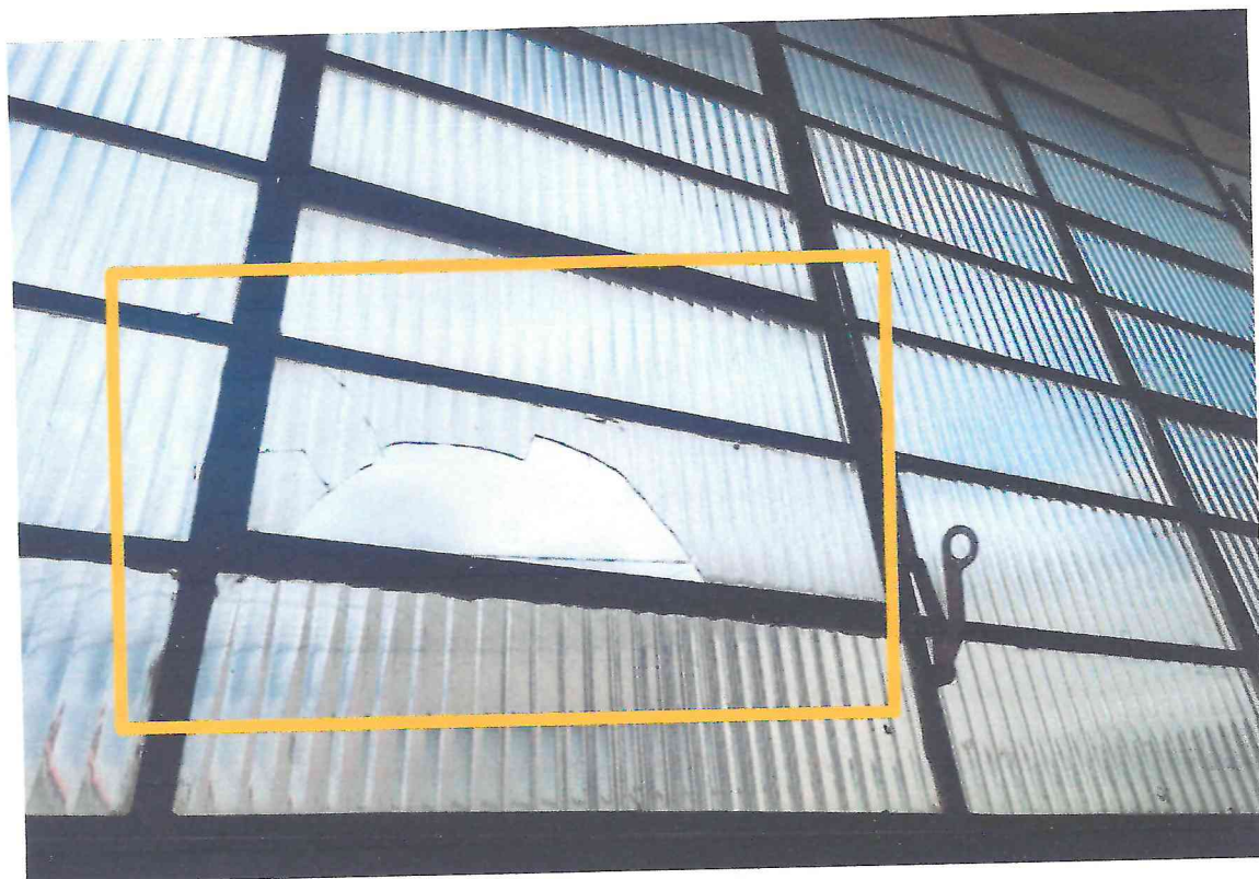
VIDRO DANIFICADO NA JANELA DA SALA DO PREFEITO MUNICIPAL
