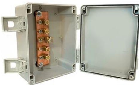
Figura 8: Caixa com Barramento de Equipotencialização Principal (BEP).
