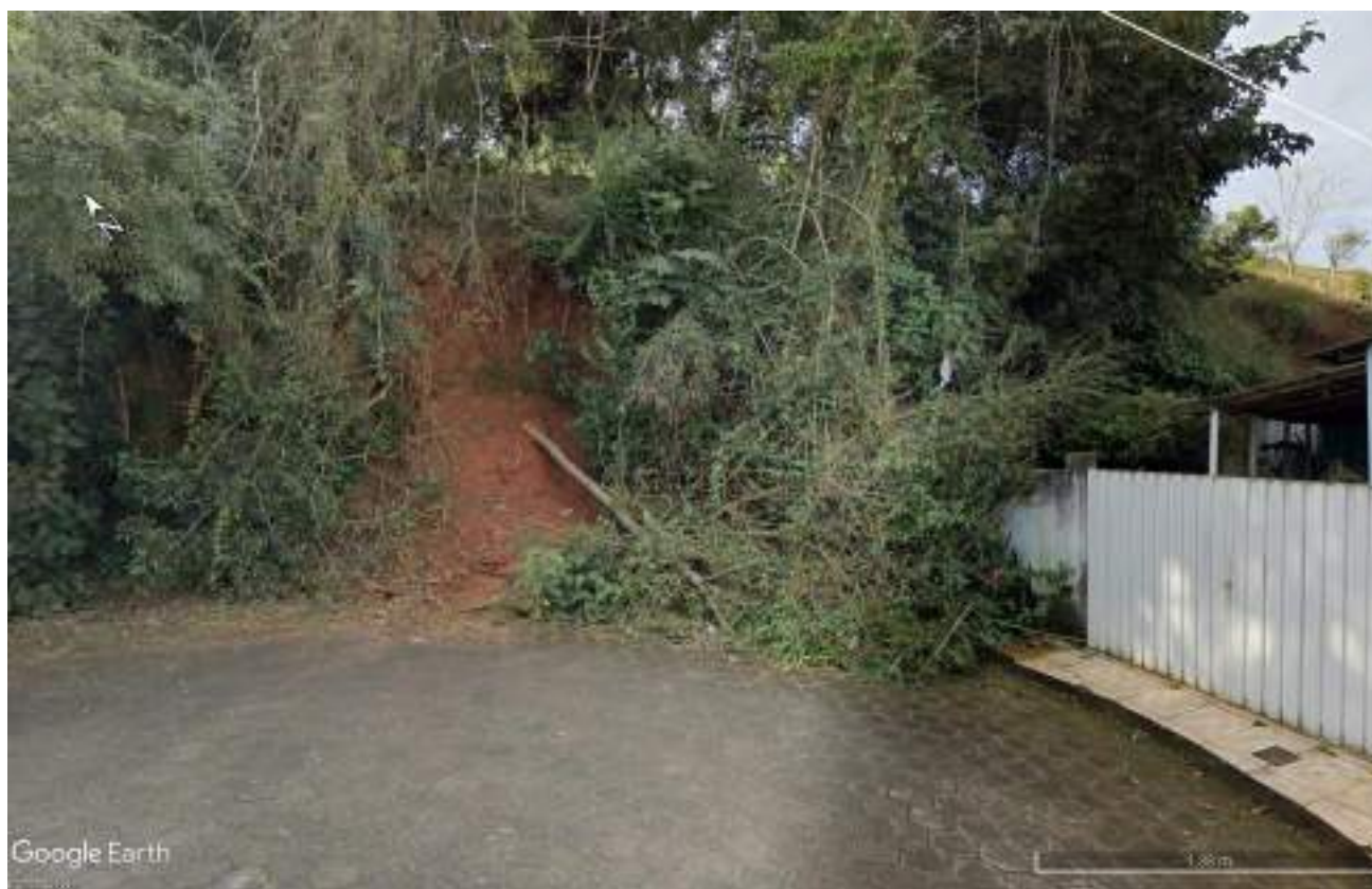
Figura 119 - Deslizamento da área do no Vale das Andorinhas
