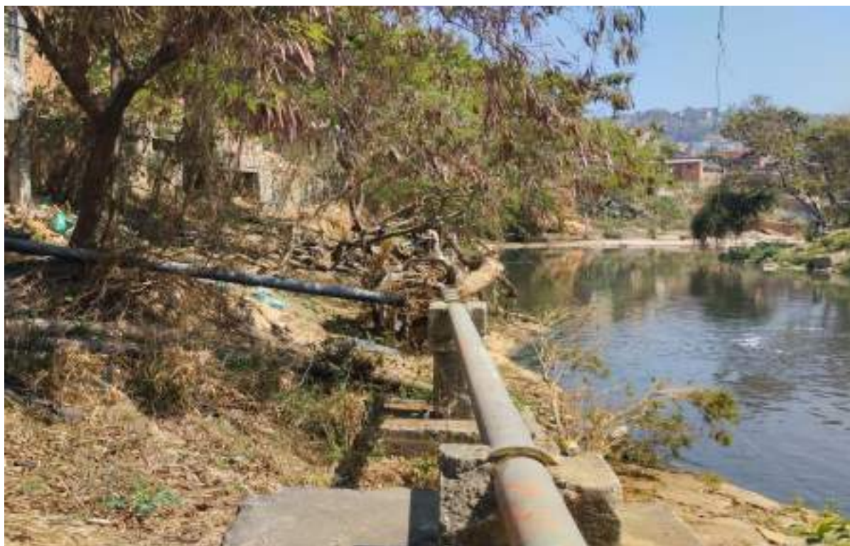
Figura 12: Evidência de canos de esgoto possivelmente clandestinos nas margens do curso d'água e interceptor rompido. Fonte: GLUAI, 2024.
