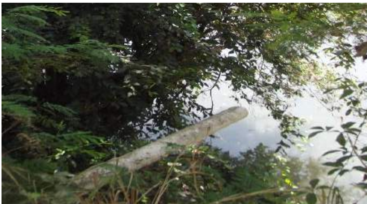
Figura 43: Cano visível na margem do rio, registrado na área de estudo, que sugere um potencial lançamento de efluentes direto no curso d'água. Fonte: GLUAI, 2024.
