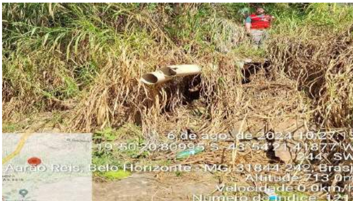
Figura 15: Pontos críticos relacionados a possíveis esgotos clandestinos e canos rompidos. Fonte: GLUAI, 2024.
