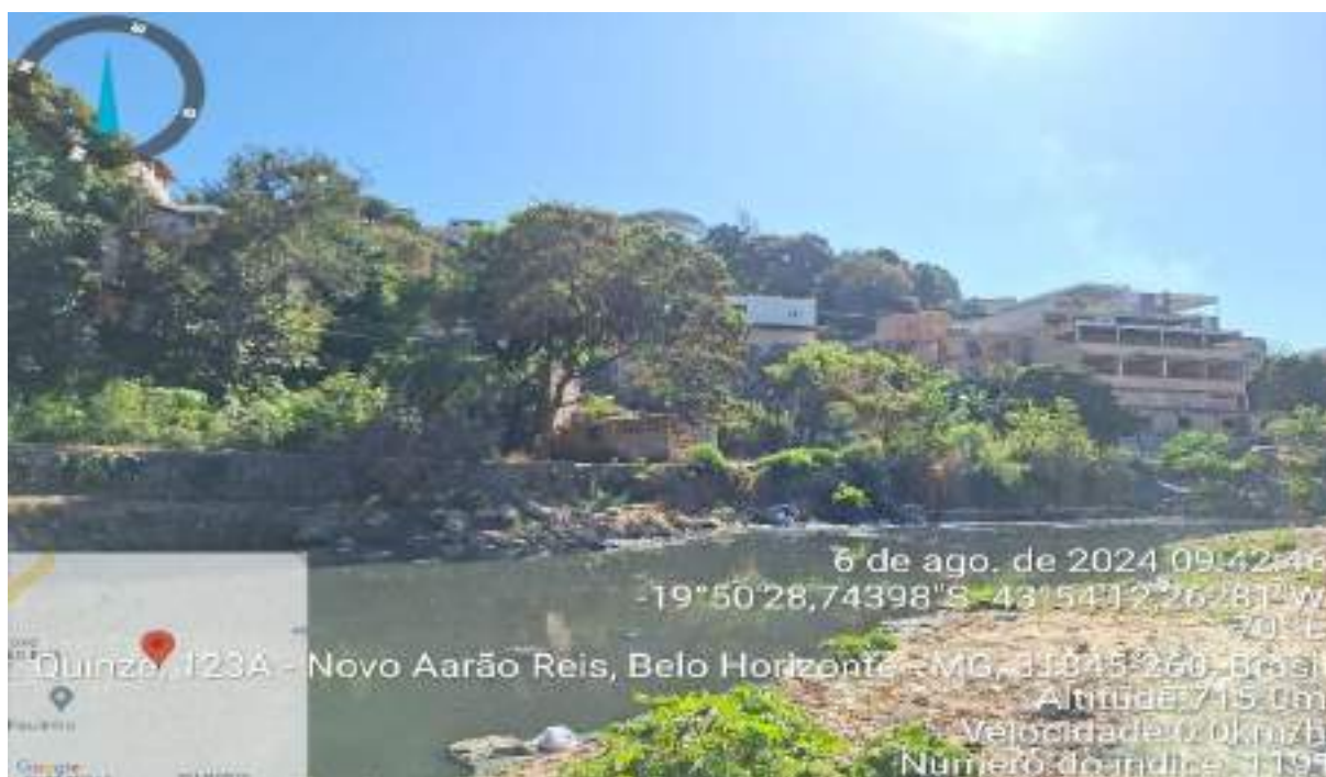
Figura 4: Curso d'água ilustrando a antropização nas proximidades e a presença de gabião comprometido. Fonte: GLUAI, 2024.
