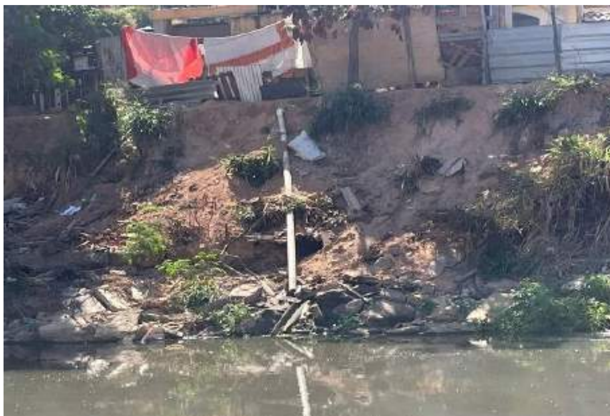
Figura 44: Cano visível na margem do rio, registrado na área de estudo, que sugere um potencial lançamento de efluentes direto no curso d'água. Fonte: GLUAI, 2024.
