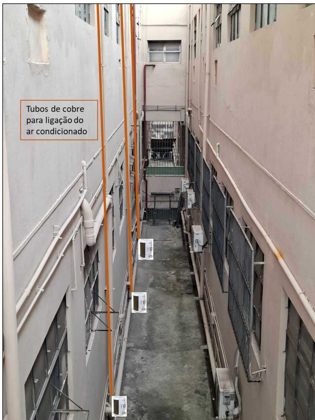
Figuras 5 – Local previsto para instalação das condensadoras.
