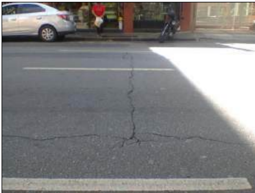
Figura 15 – Aspecto das trincas transversais
