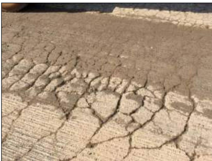
Figura 16 – Aspecto das trincas por reflexão sobre o pavimento pós-fresagem
