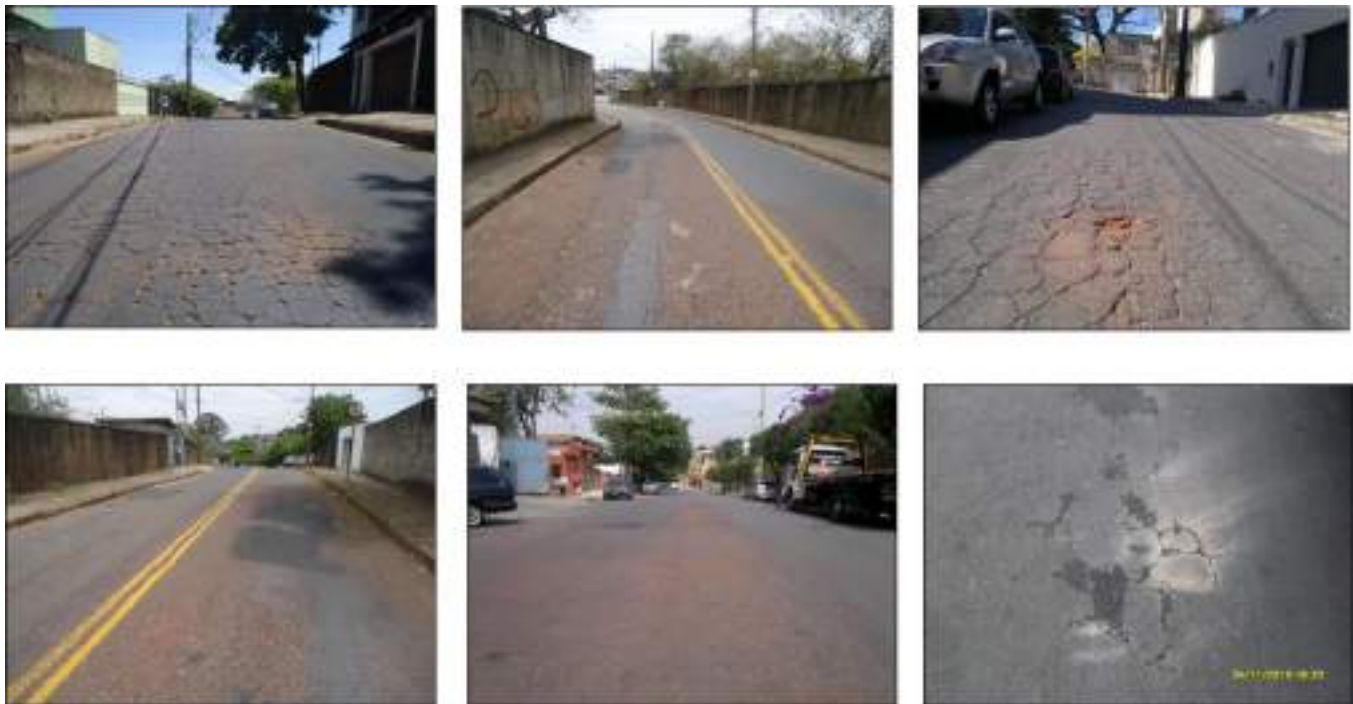
Figura 29 - Aspecto do bombeamento de finos do material de base de pavimentos asfálticos
