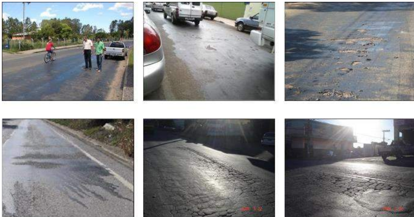
Figura 22 – Aspecto de exsudação no revestimento asfáltico
