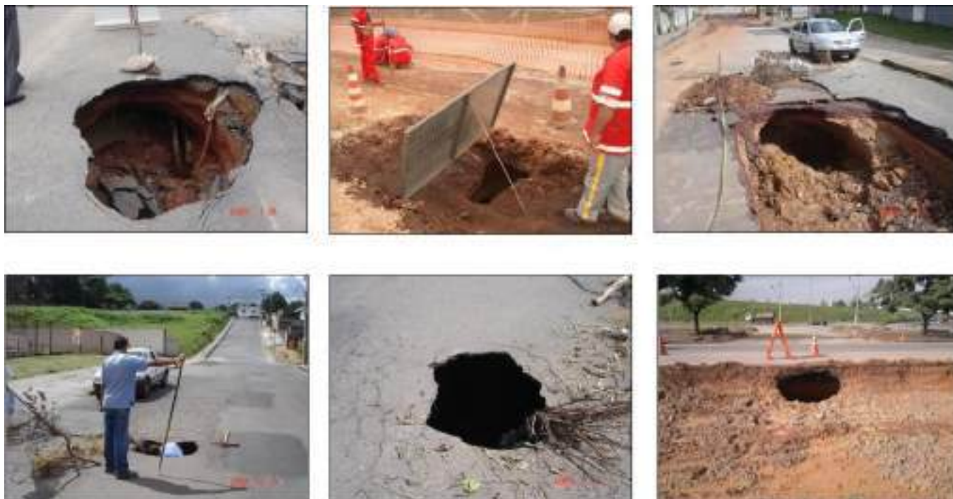
Figura 24 – Aspecto de solapamento de solo em pavimentos
