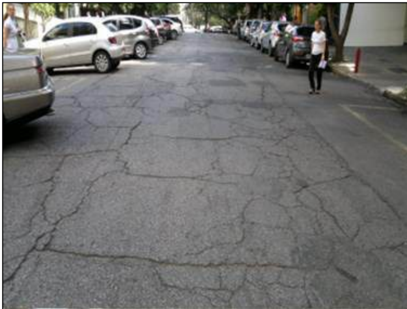
Figura 11 – Aspecto das trincas por envelhecimento
