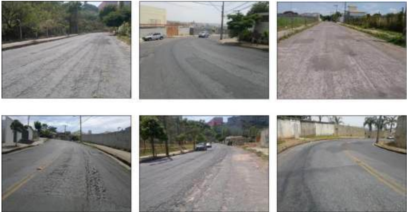
Figura 27 – Aspecto de estriagem em revestimentos asfálticos
