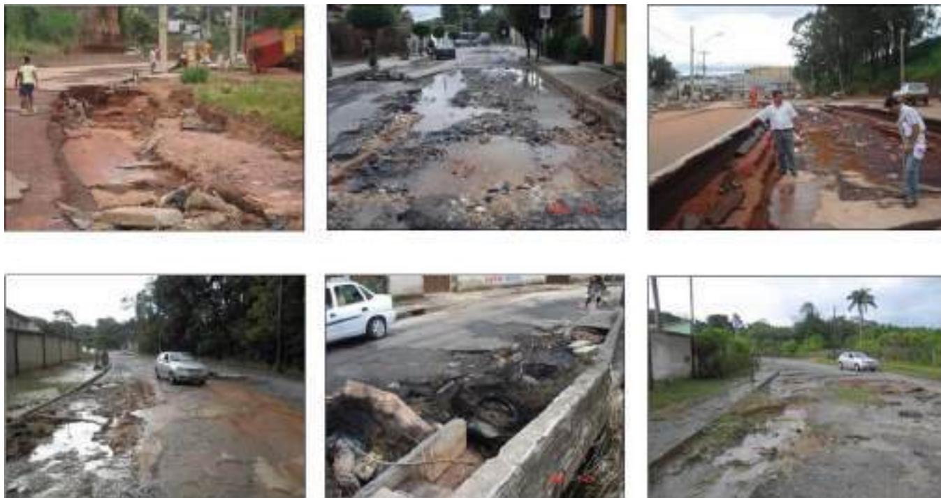
Figura 31 – Aspectos gerais de danos causados por outros fatores não convencionais
