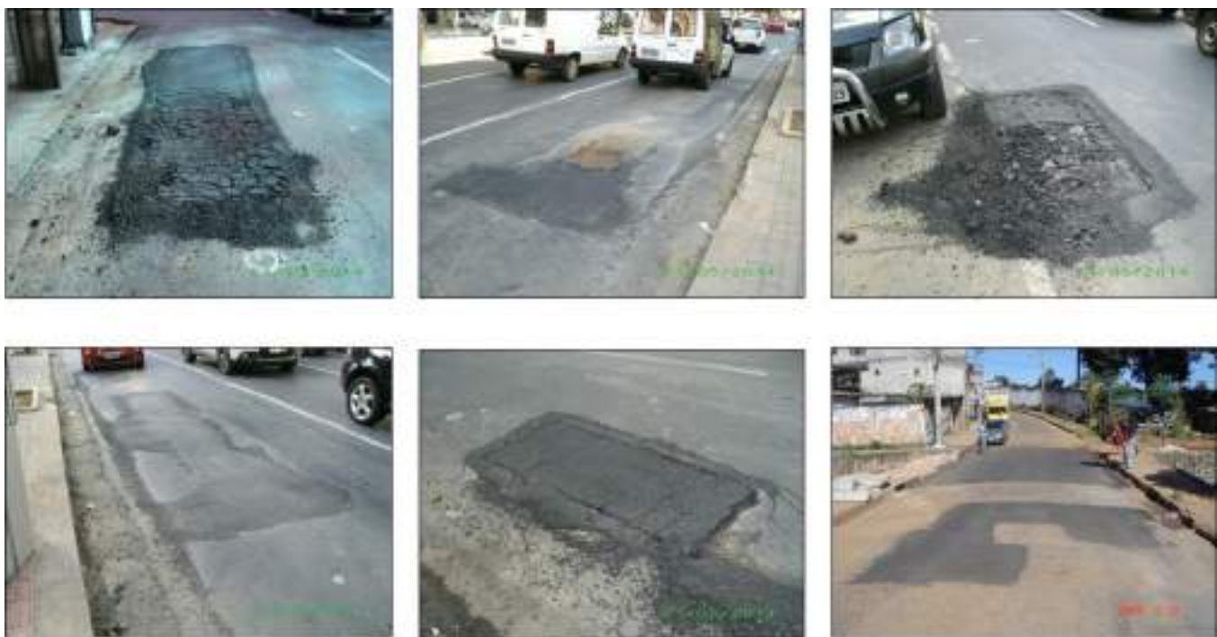
Figura 23 – Aspecto de remendos sobre pavimentos asfálticos
