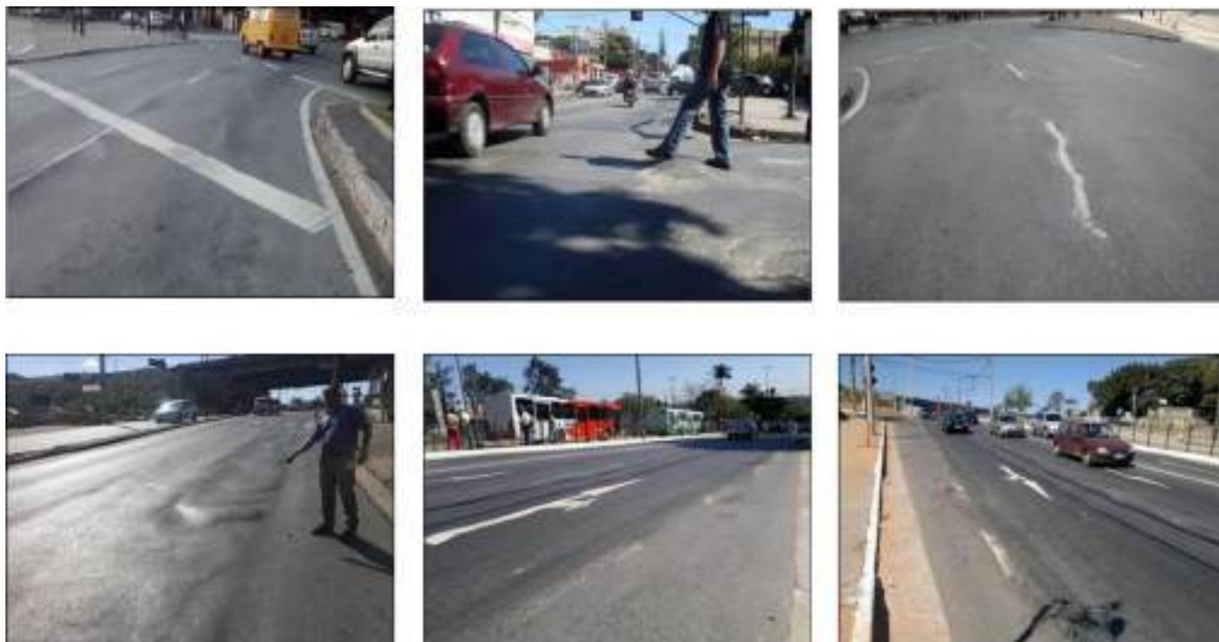
Figura 18 – Aspecto de ondulações / corrugações do revestimento asfáltico
