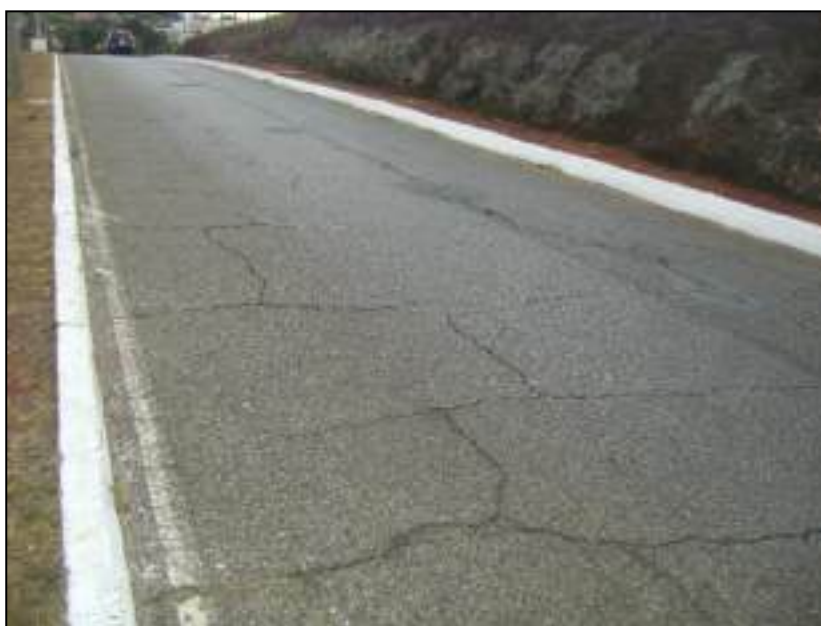
Figura 12 – Aspecto das trincas em blocos
