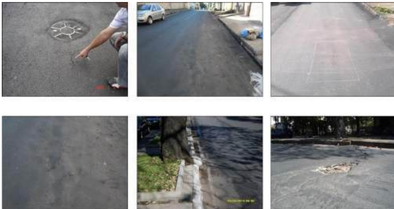
Figura 30 – Aspecto de inchamento de revestimentos asfálticos
