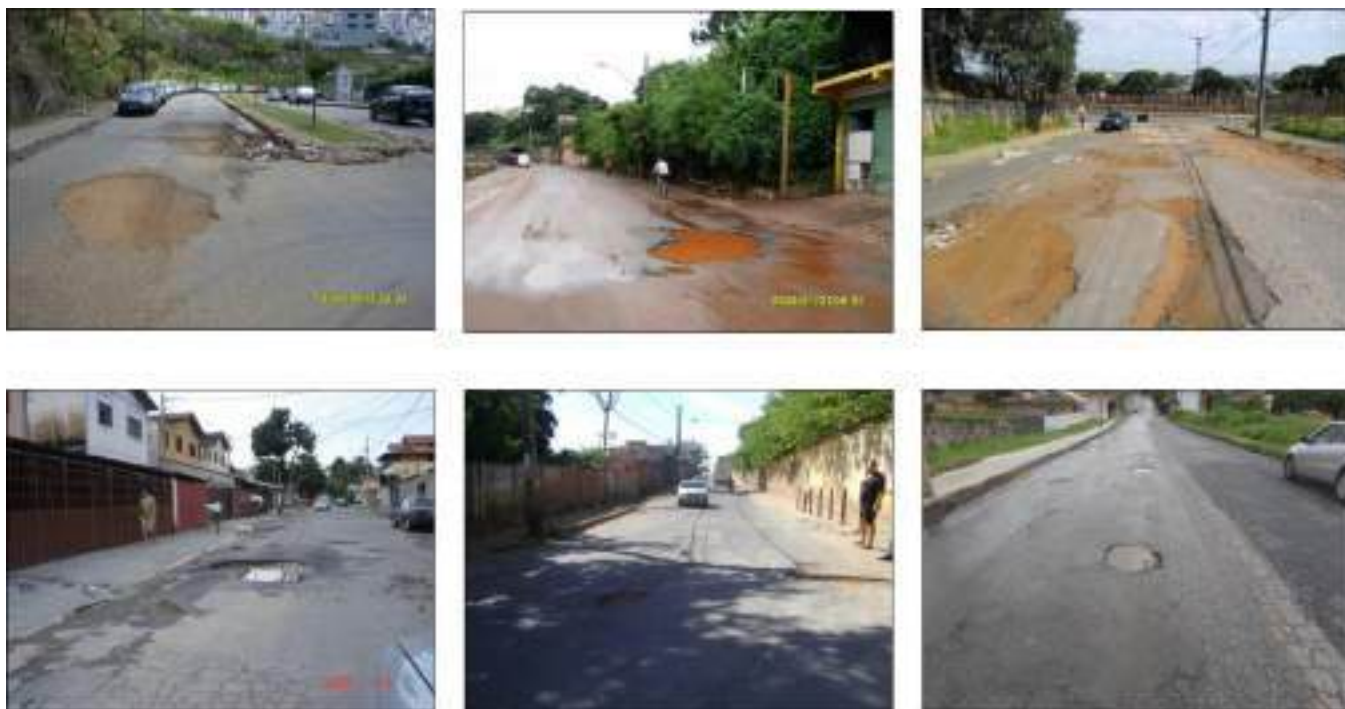
Figura 20 – Aspecto de buracos / “panelas” no pavimento
