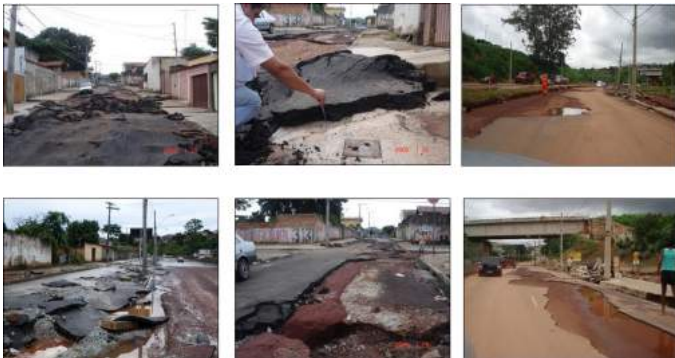
Figura 26 – Aspecto do descolamento de revestimentos asfálticos
