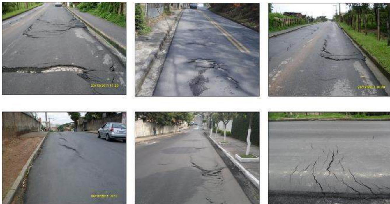
Figura 19 – Aspecto de escorregamento do revestimento asfáltico
