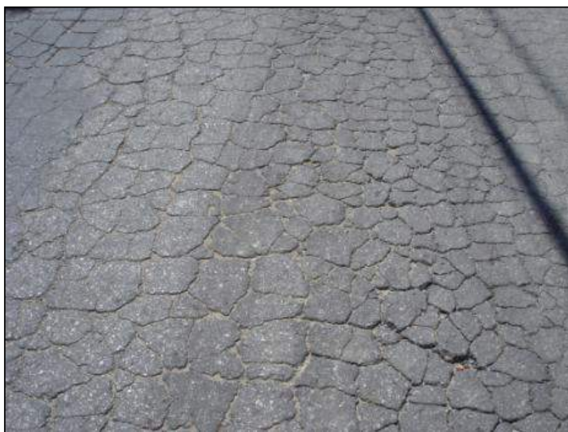
Figura 10 – Aspecto das trincas por fadiga do revestimento
