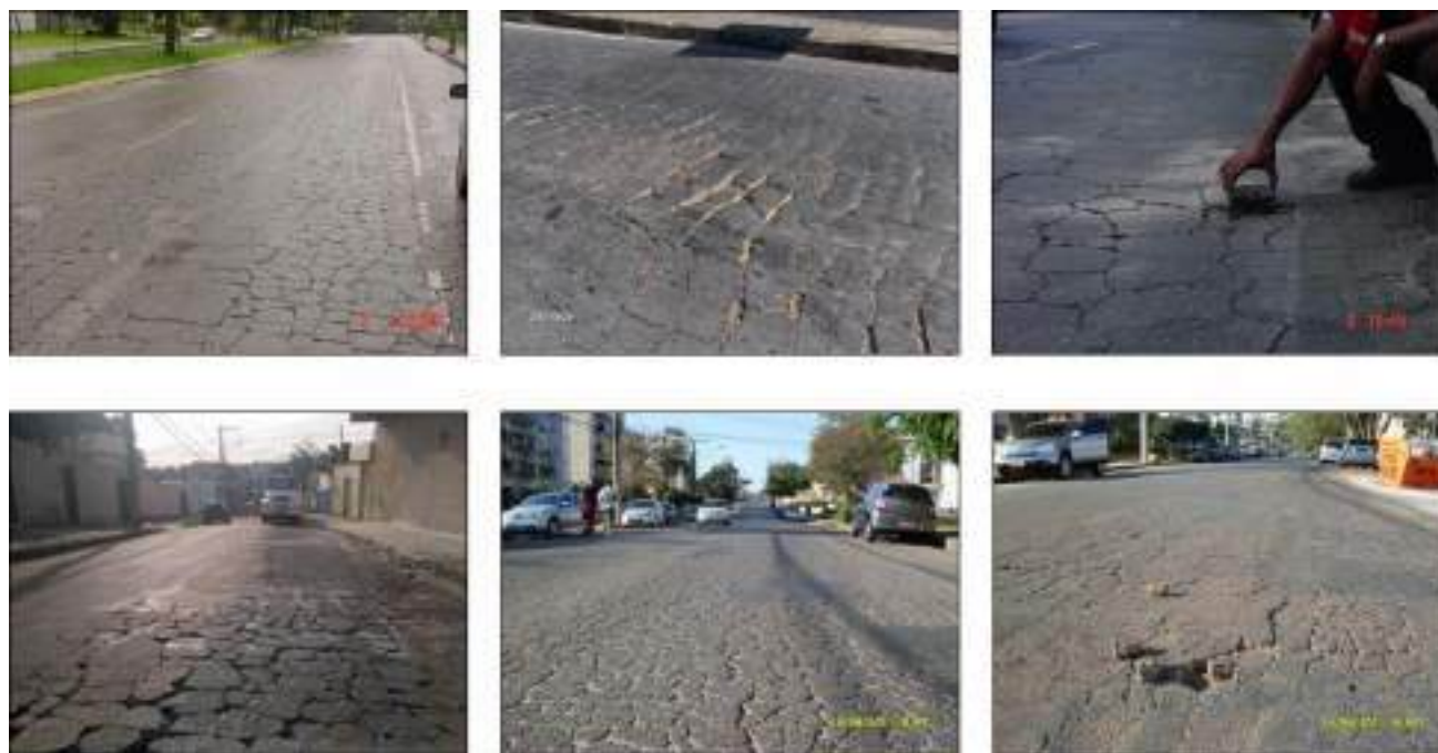
Figura 9 – Aspectos Gerais das Trincas nos Pavimentos Asfálticos
