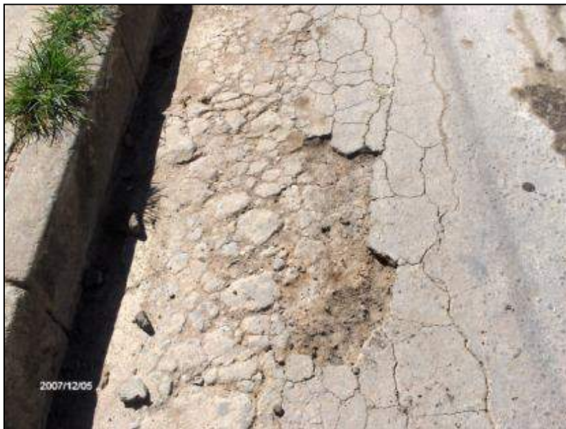
Figura 13 – Aspecto das trincas nos bordos
