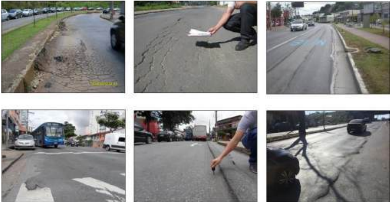
Figura 17 – Aspecto de afundamentos consolidados e deformações permanentes
