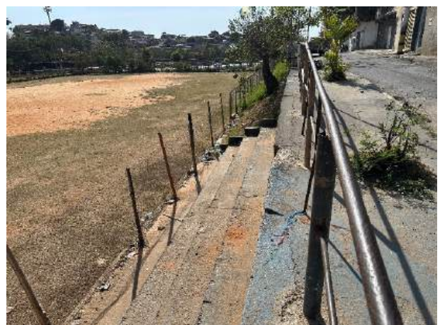
Foto 14 – Vista do campo de futebol e arquibancada (vistoria realizada em 29/09/2025)
