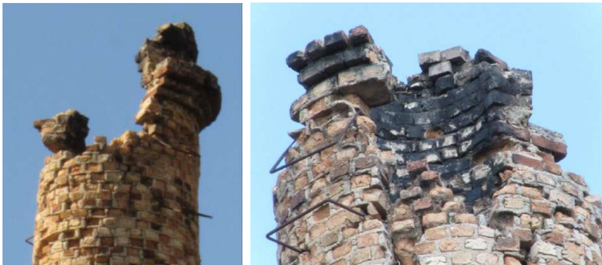
Figura 7 – Vistas gerais da Coroa e de sua extensa degradação
