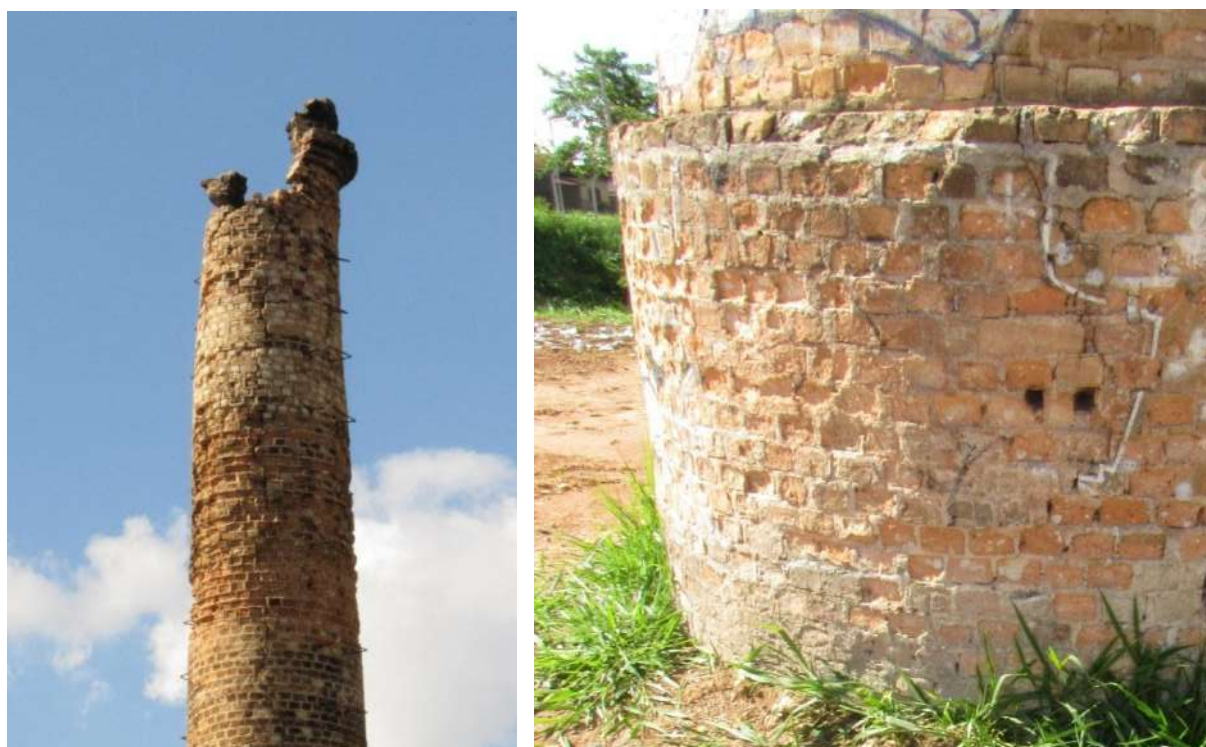
Figura 18 – ESQUERDA: Coroa e região superior do fuste com significativa alveolização e lacunas - Elevação SUL --- DIREITA: Furos e alvéolos na base da chaminé - Elevação OESTE
