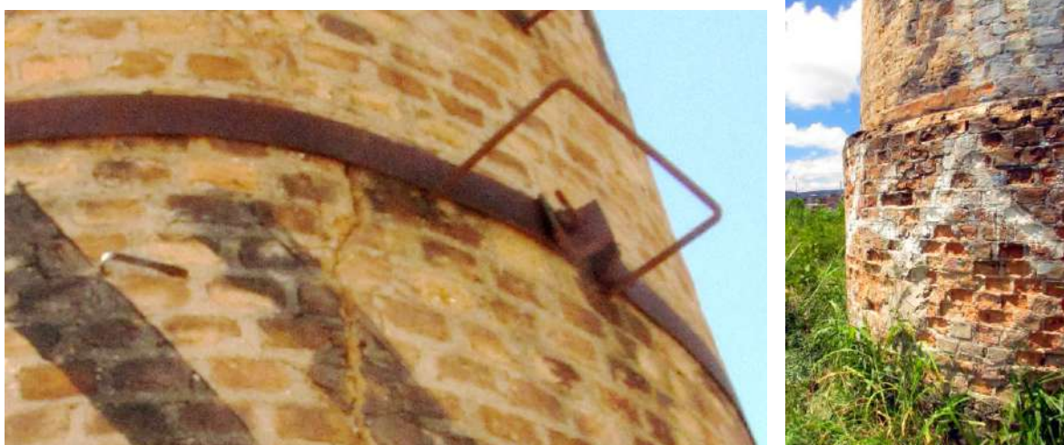
Figura 22 – ESQUERDA: Cinta aparentemente “contida” pelo degrau - Elevação SUL --- DIREITA: Evidência de trecho argamassado com cimento na base - Elevação NORTE
