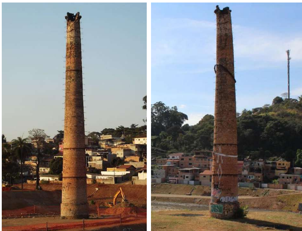
Figura 4 – ESQUERDA: Vista da chaminé anterior ao rompimento do anel de contenção superior (Fonte: web 5 ) --- DIREITA: Vista da chaminé após ruptura do anel superior, por volta do ano de 2018 (Fonte: web 6 )
