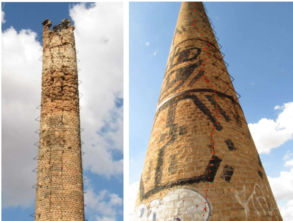
Figura 14 – ESQUERDA: Principais fissuras contínuas verticais - Elevação OESTE --- DIREITA: Detalhe de fissura de menor abertura em formato ziguezague (pontilhado em vermelho) - Elevação SUL
