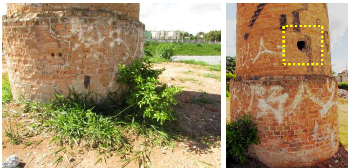
Figura 21 – ESQUERDA: Presença de plantas junto à base da chaminé - Elevação SUL --- DIREITA: Abertura no fuste próximo à base como acesso para pássaros - Elevação LESTE
