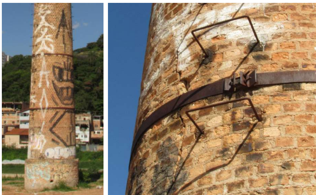
Figura 20 – ESQUERDA: Base e fuste grafitados - Elevação OESTE --- DIREITA: Detalhe de cinta metálica e manchas de ferrugem nos tijolos sob região do conector - Elevação NORTE
