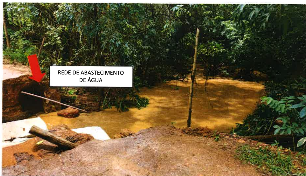
Figura 2: Rede de abastecimento rompido.
