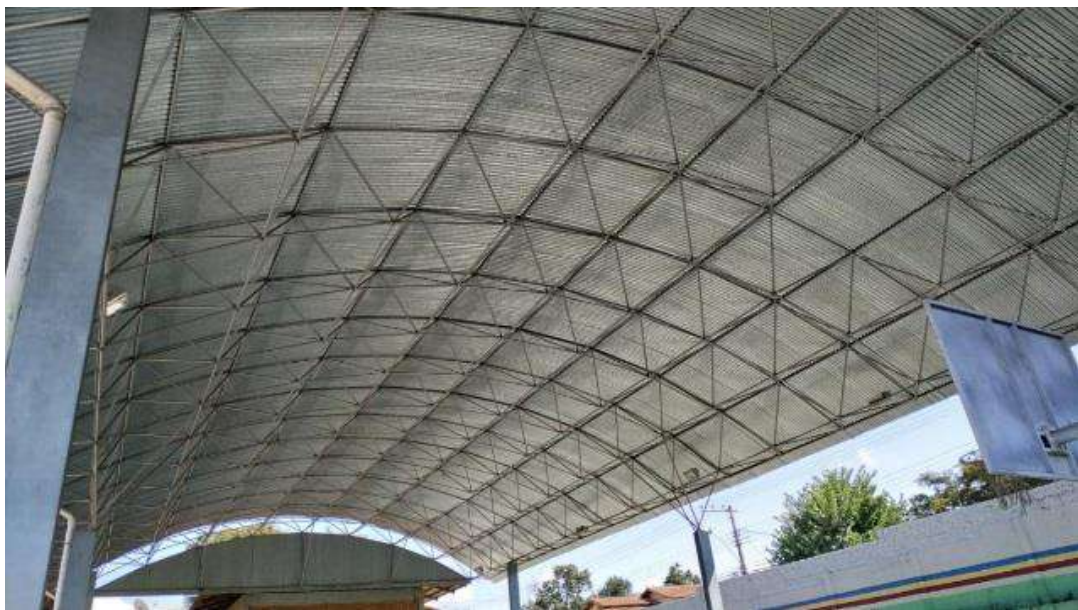
FOTO 21 – CALHAS DA QUADRA POLIESPORTIVA, NECESSITANDO DE REPAROS E INSTALAÇÃO DE REDES DE PROTEÇÃO ANTE PÁSSAROS.
