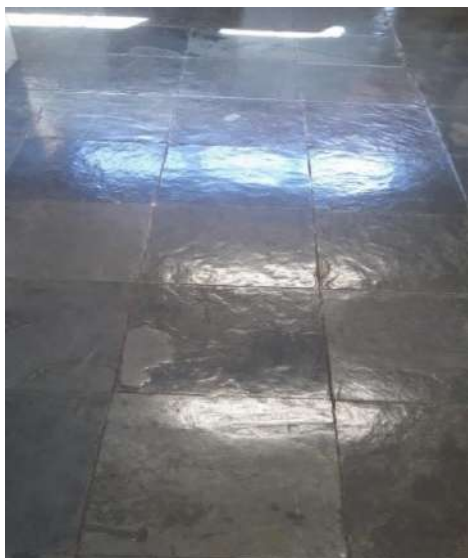
FOTO 20 – PISO EM ADÓSIA EM SALAS DE AULA A SER SUBSTITUÍDO.
