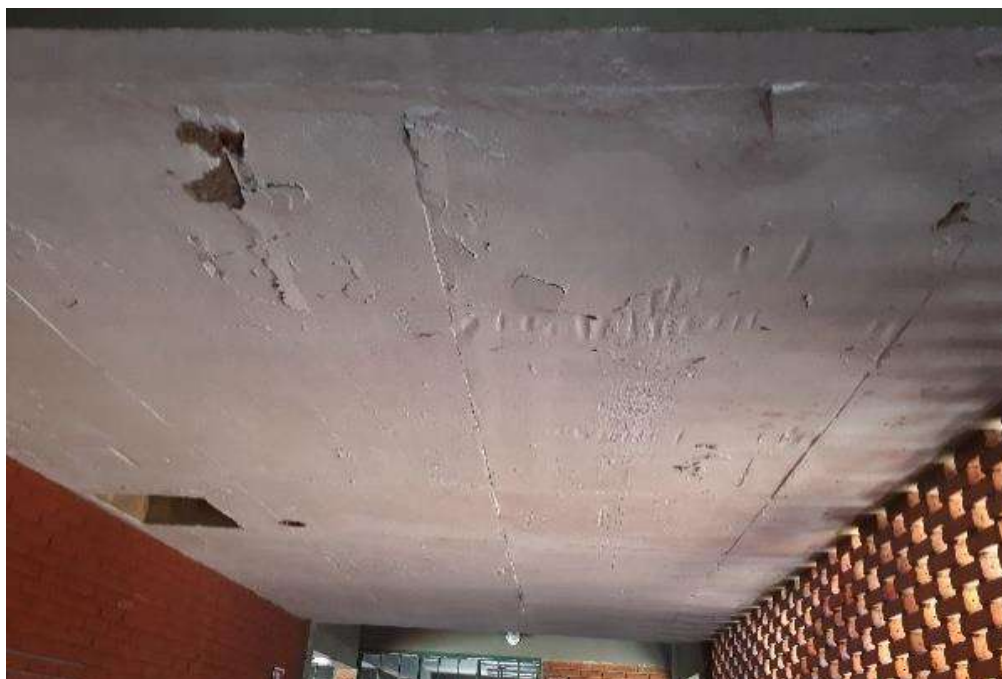
FOTO 24 – CIRCULAÇÃO DO 2º PAVTO NECESSITANDO DE REPAROS NA LAJE DA CAIXA
