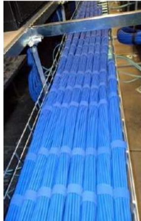
Figura 05: Acomodação de cabeamento em Eletrocalha/Perfilado
