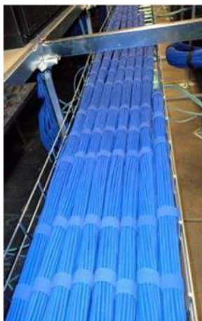
Figura 04: Acomodação de cabeamento em Eletrocalha/Perfilado
