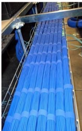
Figura 04: Acomodação de cabeamento em Eletrocalha/Perfilado
