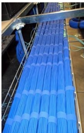
Figura 04: Acomodação de cabeamento em Eletrocalha/Perfilado
