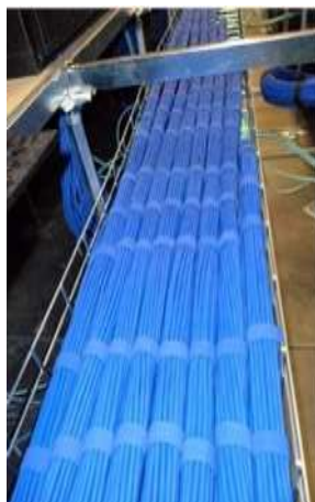
Figura 04: Acomodação de cabeamento em Eletrocalha/Perfilado
