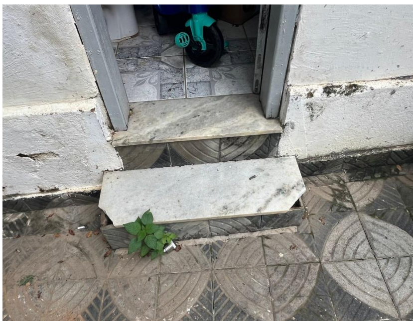
Figura 11: Banheiro da Área Externa (Mármore quebrado)
