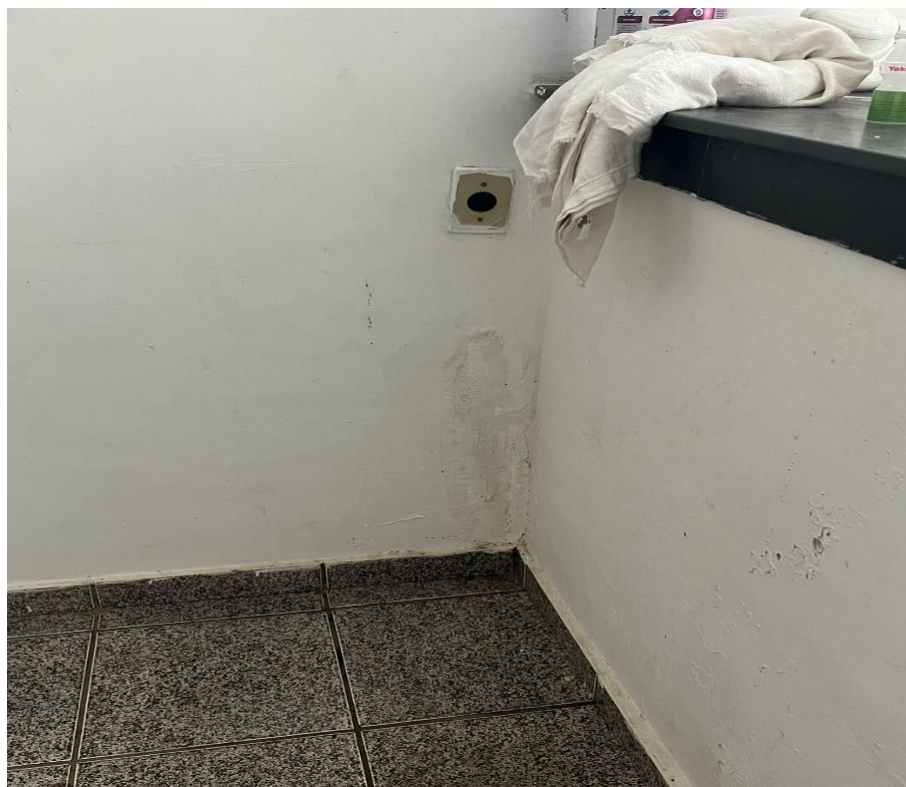
Figura 45: Sala de Jantar (parede com marcas de infiltração)
