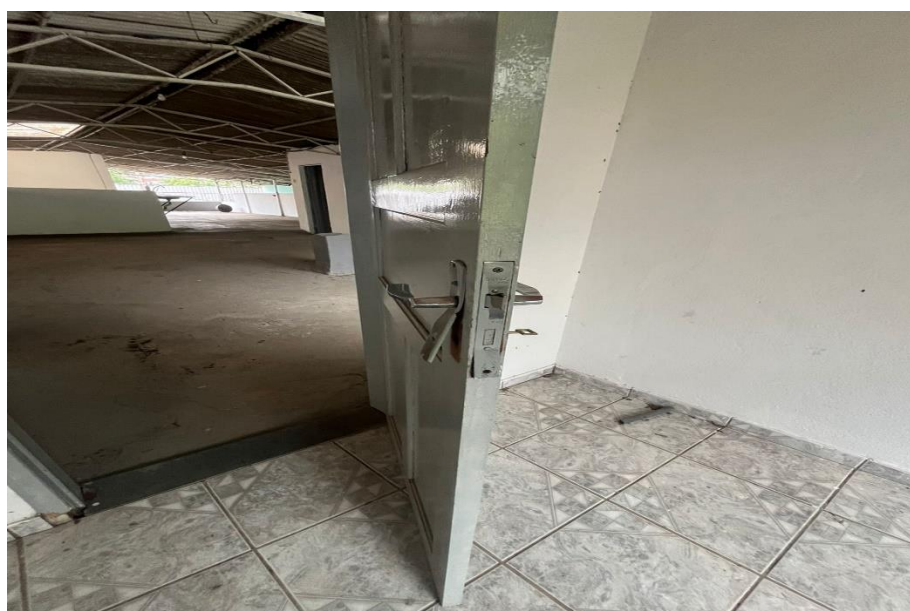
Figura 63: Quarto 5 (fechadura quebrada)
