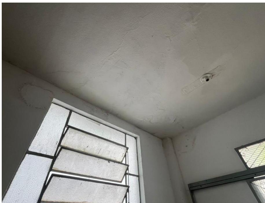
Figura 46: Sala de Jantar (teto com marcas de infiltração)
