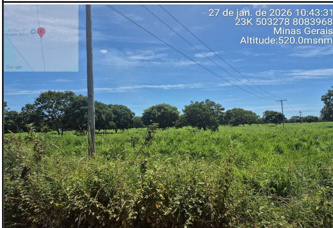
FT.18 - LOCAL 01 - PONTO DE ESTRUTURA ENERGÉTICA DA CONCESSIONÁRIA.
