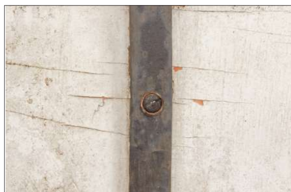
Foto: 0572 Detalhe do estado de conservação atual, com as degradações e patologias verificadas em análise.
