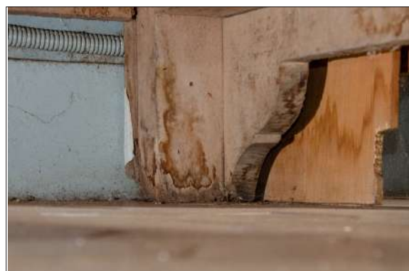
Foto: 0224 Detalhe do estado de conservação atual, com as degradações e patologias verificadas em análise.
