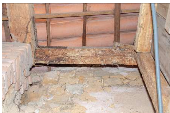
Foto: 0347 Detalhe do estado de conservação atual, com as degradações e patologias verificadas em análise.
