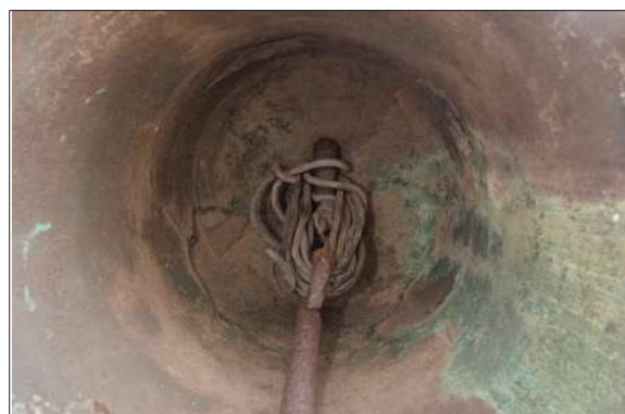
Foto: 0580 Detalhe do estado de conservação atual, com as degradações e patologias verificadas em análise.
