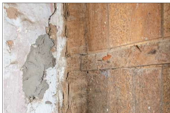
Foto: 0350 Detalhe do estado de conservação atual, com as degradações e patologias verificadas em análise.
