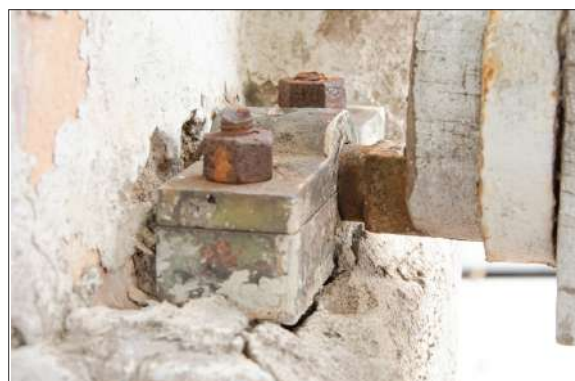
Foto: 0574 Detalhe do estado de conservação atual, com as degradações e patologias verificadas em análise.
