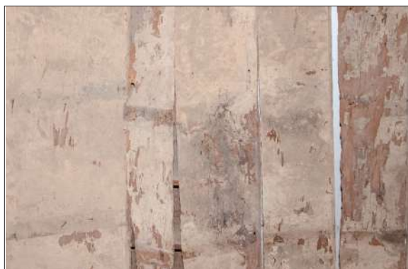
Foto: 0345 Detalhe do estado de conservação atual, com as degradações e patologias verificadas em análise.
