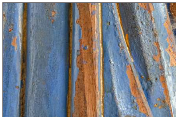
Foto: 0032 Detalhe do estado de conservação atual, com as degradações e patologias verificadas em análise.
