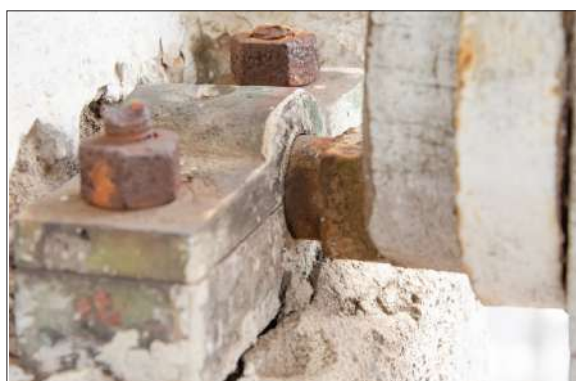
Foto: 0577 Detalhe do estado de conservação atual, com as degradações e patologias verificadas em análise.
