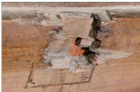
Foto: 0219 Detalhe do estado de conservação atual, com as degradações e patologias verificadas em análise.
