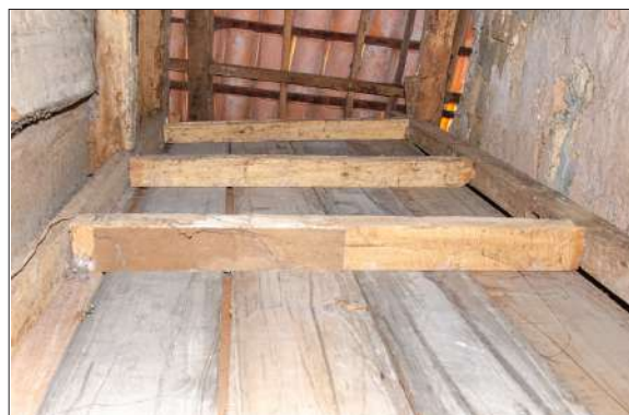
Foto: 0346 Detalhe do estado de conservação atual, com as degradações e patologias verificadas em análise.
