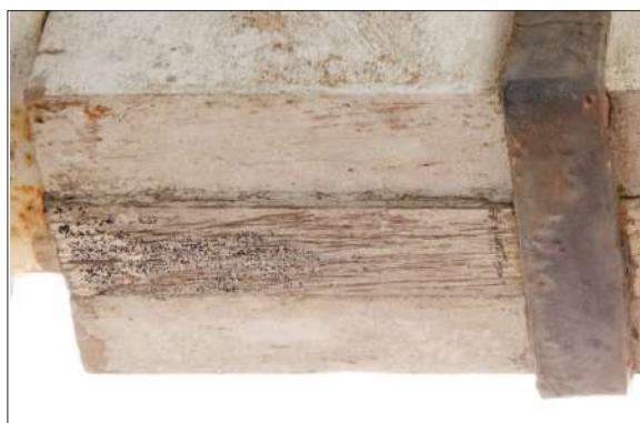
Foto: 0579 Detalhe do estado de conservação atual, com as degradações e patologias verificadas em análise.
