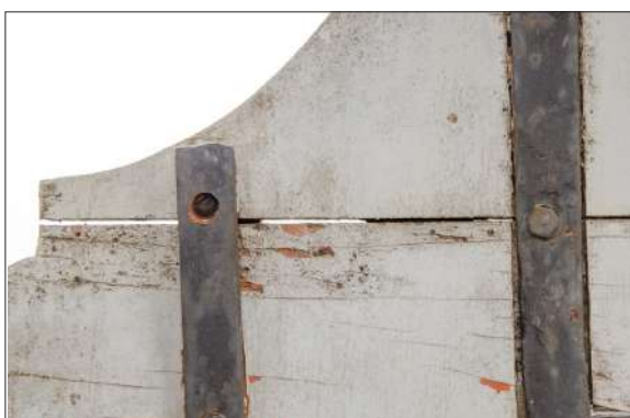
Foto: 0571 Detalhe do estado de conservação atual, com as degradações e patologias verificadas em análise.
