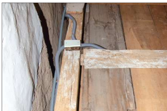
Foto: 0349 Detalhe do estado de conservação atual, com as degradações e patologias verificadas em análise.
