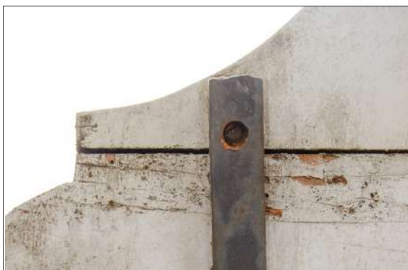
Foto: 0569 Detalhe do estado de conservação atual, com as degradações e patologias verificadas em análise.
