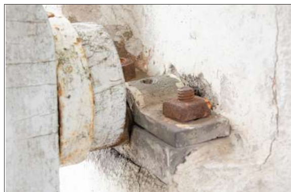
Foto: 0576 Detalhe do estado de conservação atual, com as degradações e patologias verificadas em análise.
