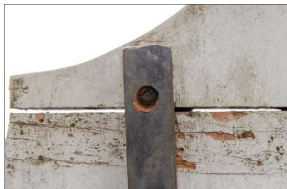
Foto: 0570 Detalhe do estado de conservação atual, com as degradações e patologias verificadas em análise.
