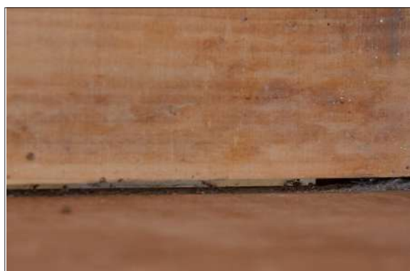
Foto: 0221 Detalhe do estado de conservação atual, com as degradações e patologias verificadas em análise.
