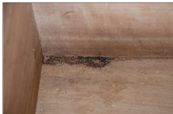
Foto: 0220 Detalhe do estado de conservação atual, com as degradações e patologias verificadas em análise.
