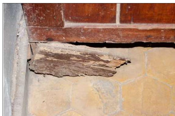
Foto: 0222 Detalhe do estado de conservação atual, com as degradações e patologias verificadas em análise.
