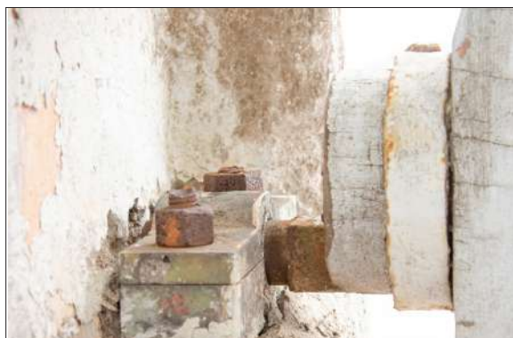
Foto: 0575 Detalhe do estado de conservação atual, com as degradações e patologias verificadas em análise.
