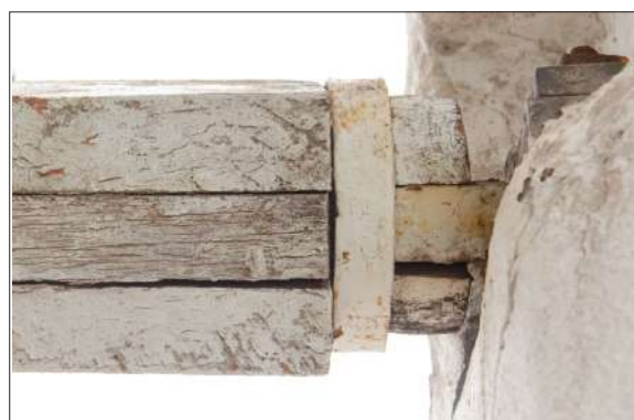
Foto: 0578 Detalhe do estado de conservação atual, com as degradações e patologias verificadas em análise.
