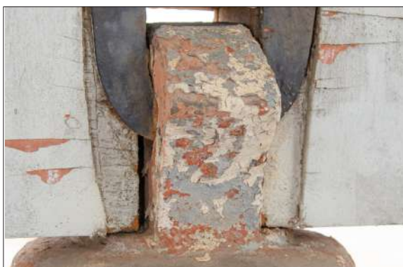
Foto: 0573 Detalhe do estado de conservação atual, com as degradações e patologias verificadas em análise.
