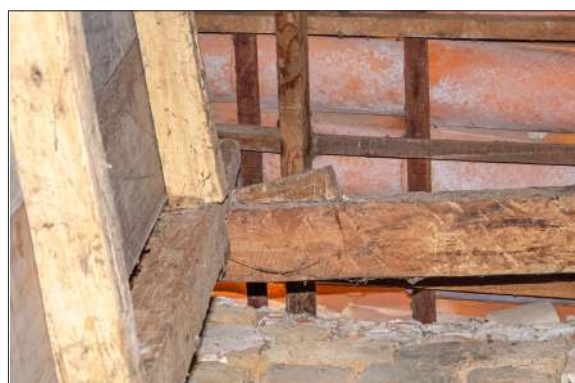
Foto: 0348 Detalhe do estado de conservação atual, com as degradações e patologias verificadas em análise.
