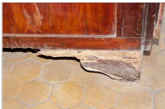
Foto: 0223 Detalhe do estado de conservação atual, com as degradações e patologias verificadas em análise.
