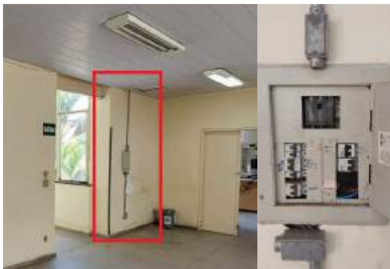
Foto 28 - Situação atual do quadro elétrico QBT-01
