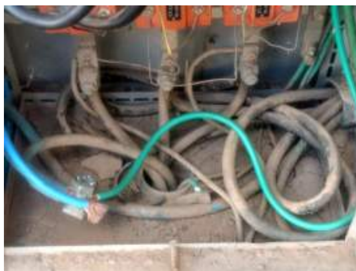
Figura 4 – Disjuntor Geral – Lama da enchente
