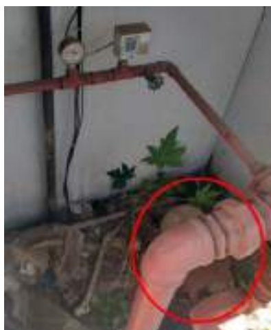
Foto 06: Detalhe bomba de PCI.
