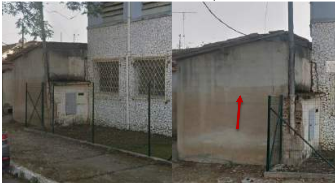
Foto 03 e 04 – Marcas da última enchente no local do Padrão de Entrada de Energia
