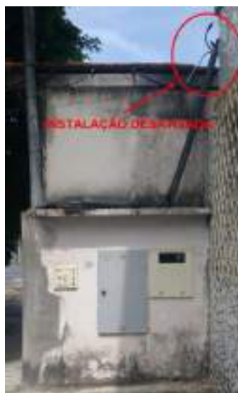
Foto 01: Padrão de entrada existente, a ser removido.
