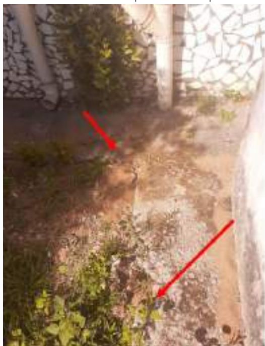
Foto 19 - Áreas danificadas no piso de concreto próximo ao local de instalação do GMG – CSSI | UAGC
