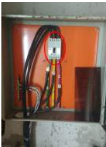
Foto 02: Disjuntor geral de 160A, do QGBT.
