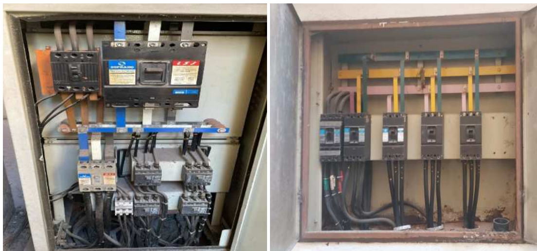
Foto 15 e 16 – Quadro existente 1 e quadro existente 2
