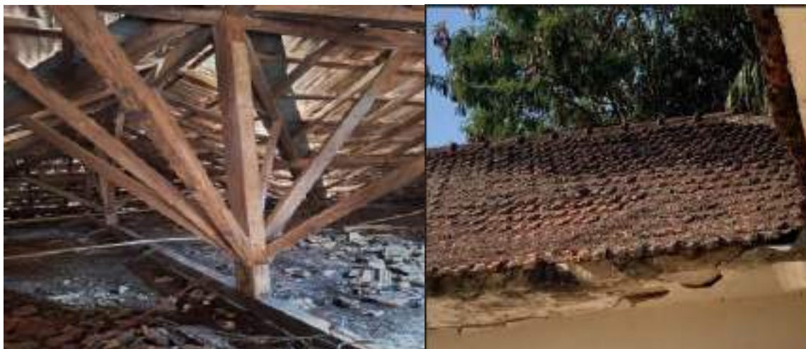
Fotos 12 e 13 – Telhas sem encaixe satisfatório
