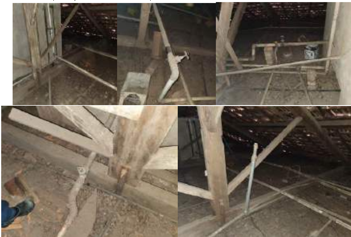
Fotos 46 a 50 – REF | Instalações Hidráulicas a serem adequadas
