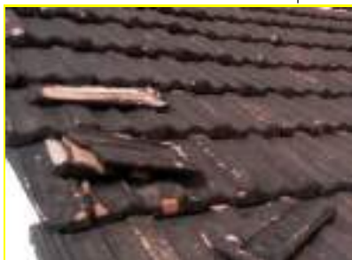
Fotos 04 e 05 – Detalhe telhas acometidas por lodo
