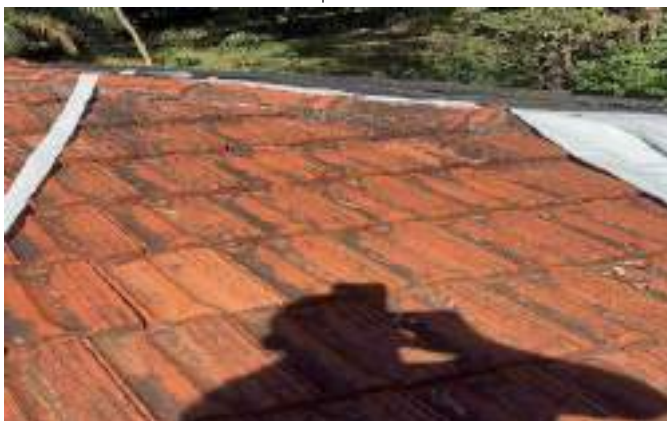
Fotos 06 e 07 – Detalhe telhas acometidas por lodo
