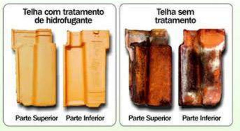
Figura 33 – Telha hidro fugada x sem tratamento
