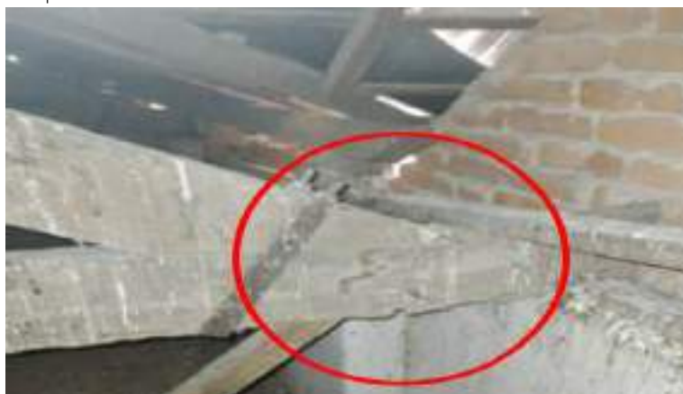
Foto 14 – Falha no sistema de apoio das tesouras
