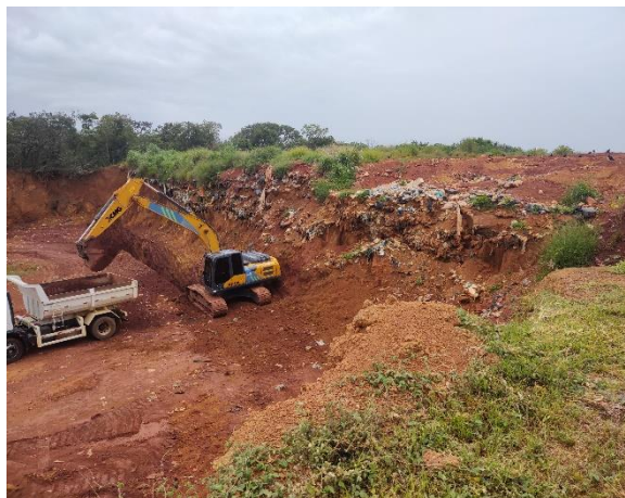
Figura 34 – Abertura de Vala de Rejeitos em Presidente Olegário.
