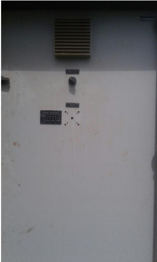
Foto 31: Frontal painel modulo de Automação do Rio das Cinzas.
