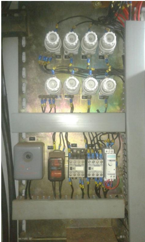
Foto 1: PAINEL controle de nível do
