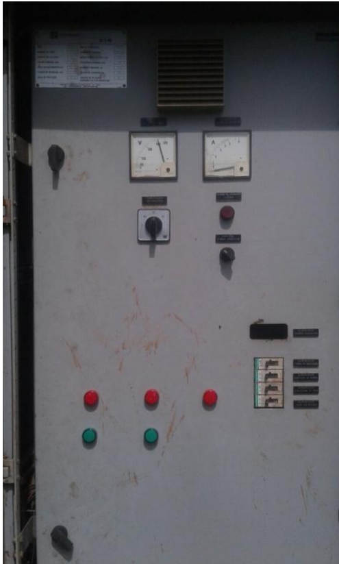
Foto 29: Frontal painel de acionamento Bombas dreno e controle de nível.
