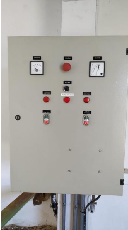
Foto 21 – Frente Painel acionamento bombas
