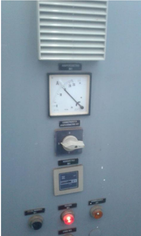
Foto 11: Frontal painel acionamento Bomba 2 chorinho.
