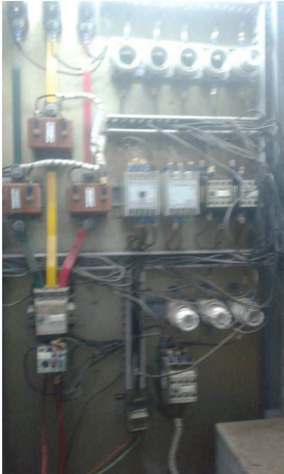
Foto 12: Pannel acionamento bomba 2 Chorinho.
