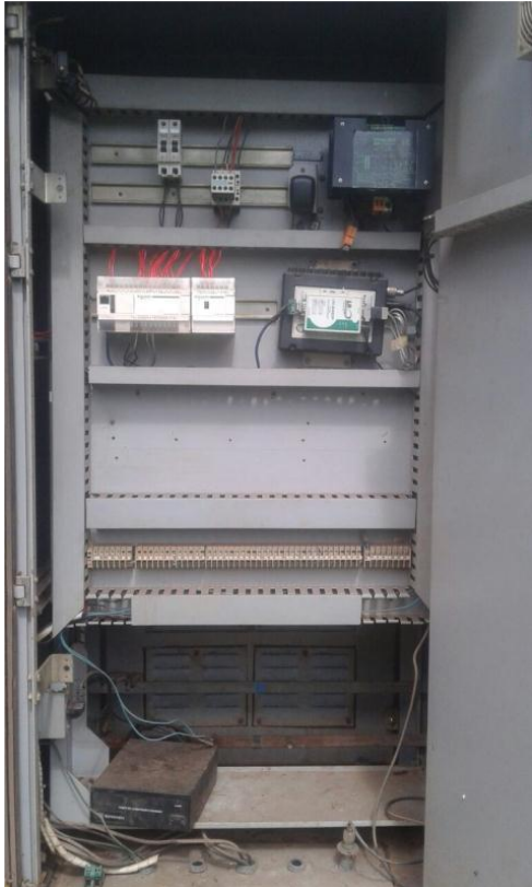
Foto 32: Painel de acionamento e Controle eletrônico das bombas Rio Das Cinzas.
