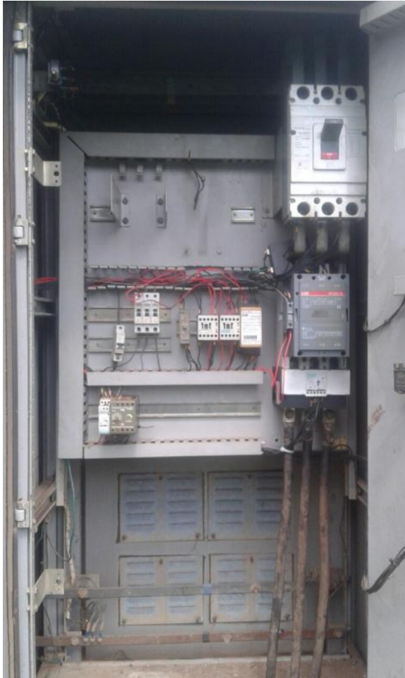
Foto 36: Painel de acionamento Bomba 2 Rio das Cinzas
