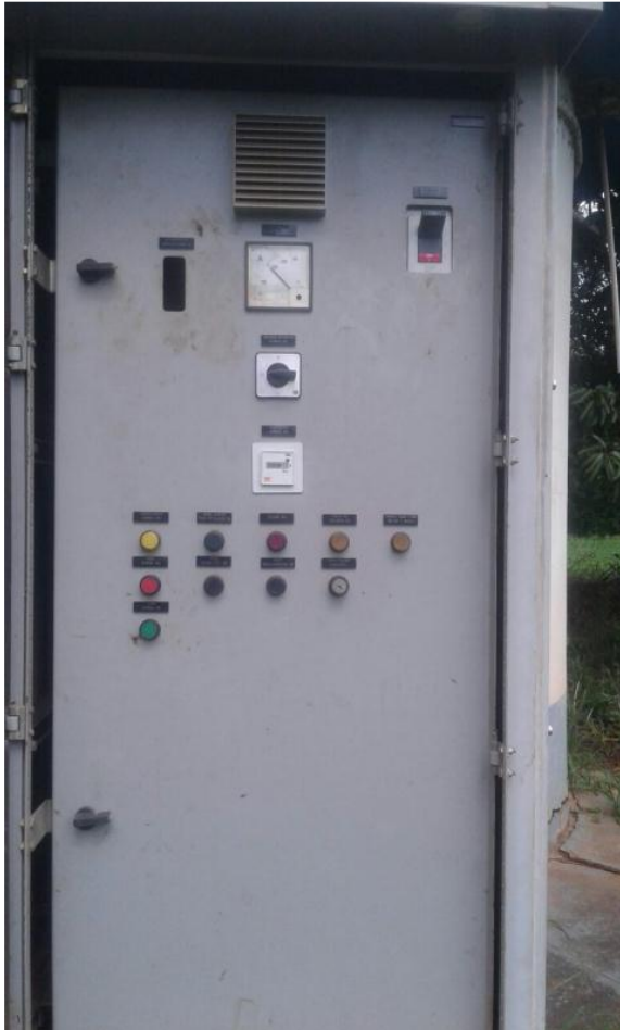
Foto 35: Frontal painel bomba 2 Rio das Cinzas
