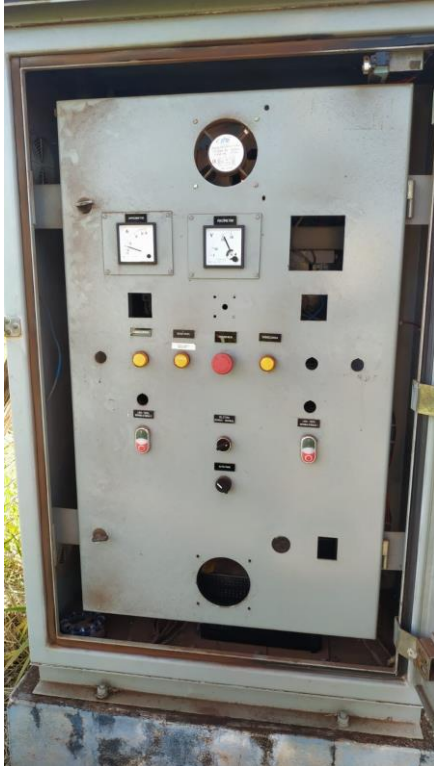
Foto 23 – Frente Painel acionamento Bombas booster
