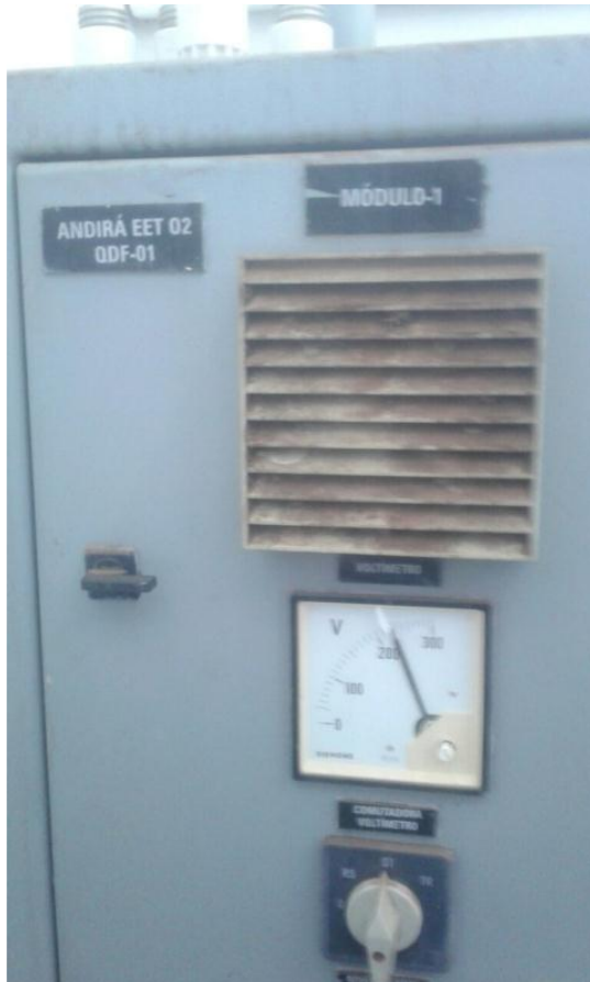
Foto 7: Frontal Painel bombas 1 e 2 Chorinho.
