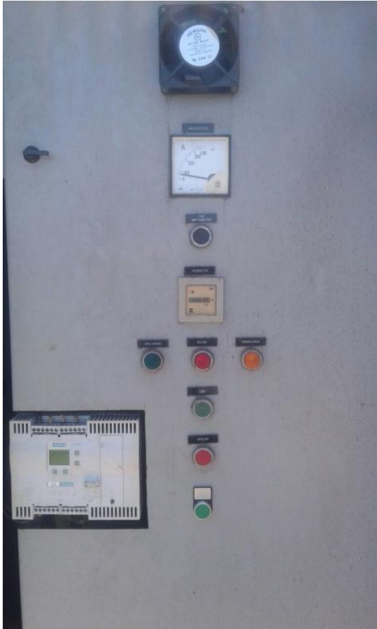
Foto 15: Frontal painel acionamento Bomba poço Rua Ivaí.
