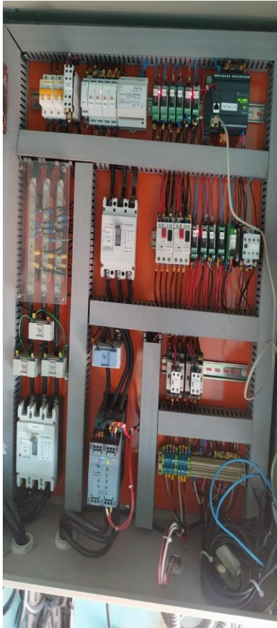
Foto 20 – Interno Painel Bombas
