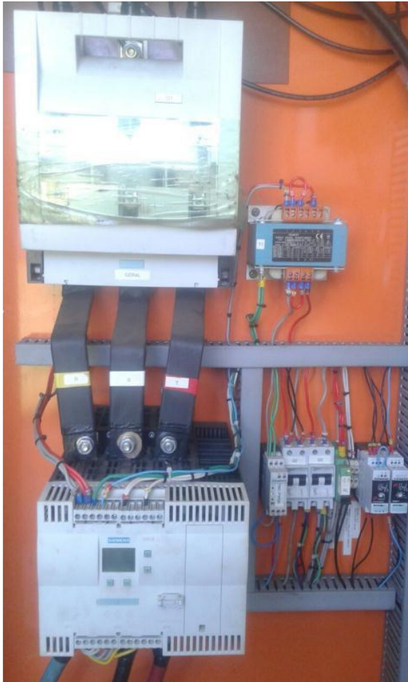
Foto 18: Pannel acionamento bomba Poço Major.
