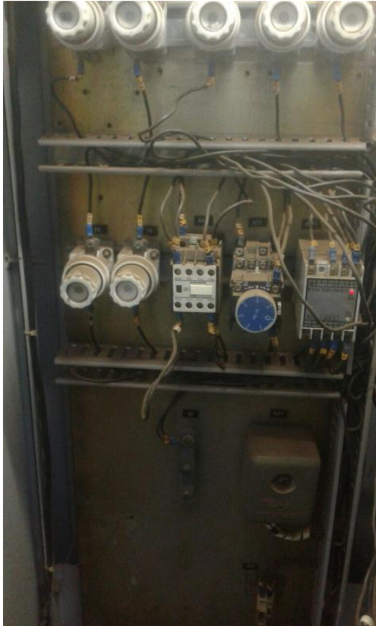
Foto 8: Painel comando bombas 1 e 2 Chorinho.
