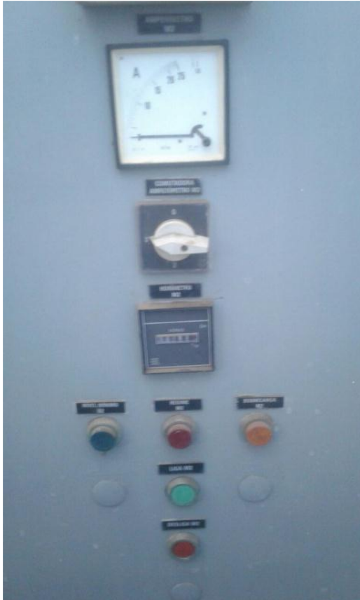
Foto 9: Frontal Painel acionamento Bomba 1 chorinho.
