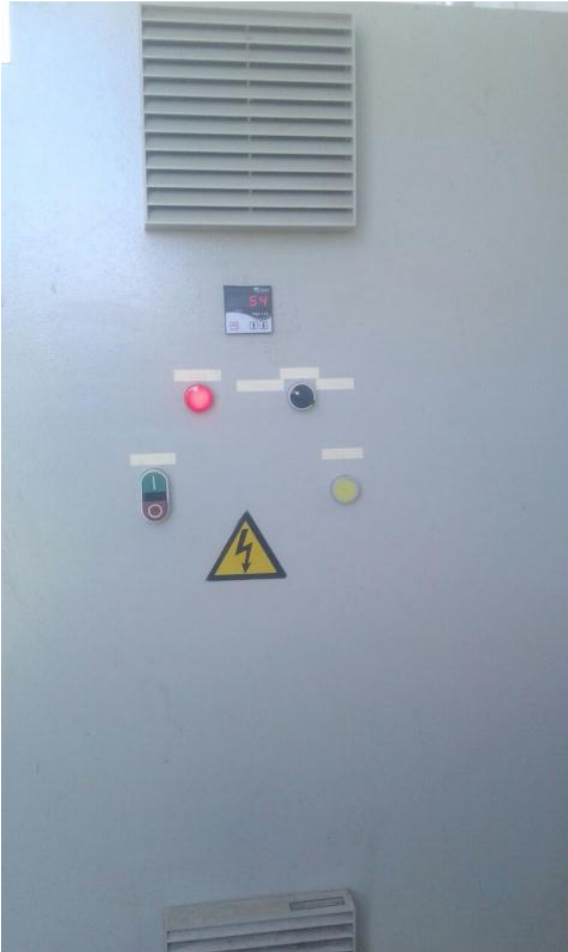
Foto 17: Frontal painel de acionamento Bomba poço Major.
