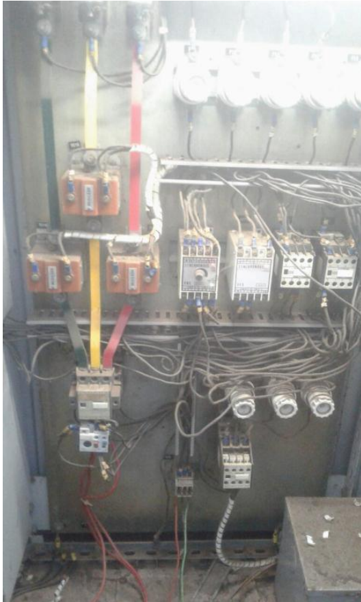
Foto 10: Painele acionamento bomba 1 Chorinho.
