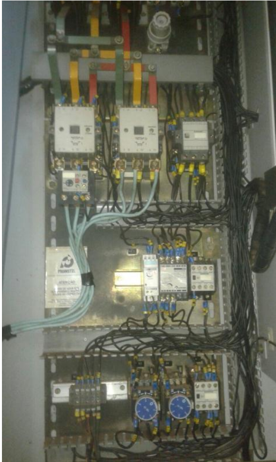
Foto 3: PAINEL ACIONAMENTO BOMBA 2 Do elevado (caixa d'água)
