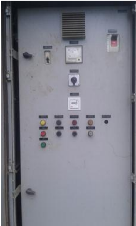
Foto 33: Frontal painel bombas 1 Rio das Cinzas.
