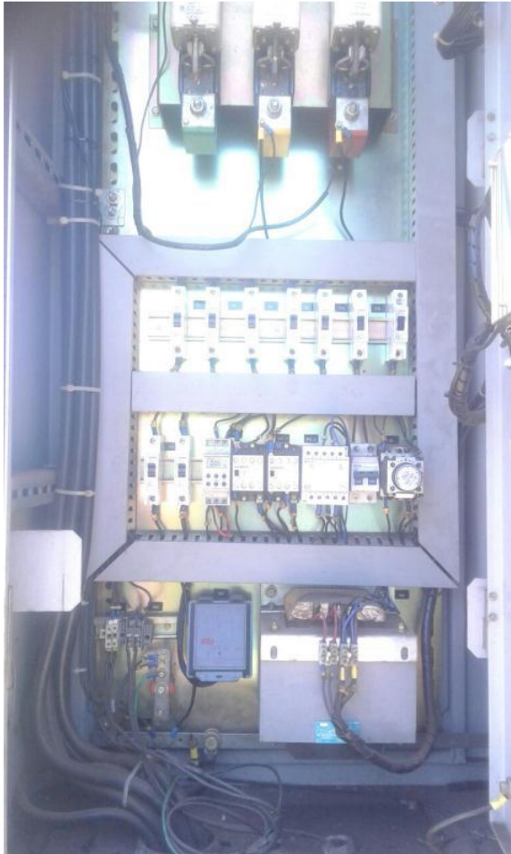
Foto 14: PAINEL DE CONTROLE AUTOMÁTICO Bomba poço rua Ivaí.
