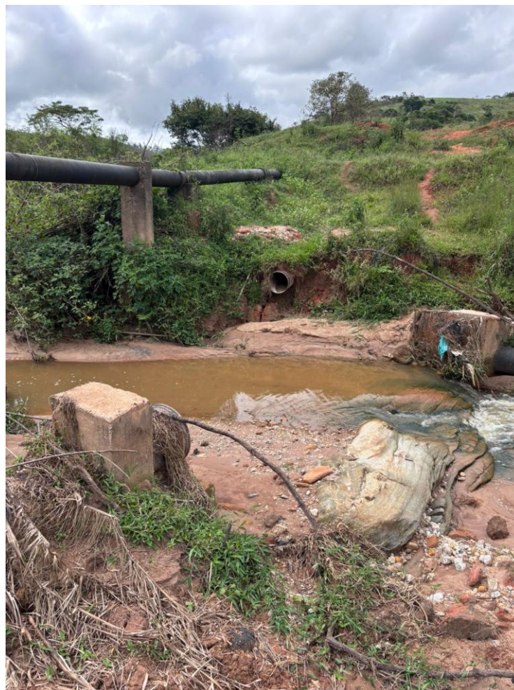
Fotografia 3 - ADUTORA 400MM ROMPIDA, LATITUDE -19.576793°, LONGITUDE -43.192969°.
