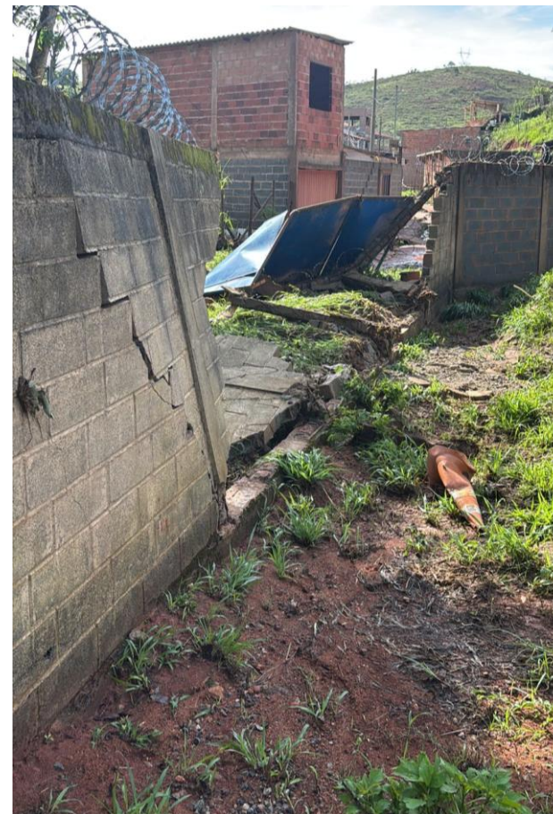
Fotografia 2 - MURO ETA GATOS COLAPSADO LATITUDE -19.584697°, LONGITUDE -43.194373°.
