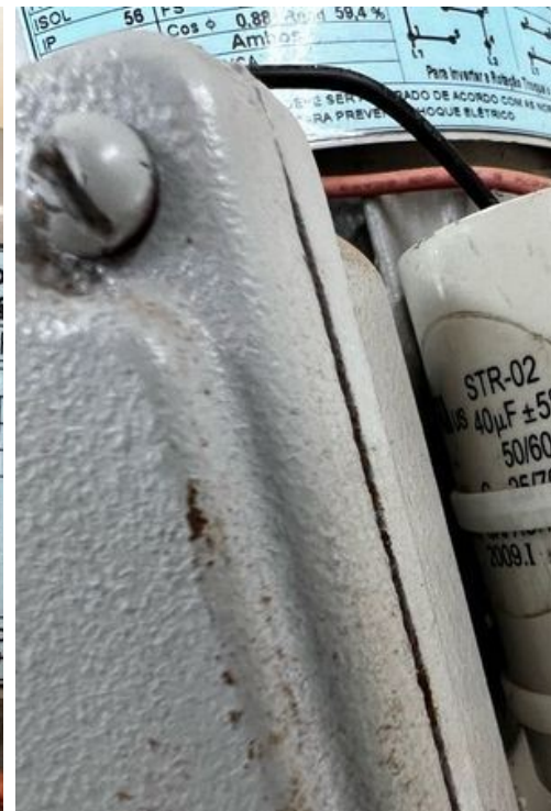
Vista do capacitor.
