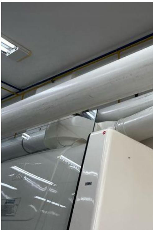
Vista dos dutos.
