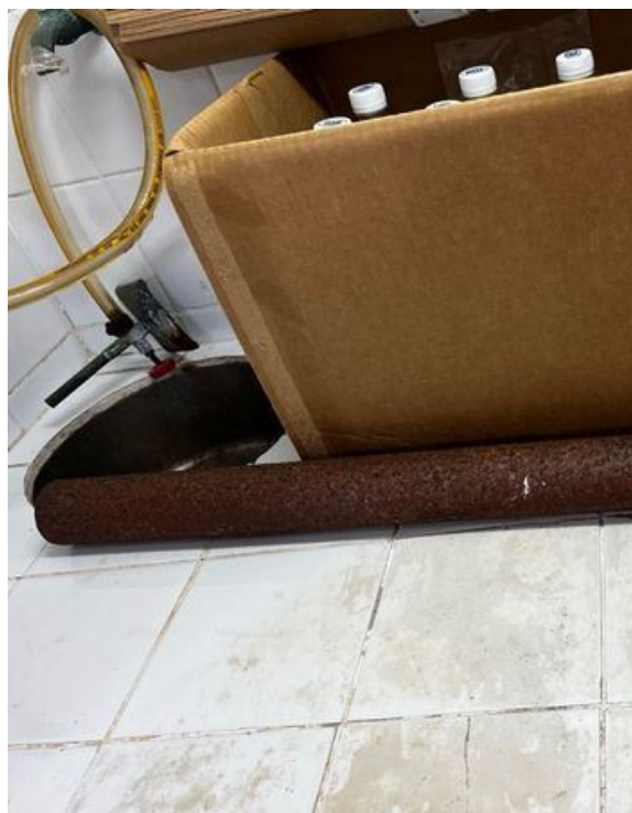
Vista do contrapeso que está dentro do equipamento.
