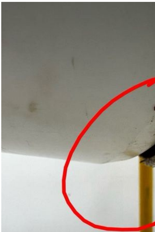
Vazamento de ar para o ambiente externo.
