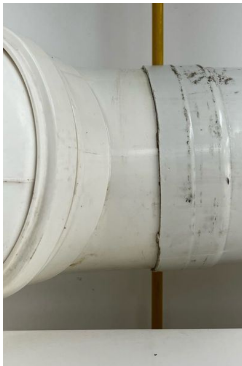
Correção na fixação do duto.
