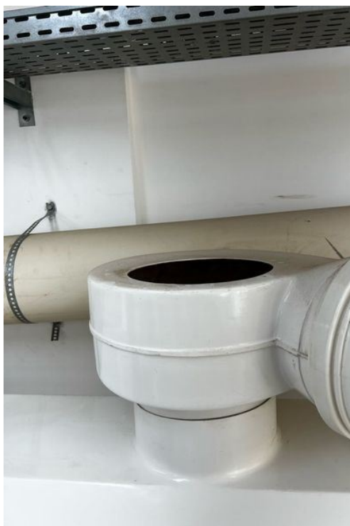
Equipamento estava sem o motor.
