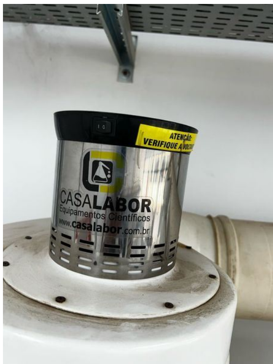
Vista do motor danificado.
