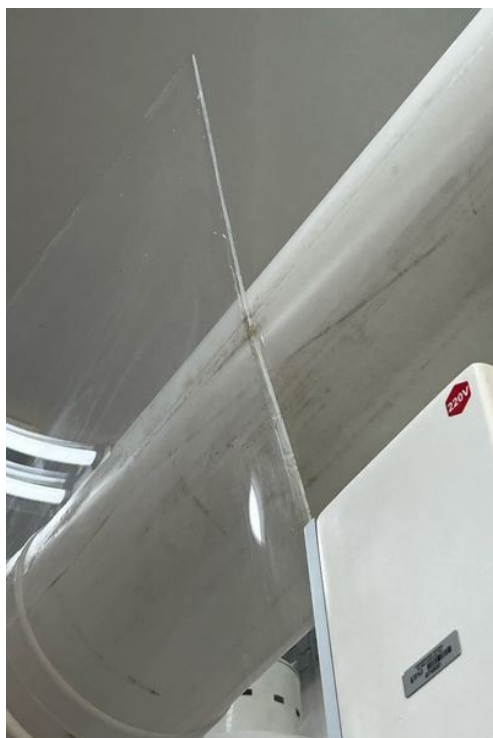
Tampa de acrílico encostando no duto.
