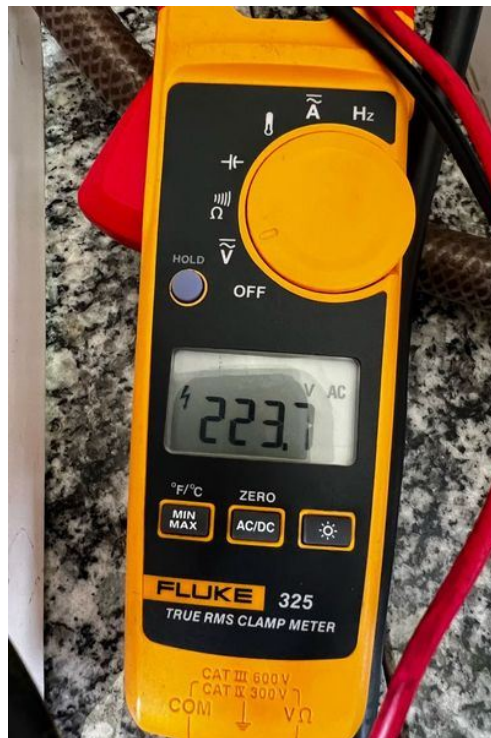
Tensão elétrica de alimentação.
