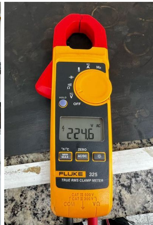
Tensão elétrica de alimentação.
