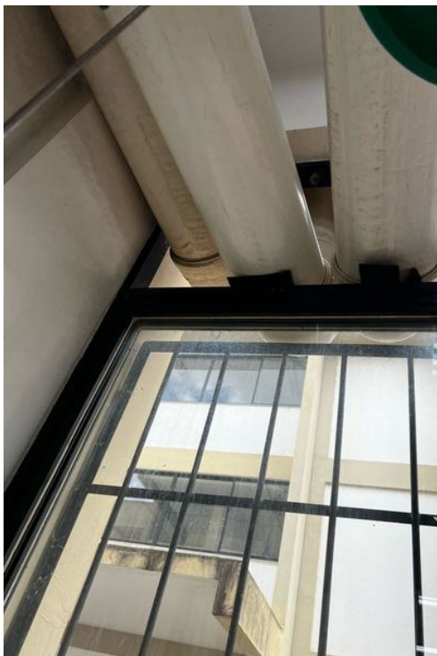
Vista dos dutos.
