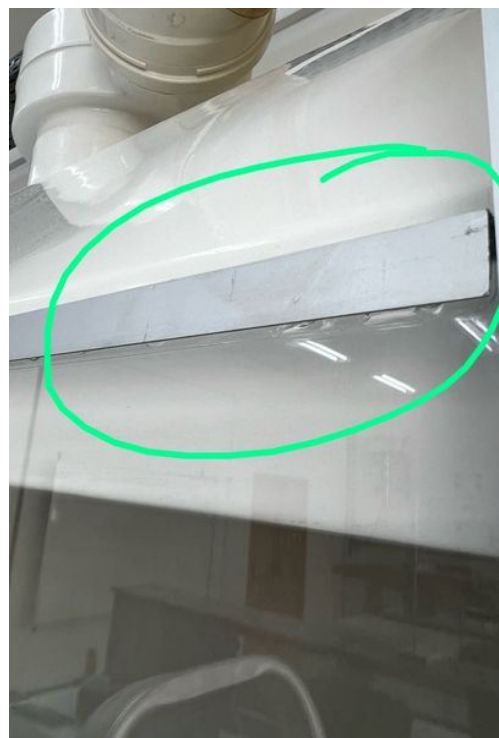
Correção na fixação do batente da tampa de acrílico.
