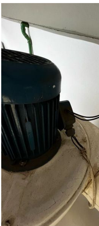
Motor estava sem capacitor.
