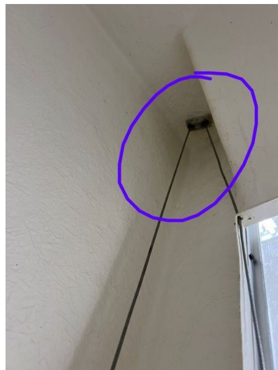
Rolamento do contrapeso está travado.
