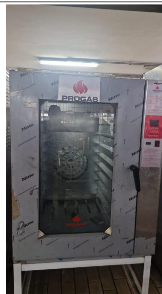
Foto 6 – Forno a ser Instalado Rancho Cmdo 4ªRM
