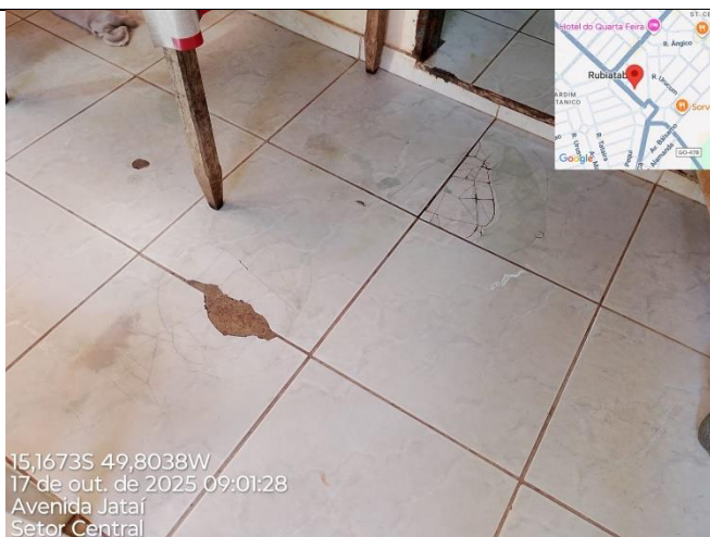
Figura 5- Piso da Cozinha a ser substituído, inclusive será executado novo contrapiso
