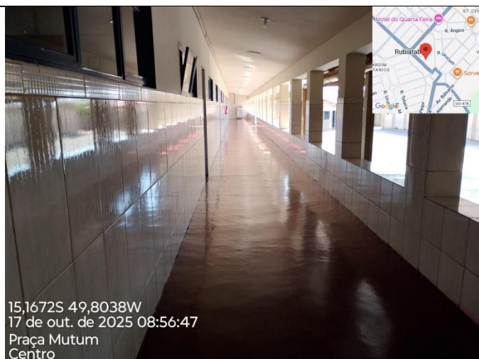
Figura 6 - Piso do Corredor de Circulação a ser substituído por piso cerâmico, inclusive será refeito o contrapiso
