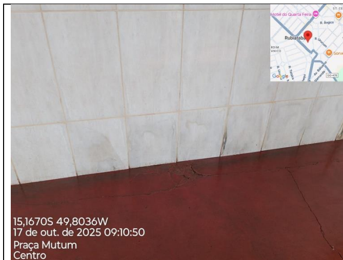
Figura 3 - Piso do Corredor de Circulação a ser substituído por piso cerâmico, inclusive será refeito o contrapiso
