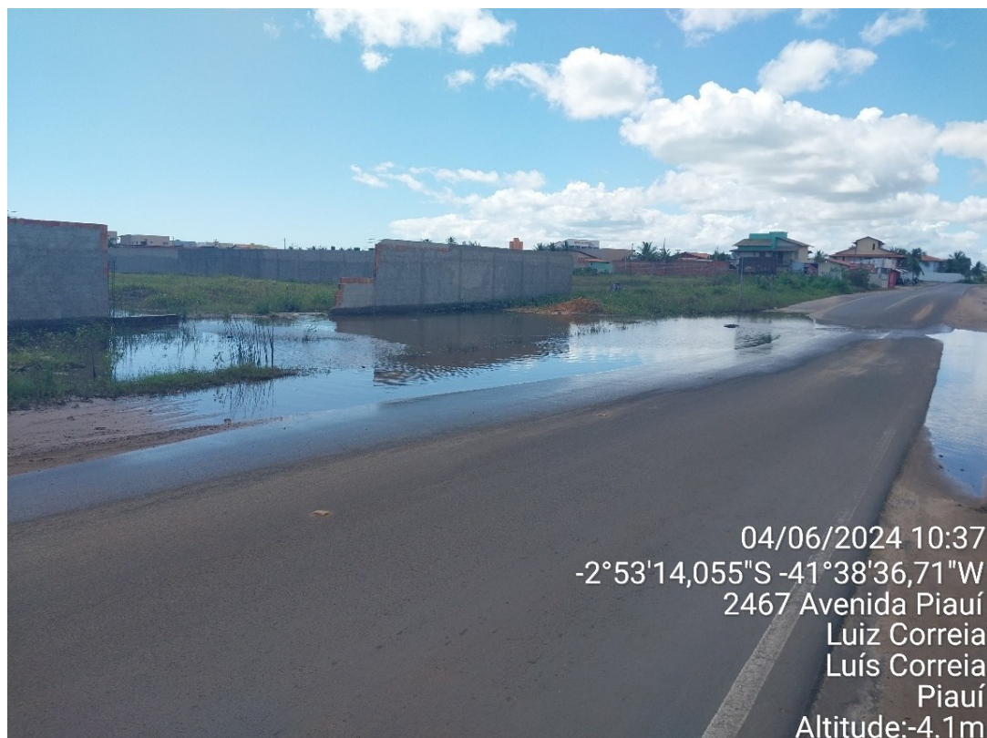
Figura 2 – Trecho alagado em Luís Correia - PI. (Fonte: ISBPI)
