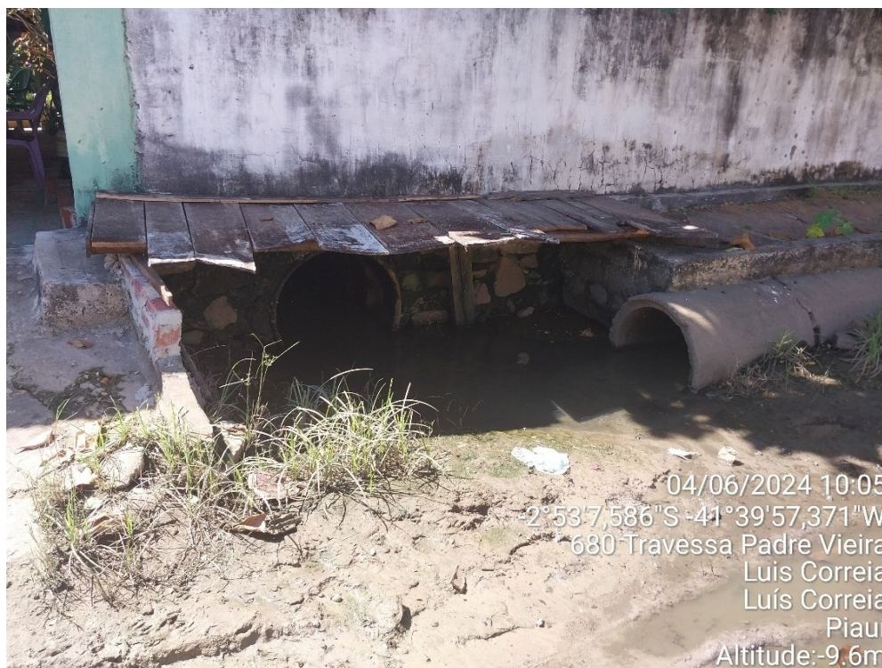
Figura 4 – Infraestrutura de drenagem urbana comprometida. (Fonte: ISBPI)
