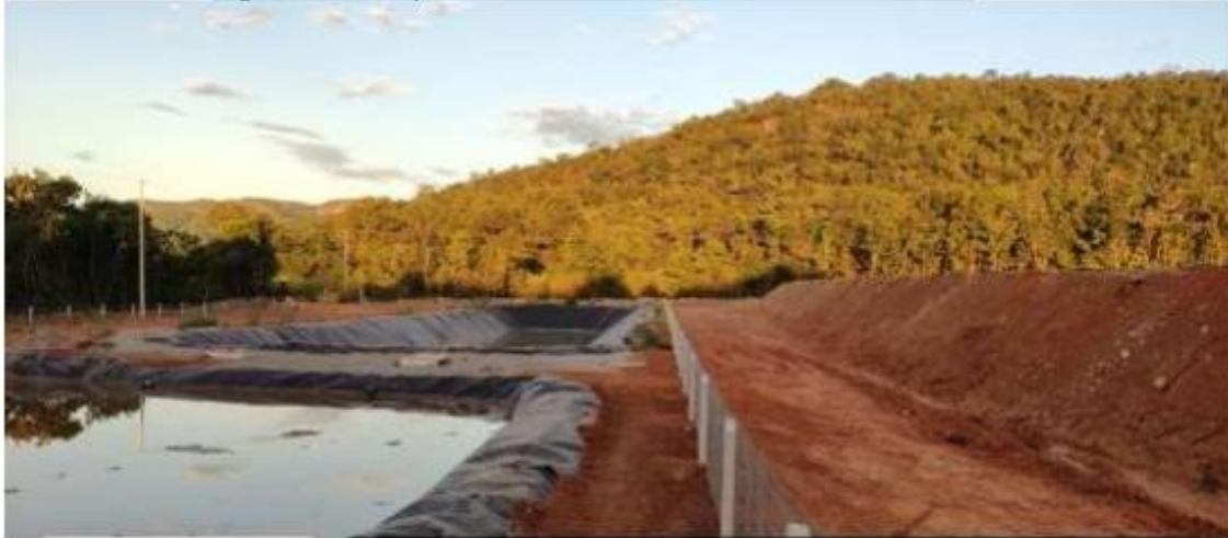
Figura 5 - Vista parcial do sistema de tratamento de chorume
