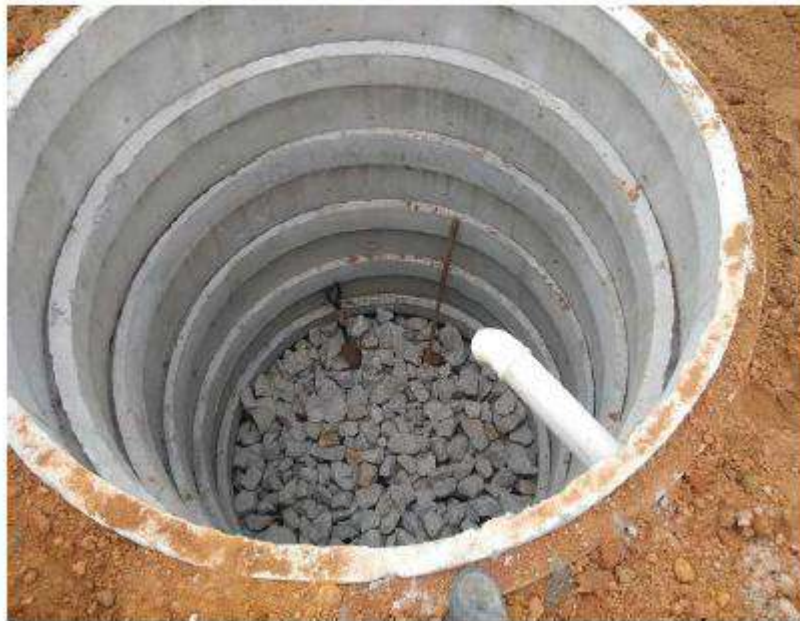
Figura 10 - Sumidouro para destinação final de efluentes tratados.
