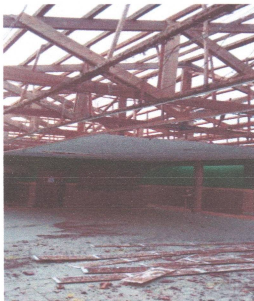
Figura 6: Telhas e partes do forro retirado para evitar desabamento após fortes chuvas ocorridas
