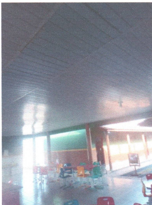
Figura 4: Forro em PVC deformado em função dos danos da estrutura de madeira da cobertura
