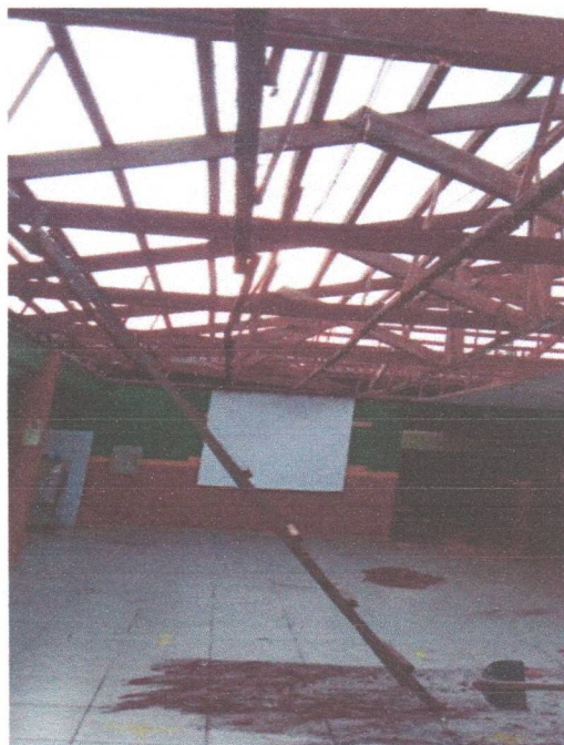
Figura 5: Telhas e partes do forro retirado para evitar desabamento após fortes chuvas ocorridas
