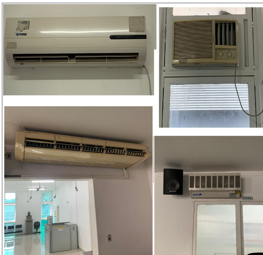
Figura 2 – Exemplo de equipamentos instalados
