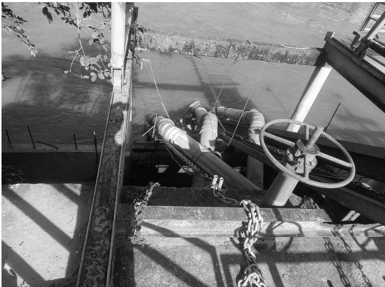
Imagem 2 da estrutura onde se encontra a bomba (submersa) de captação.
