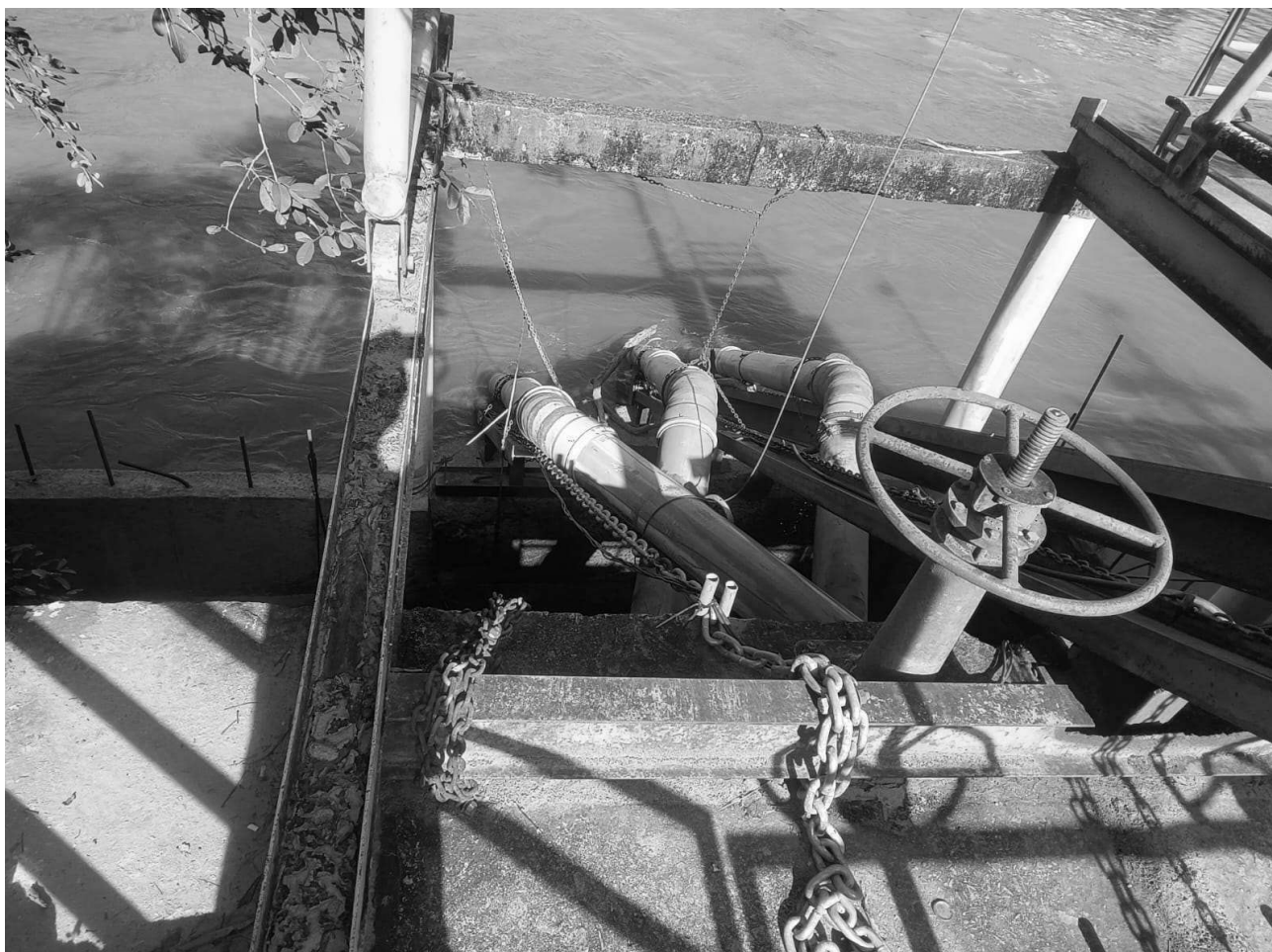
Imagem 1 da estrutura onde se encontra a bomba (submersa) de captação.
