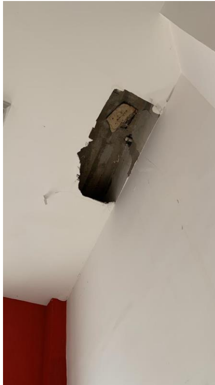
Figura 28: Sala dos fundos - Detalhe do teto danificado
