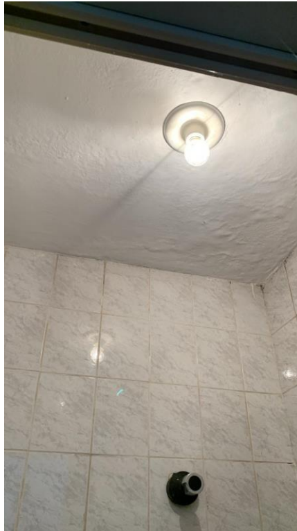
Figura 18: Infiltração no teto do banheiro 01
