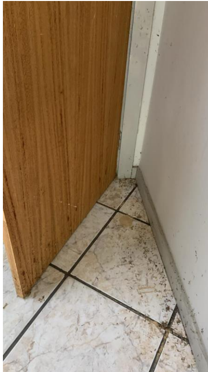
Figura 34: Indícios de infestação de cupim
