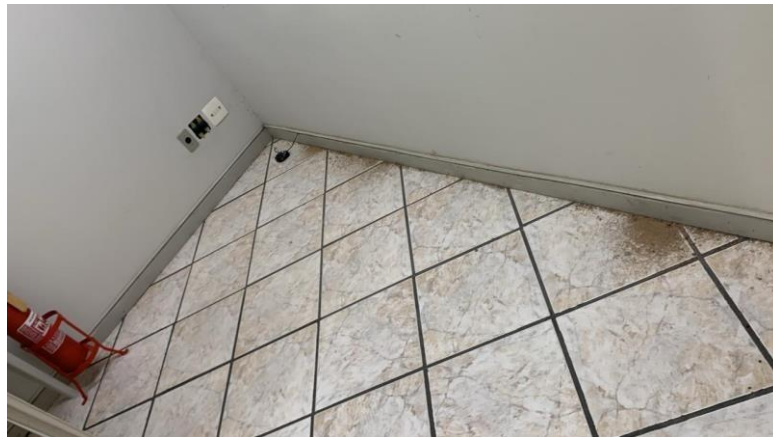
Figura 37: Indícios de infestação de cupim
