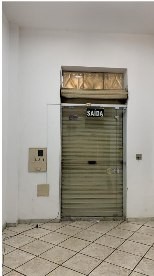
Figura 12: Portão 02 - porta de controle de acesso
