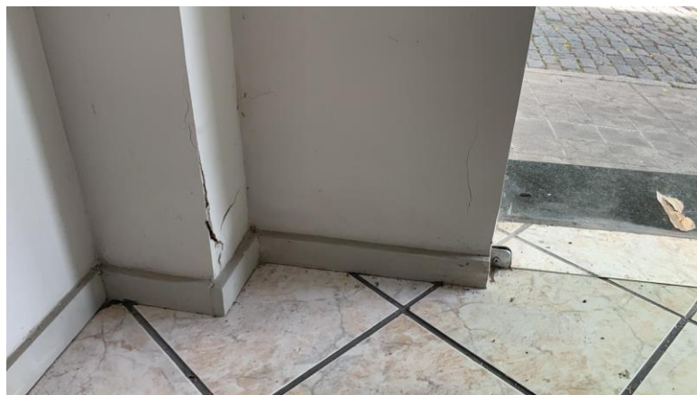
Figura 32: porta de acesso 01 - fissuras no revestimento
