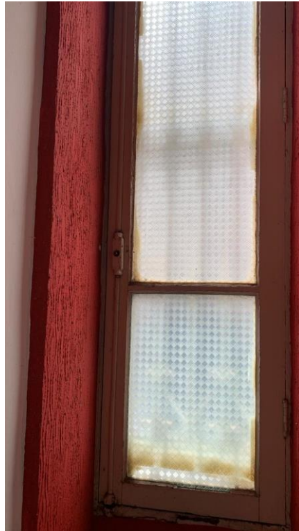
Figura 42: Janelo da sala do fundo - Cremona danificada
