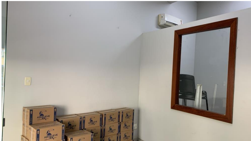
Figura 43: Ar condicionado 02 inoperante
