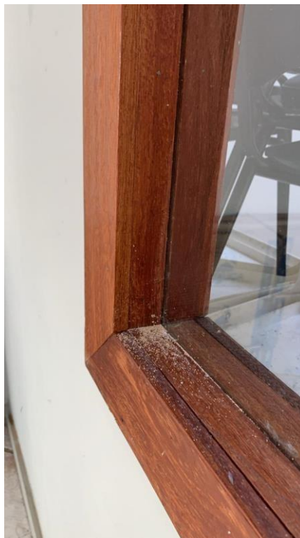
Figura 35: Indícios de infestação de cupim
