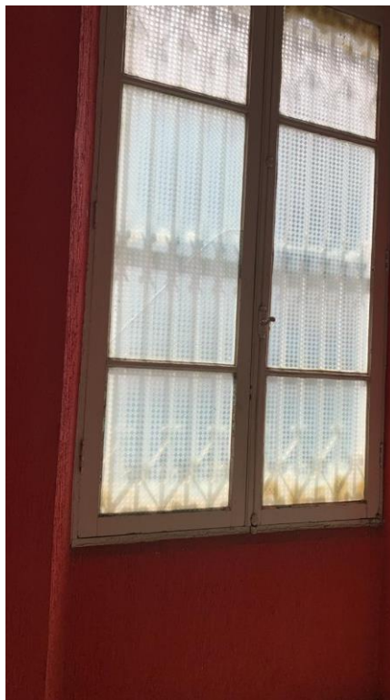
Figura 41: Janelo da sala do fundo - vidro quebrado
