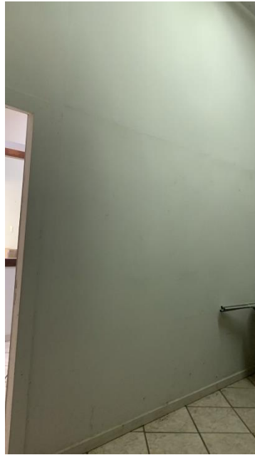
Figura 6: Parede interna com deficiência na pintura
