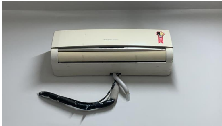
Figura 36: Ar condicionado inoperante
