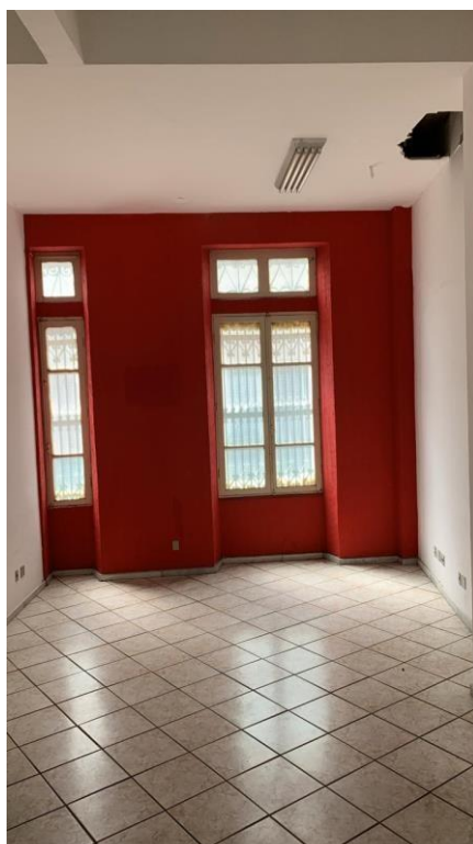
Figura 27: Sala dos fundos com foco em teto danificado
