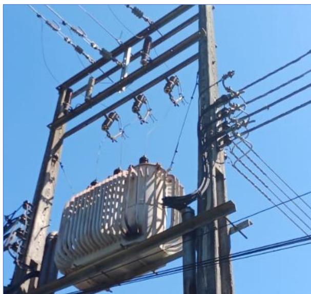
Figura 02: Transformador do CPPI
