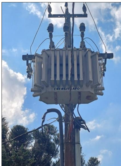
Figura 01: Transformador do HDSPR
