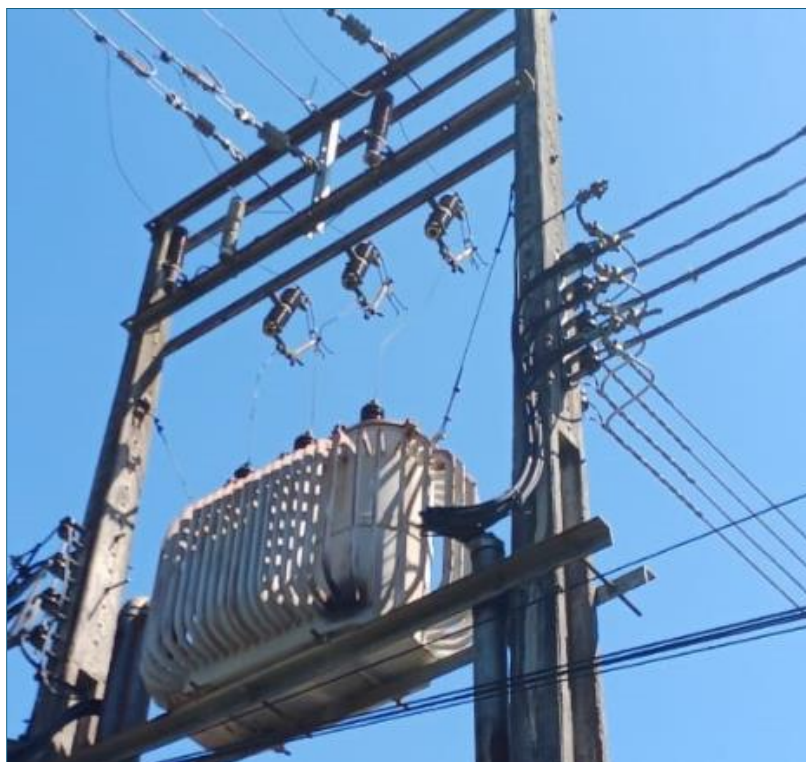
Figura 02: Transformador do CPPI
