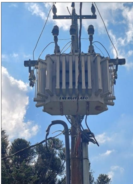
Figura 01: Transformador do HDSPR
