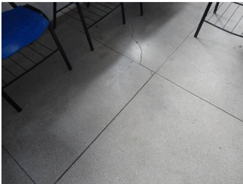
Figura 20: Vista Interna da Sala de Aula – Rachadura Exposta
