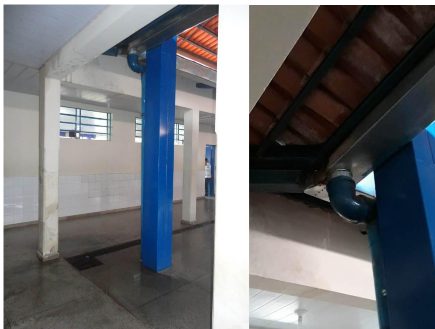
Figura 119 – Vista do sistema de calha no pátio
