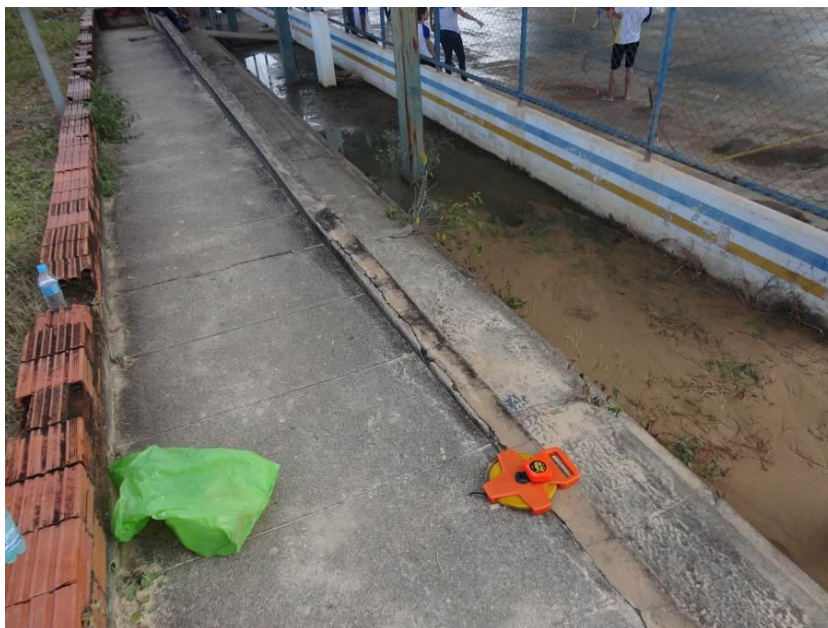
Figura 131 – Vista da Rampa de Acesso a Quadra – Sem Guarda-corpo
