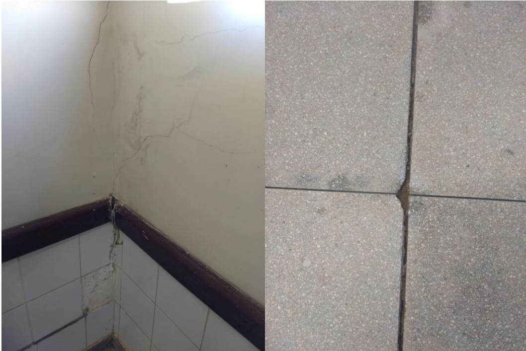
Figura 75 – Vista interna da Sala de Aula – Recalque provoca rachadura no piso
