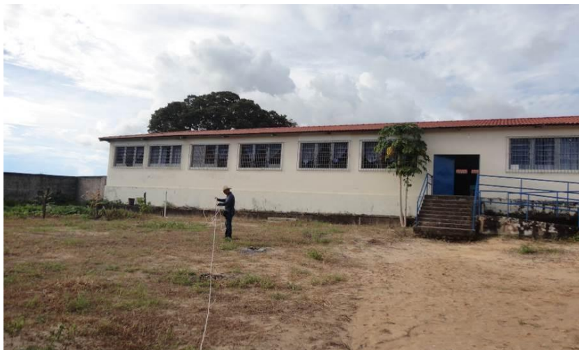
Figura 19: Fachada Longitudinal – Recalque na Base da Edificação
