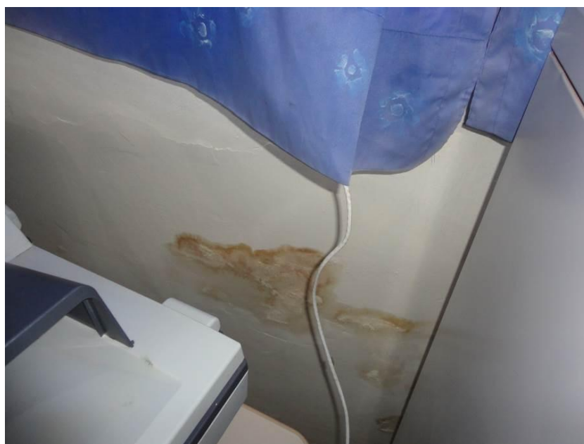
Figura 64 – Vista da Sala Administrativa – Infiltração na Parede
