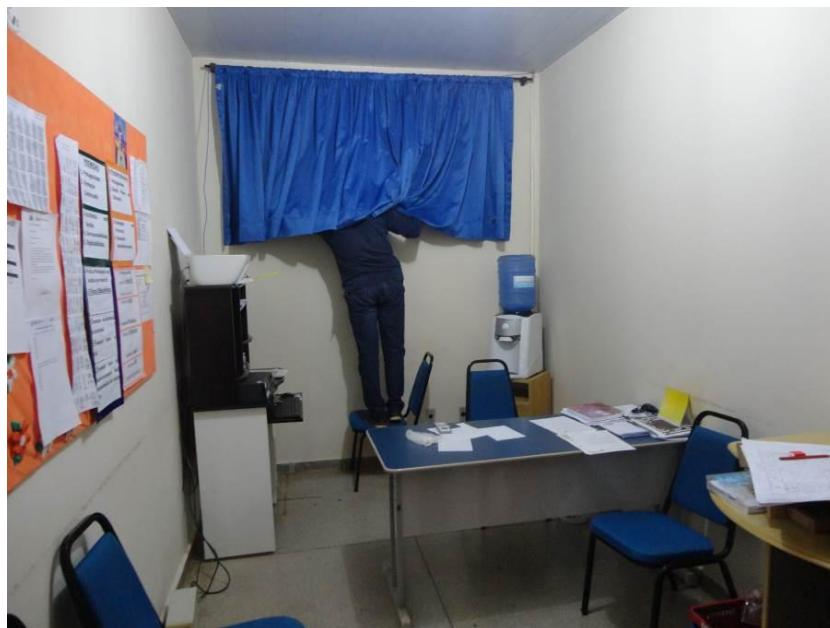
Figura 65 – Diretoria (do projeto) – Diretoria sem ventilação
