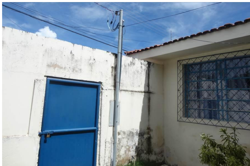
Figura 135 – Foto do Padrão de Eletricidade
