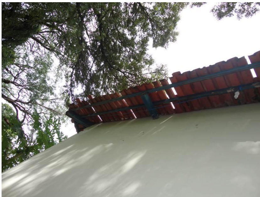
Figura 78 – Vista Externa do Bloco de Sala de Aula – Falha do Telhamento
