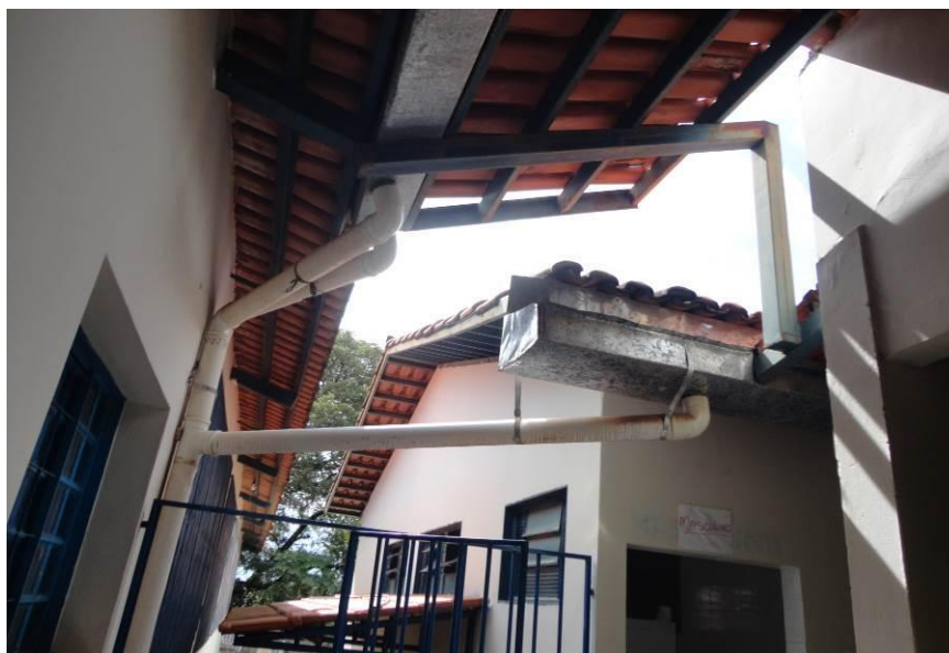
Figura 114 – Vista do Sistema de Calha – Águas Pluviais
