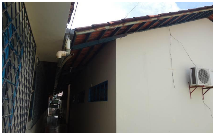
Figura 117 – Vista do sistema de calha
