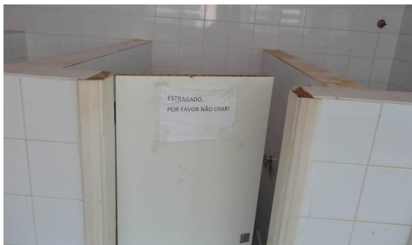
Figura 101 – Vista Interna do Sanitário – Boxes com Defeito
