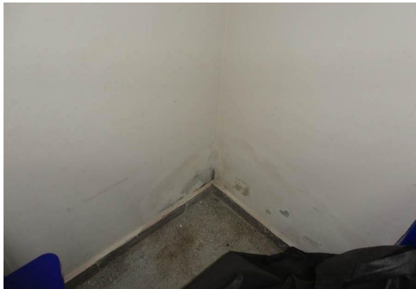
Figura 62 – Vista da Sala Administrativa – Infiltração na Parede
