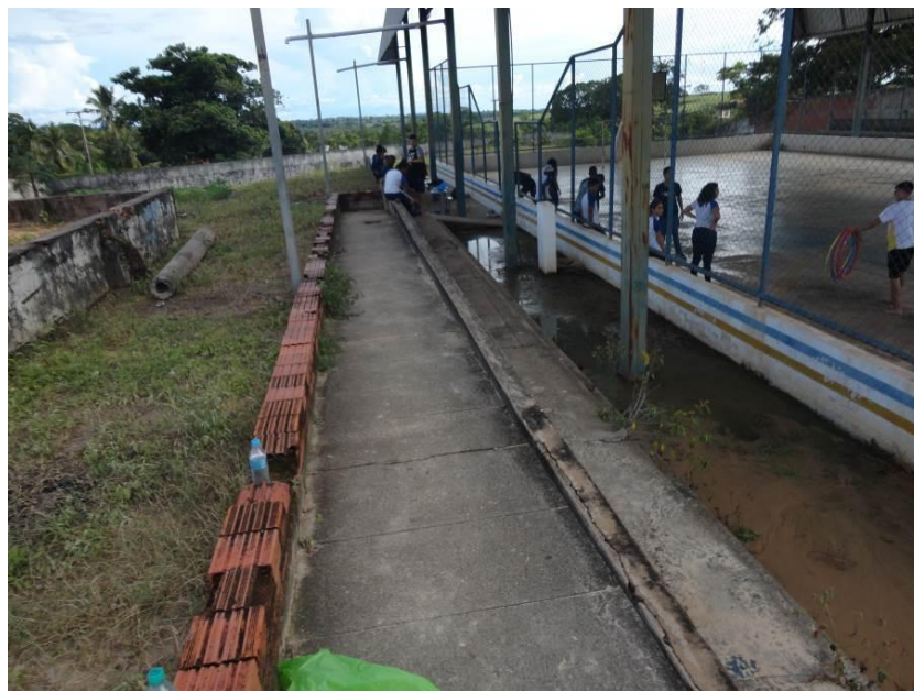
Figura 130 – Vista da Rampa de Acesso a Quadra – Sem Guarda-corpo
