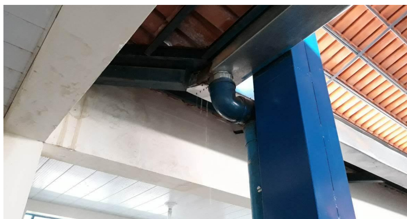
Figura 118 – Vista do sistema de calha
