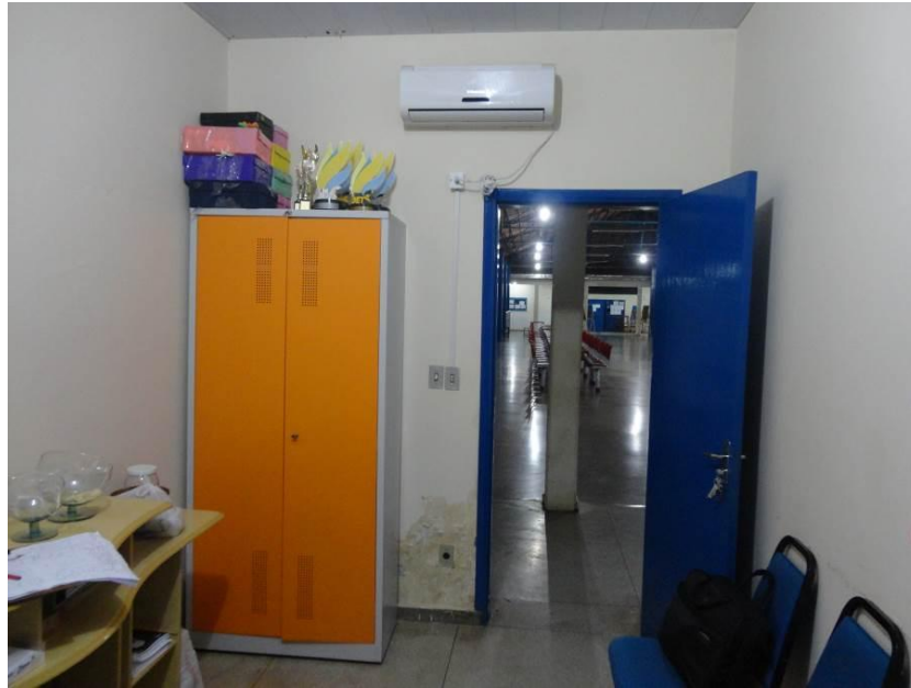
Figura 45 – Vista Interna da Diretoria – Infiltração na Parede
