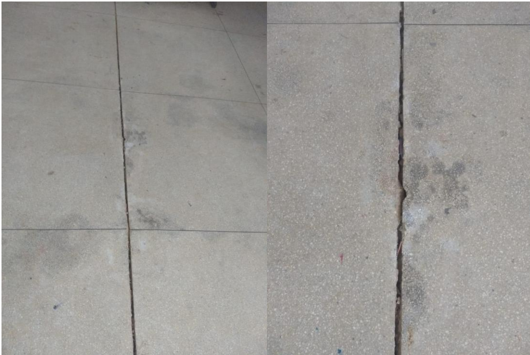
Figura 24 – Vista interna da Sala de Aula – Rachadura no piso
