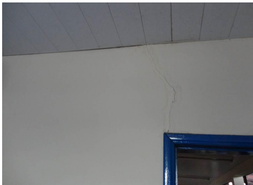
Figura 22: Recalque na Sala de Aula – Rachadura Exposta
