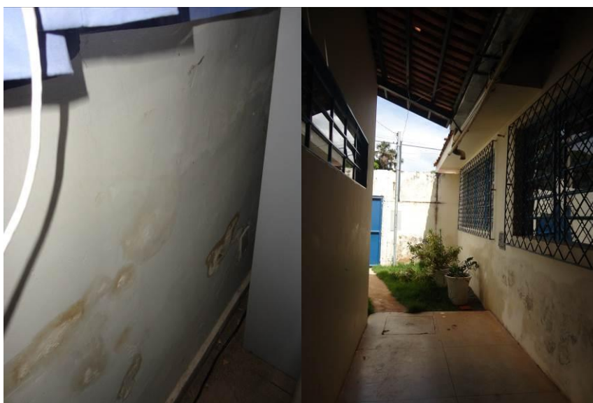
Figura 68 – Vista das Infiltrações – Paredes da Secretaria
