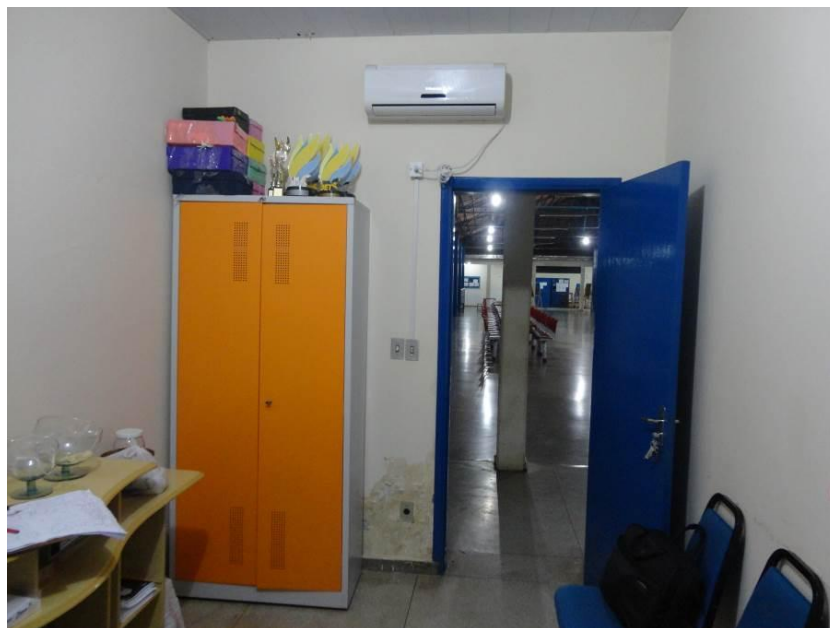
Figura 137 – Condicionadores de AR – Sala da Diretoria
