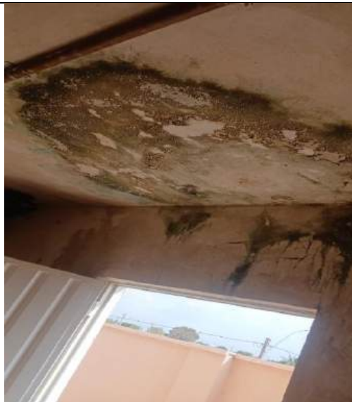
Figura 06 – Infiltração casa de bombas
