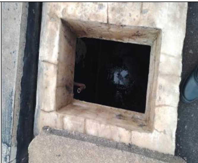
Figura 04 – Tampa do reservatório
