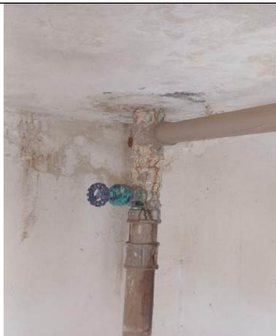
Figura 08 – Infiltração casa de bombas
