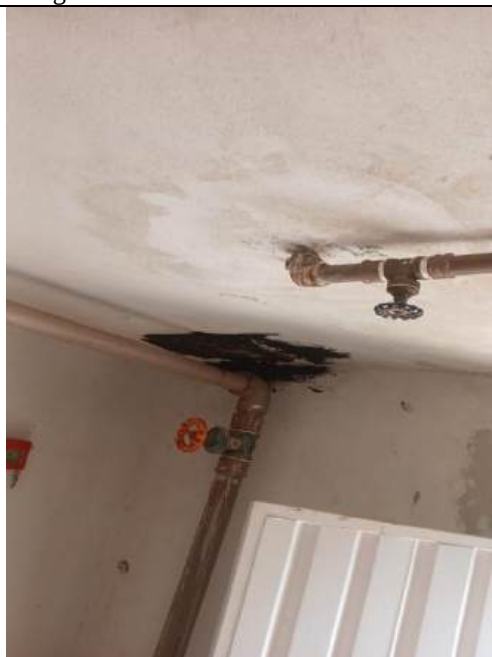
Figura 07 – Infiltração casa de bombas
