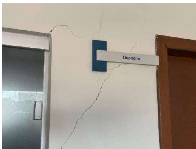
Foto 32 – Diversas rachaduras nas paredes
