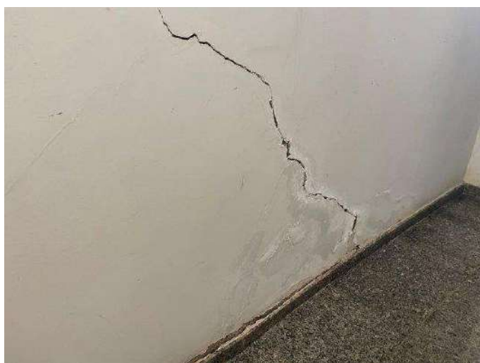
Foto 86 – Rachaduras e infiltrações nas paredes
