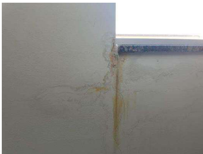
Foto 22 – Trincas e Infiltrações
