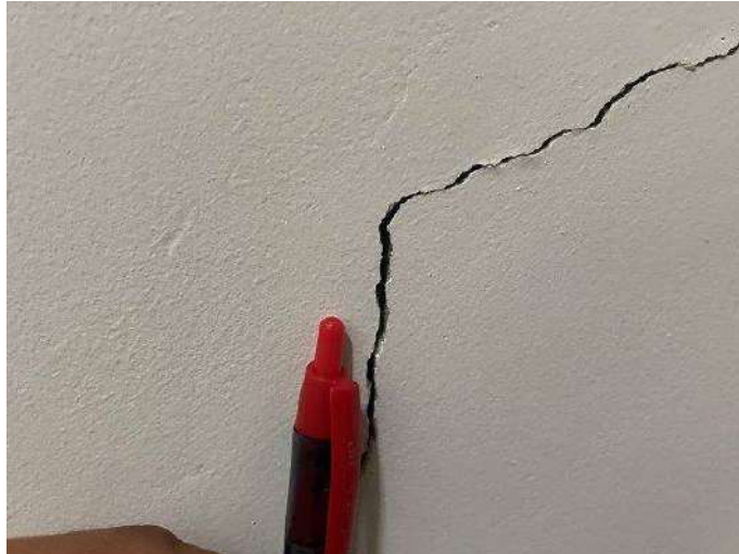
Foto 99 – Rachaduras em paredes
