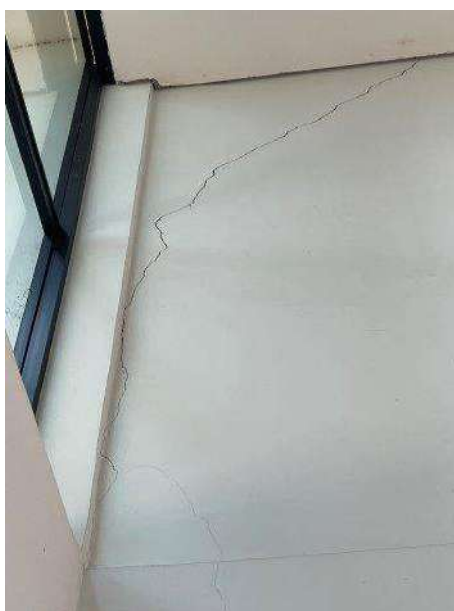
Foto 104 – Rachadura na parede do pav. Superior região da Jardim 3
