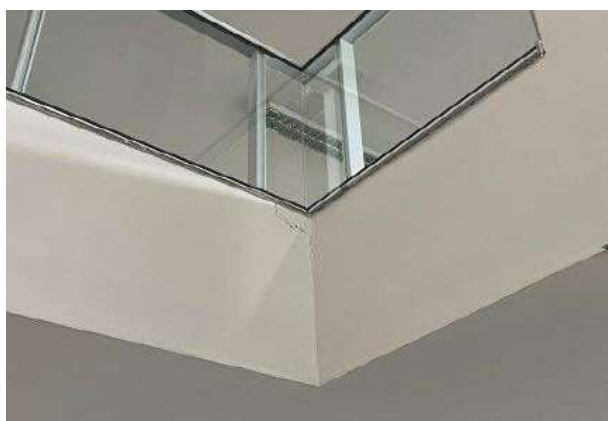
Foto 62 – Viga com fissura na região do Ambiente de Espera do Pav. Superior
