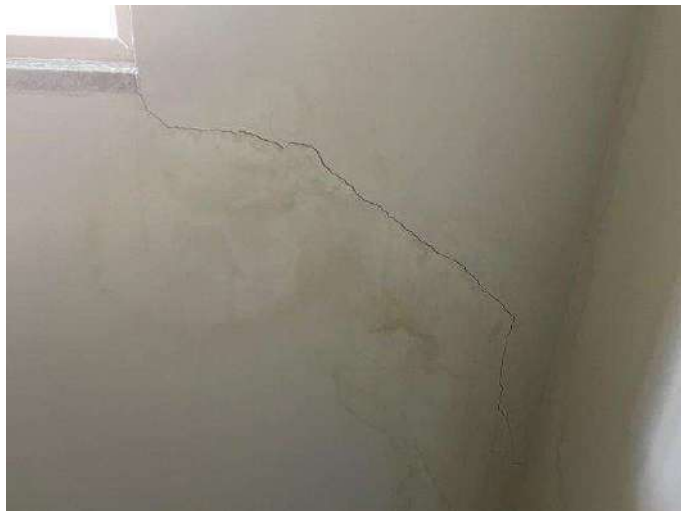
Foto 100 – Rachaduras e infiltrações em paredes
