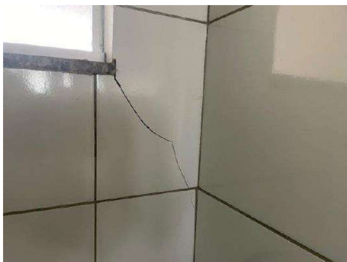
Foto 35 – Rachadura no revestimento cerâmico dos banheiros
