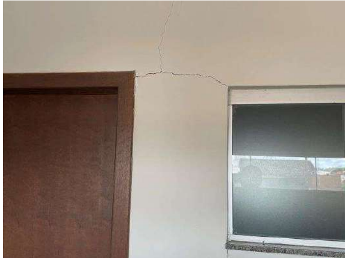
Foto 33 – Diversas rachaduras nas paredes
