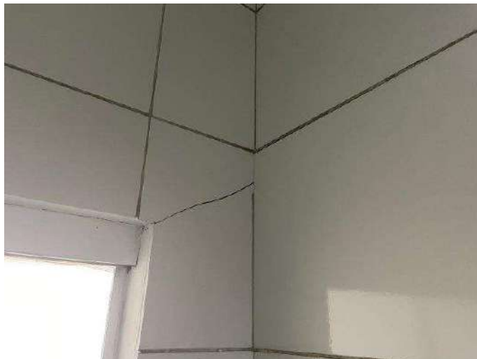
Foto 34 – Rachadura no revestimento cerâmico dos banheiros
