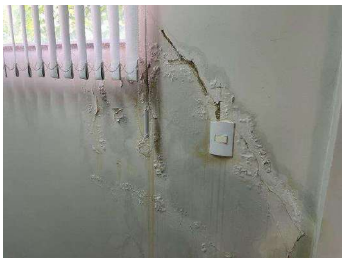
Foto 20 – Rachaduras e Infiltrações
