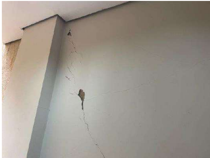
Foto 88 – Rachaduras e deslocamento do reboco nas paredes
