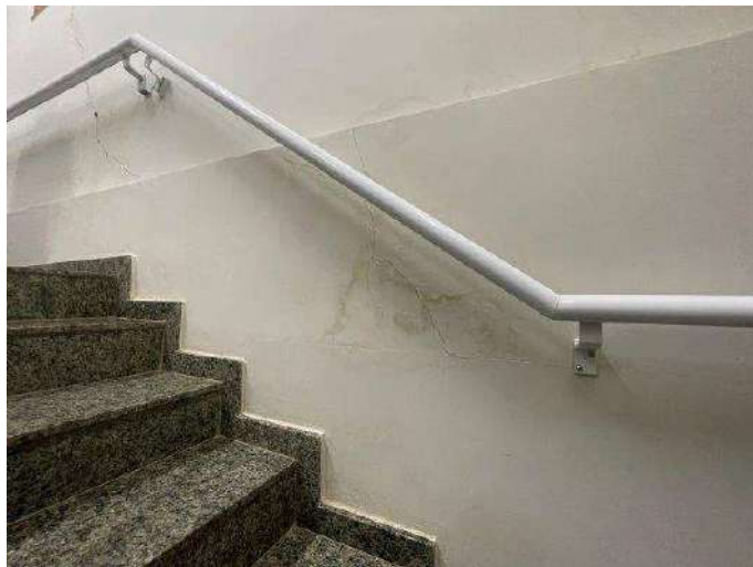
Foto 97 – trincas e infiltrações nas vigas e paredes
