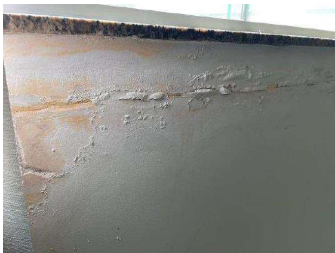
Foto 21 – Rachaduras e Infiltrações
