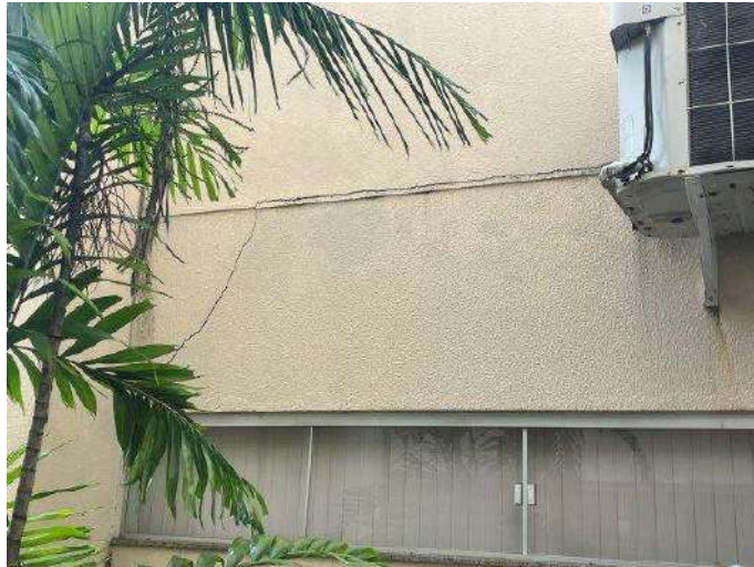
Foto 63 – Rachadura na parede sul do Tribunal do Juri – Vista do Jardim 7
