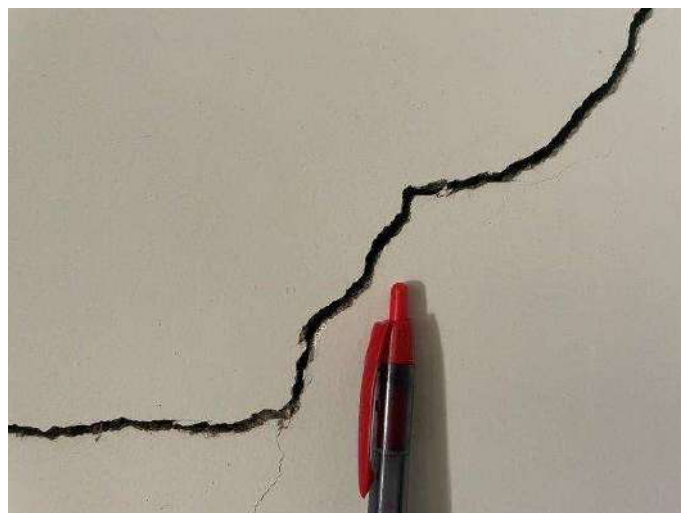
Foto 80 – Rachadura na parede da circulação, próximo a Cella da Espera Policial no Pav. Térreo
