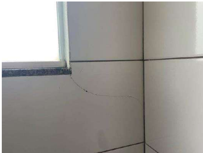
Foto 94 – Trincas nos revestimentos cerâmicos dos banheiros
