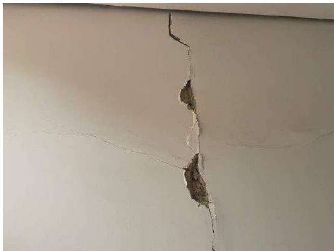
Foto 89 – Rachaduras e deslocamento do reboco nas paredes
