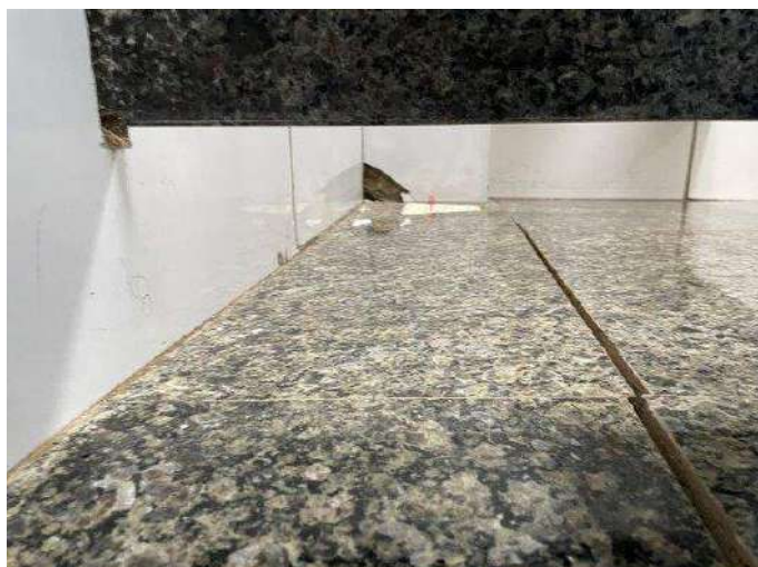
Foto 04 – Piso com desnível no sentido do recalque – Sanit. Masc. – Pav. Térreo
