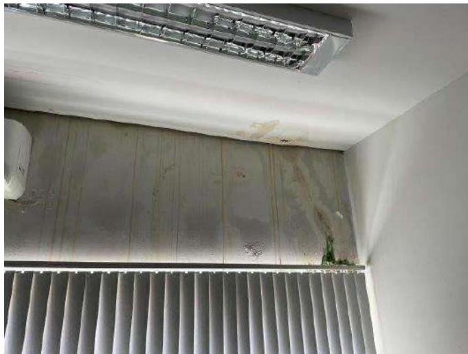
Foto 19 – Infiltração, bolor e lodo pelo excesso de umidade
