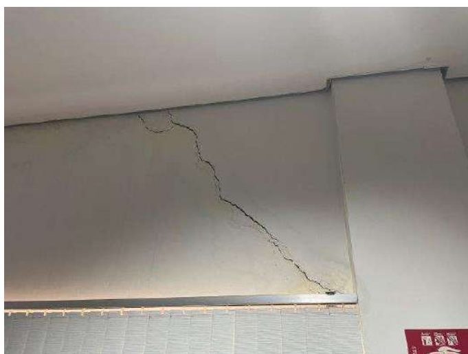
Foto 53 – Rachaduras nas paredes
