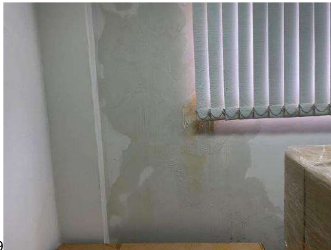
9 Foto 10 – Manchas de infiltração por toda a parede
