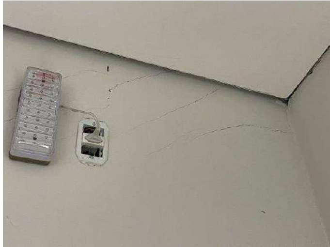
Foto 102 – Rachaduras em paredes
