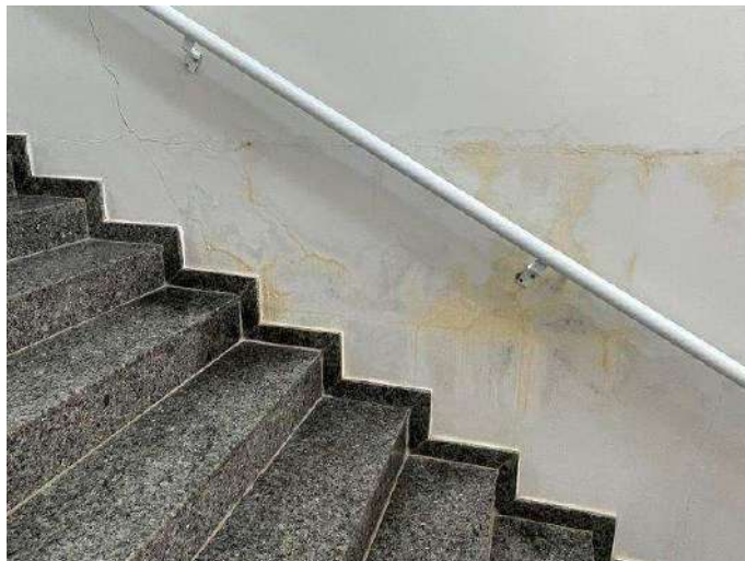
Foto 28 – Trincas em vigas, paredes e infiltrações
