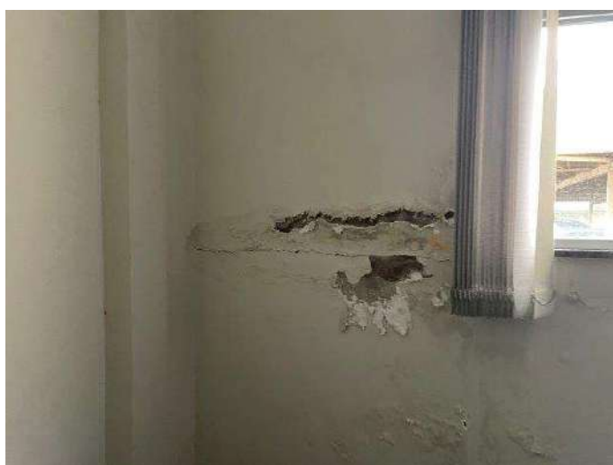
Foto 02 – Infiltrações e fissuras
