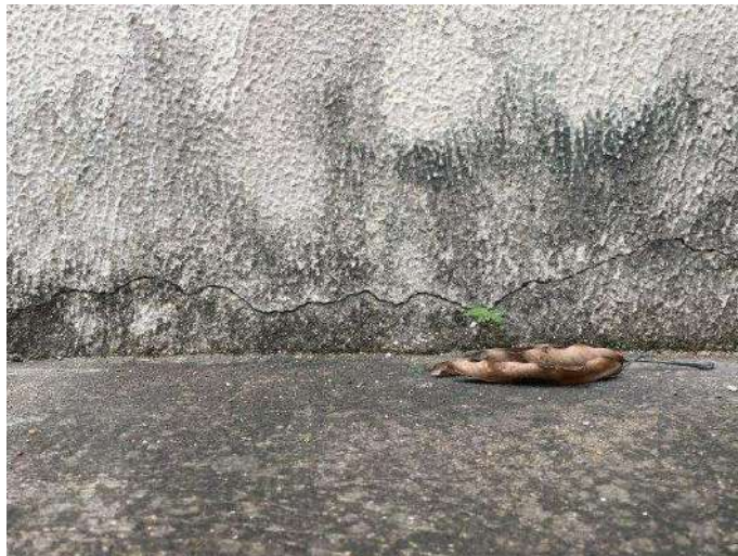
Foto 114 – Rachadura no pé da parede externa do Sanit. Masc. do Pav. Térreo
