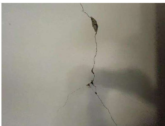
Foto 01 – Rachaduras em paredes
