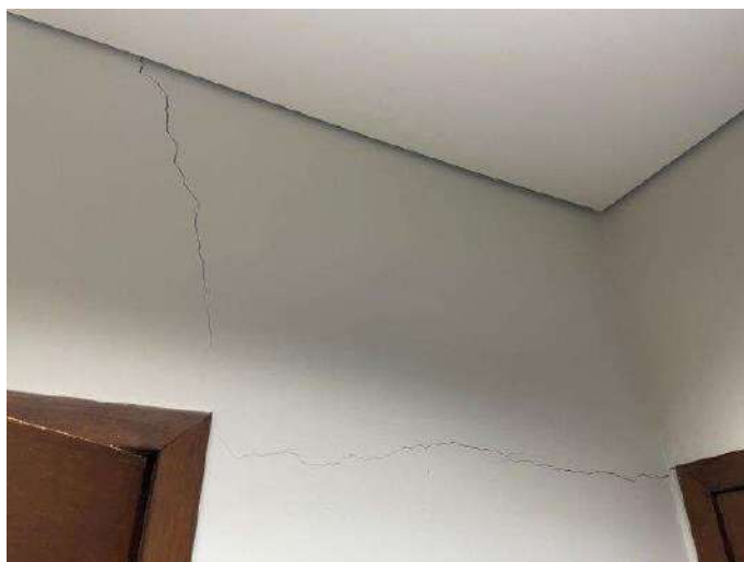
Foto 36 – Rachaduras nas paredes
