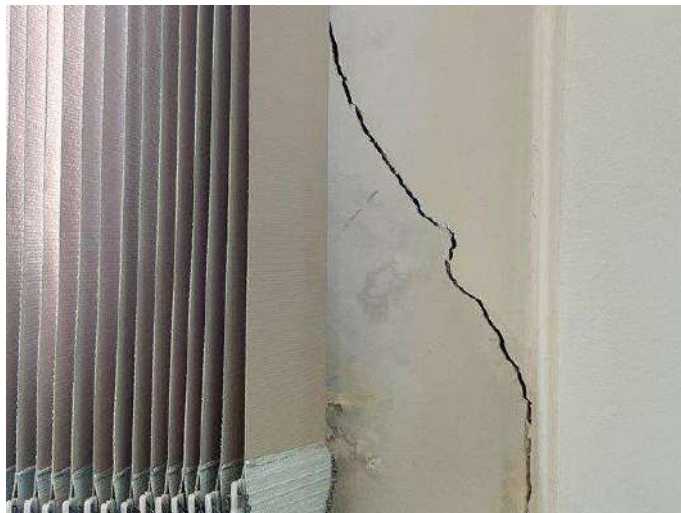
Foto 25 – Rachaduras em parede
