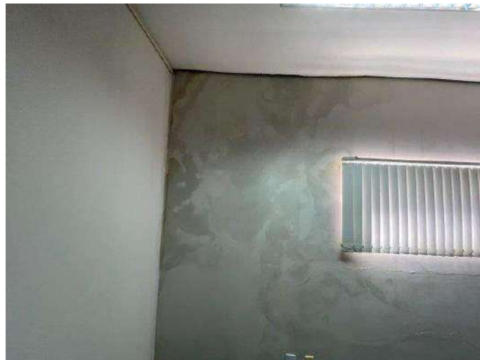
Foto13 – Manchas de infiltração por toda a parede
