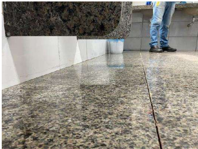
Foto 07 – Piso com desnível no sentido do recalque – Sanit. Masc. – Pav. Térreo
