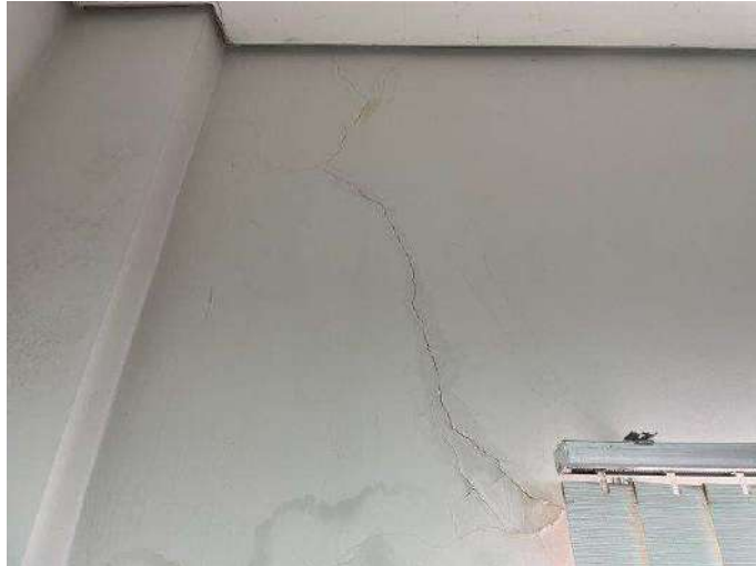
Foto 09 – Trincas em diversos pontos
