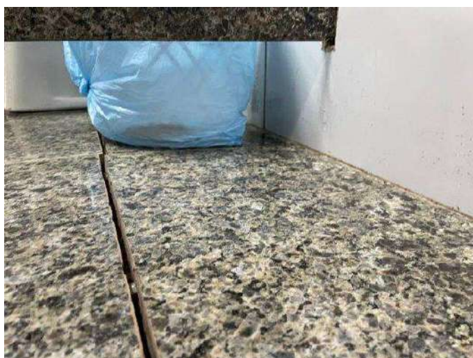
Foto 05 – Piso com desnível no sentido do recalque – Sanit. Masc. – Pav. Térreo
