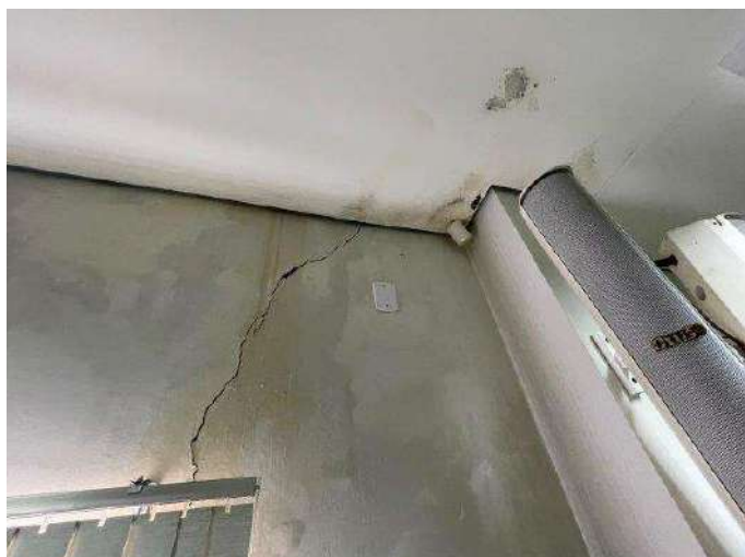
Foto 55 – Rachaduras e infiltrações nas paredes
