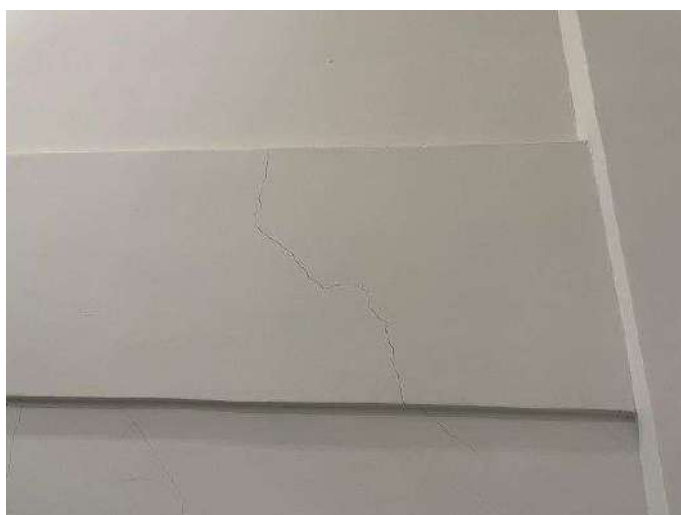
Foto 98 – Trincas em vigas
