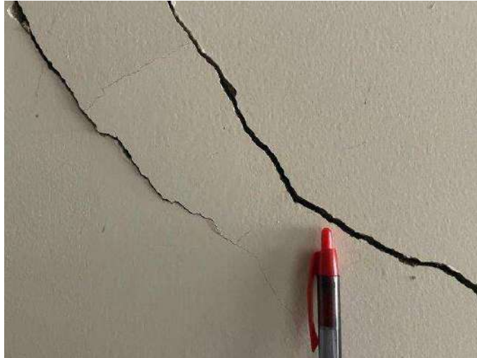
Foto 66 – Rachaduras nas paredes
