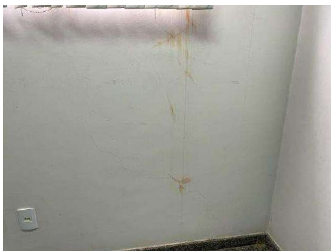
Foto 11 – Trincas com infiltrações
