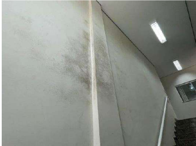
Foto 27 – Bolor por umidade nas paredes
