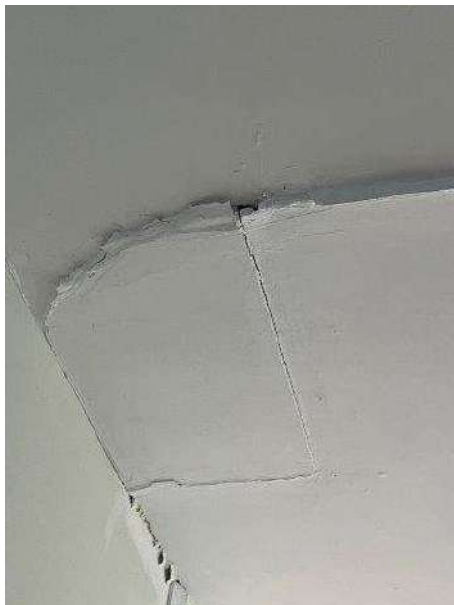
Foto 91 – Rachaduras no forro de gesso
