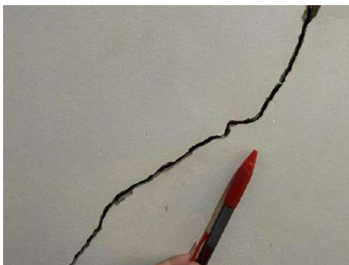
Foto 83 – Rachaduras nas paredes
