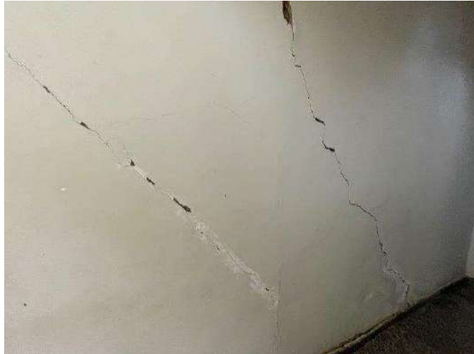
Foto 90 – Rachaduras nas paredes
