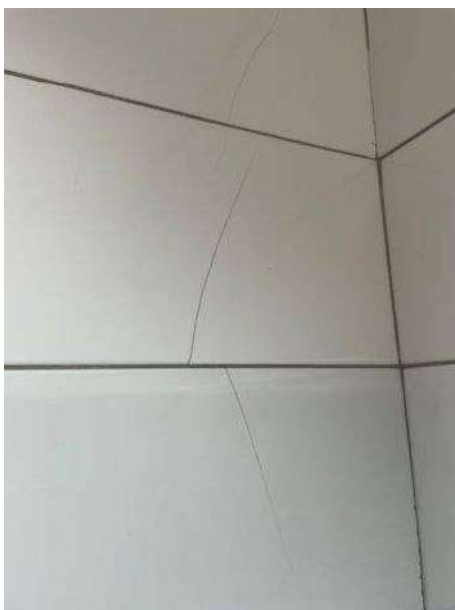
Foto 03 – Fissuras no revestimento
