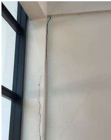
Foto 106 – Rachadura no pilar do Pa. Térreo, próximo ao jardim 3
