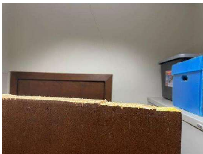
Foto 37 – Porta de madeira serrada para permitir o fechamento, em virtude de recalques – Lavabo do Juiz 02
