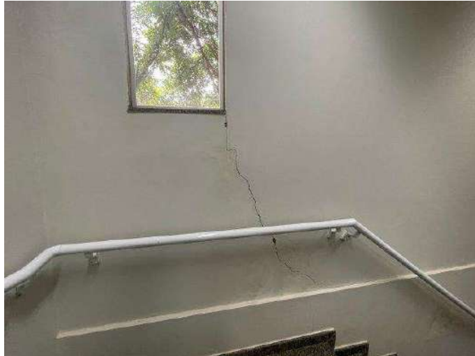
Foto 96 – Rachadura das paredes da Escada 02, com a fachada.
