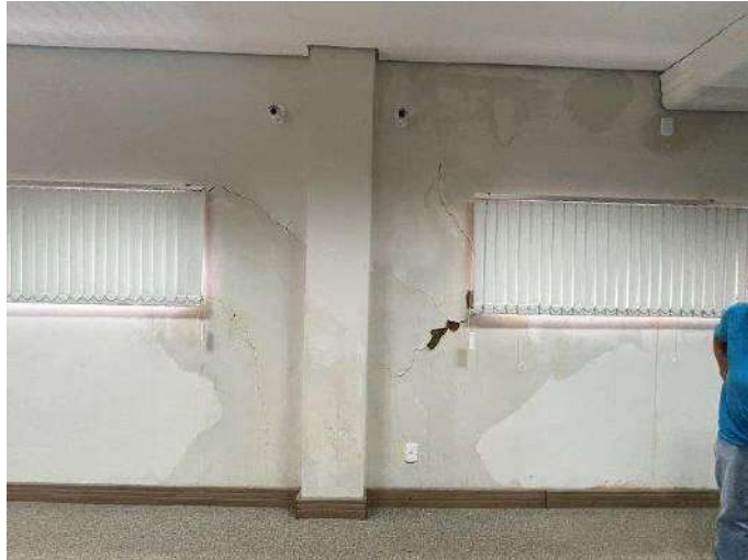
Foto 57 – Rachaduras, infiltrações e deslocamento do reboco nas paredes
