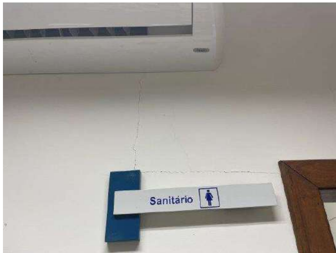
Foto 58 – Rachaduras nas paredes
