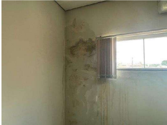
Foto 93 – Infiltrações e bolores nas paredes
