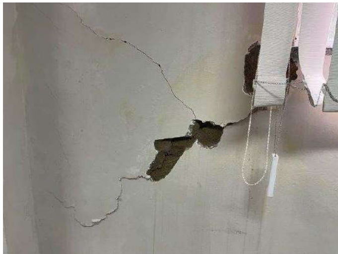
Foto 52 – Rachaduras nas paredes com deslocamento do reboco
