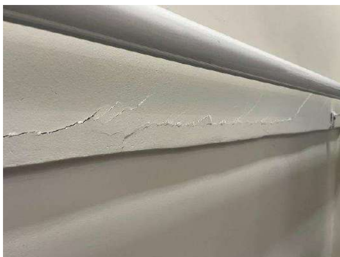
Foto 08 – Trinca em vigas no ambiente da escada
