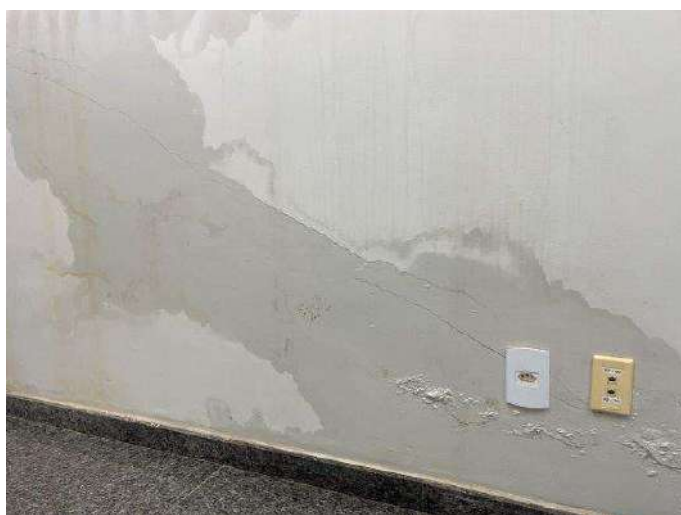
Foto 17 – Trincas e Infiltrações
