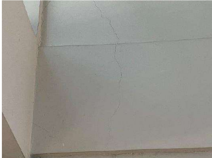
Foto 105 – Trinca na viga do pav. Superior região da Jardim 3
