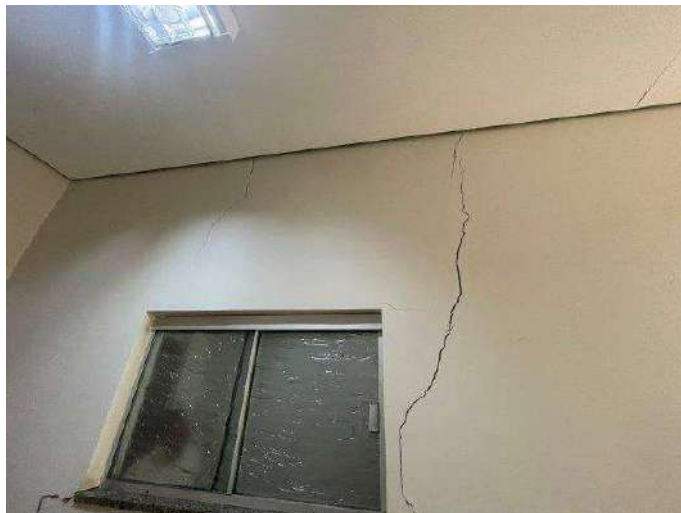
Foto 85 – Rachaduras nas paredes
