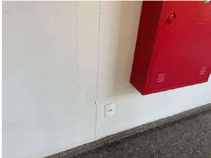
Foto 108 – Rachaduras em paredes
