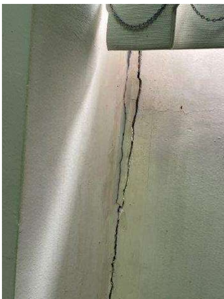
Foto 54 – Rachaduras nas paredes
