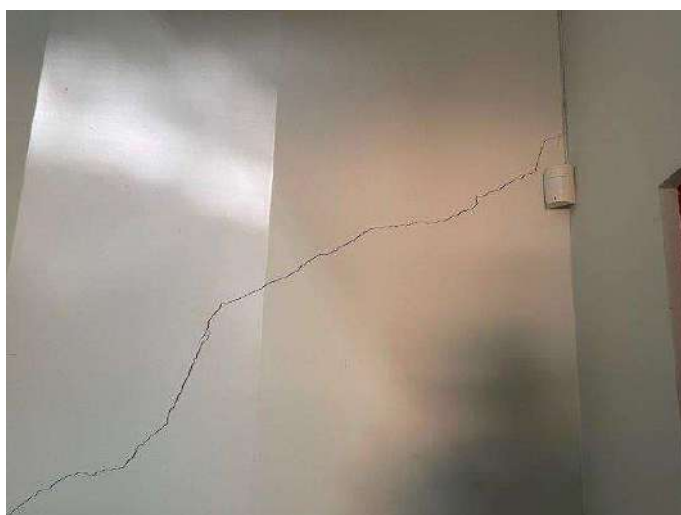
Foto 101 – Rachaduras em paredes
