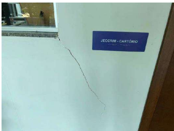
Foto 41 – Rachaduras nas paredes
