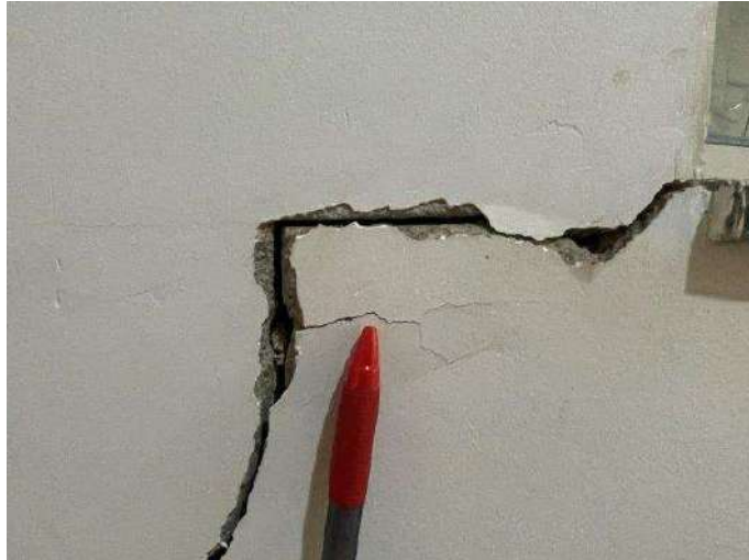
Foto 84 – Rachaduras nas paredes
