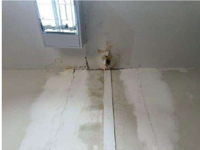
Foto 24 – Infiltração e trincas em parede e forro
