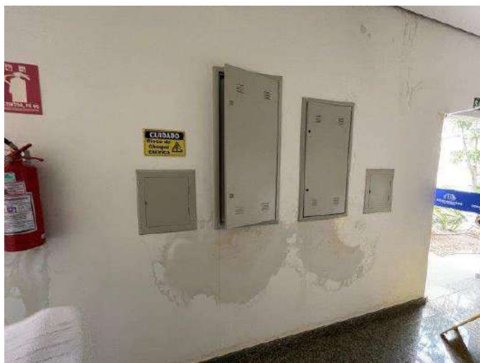
Foto 65 – Quadros elétricos na Circulação Privativa do Pav. Térreo
