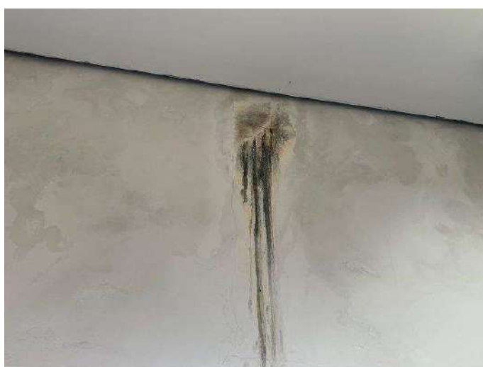
Foto 23 – Infiltrações por fissuras e trincas
