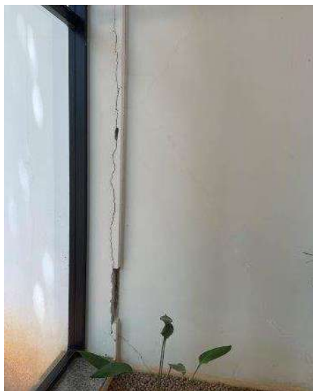
Foto 107 – Rachadura no pilar do Pa. Térreo, próximo ao jardim 3
