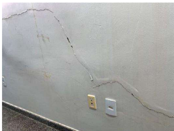
Foto 14 – Rachaduras longas e profundas nas paredes
