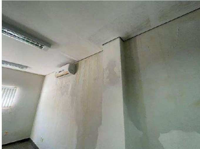
Foto 15 – Infiltrações e bolores por toda a parede
