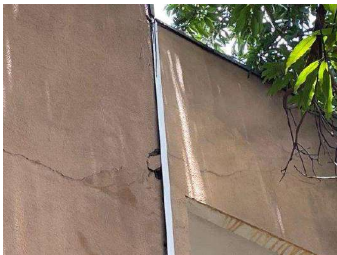
Foto 47 – Vista da Fachada na região da dilatação entre antecâmara 02 e Jardim 03
