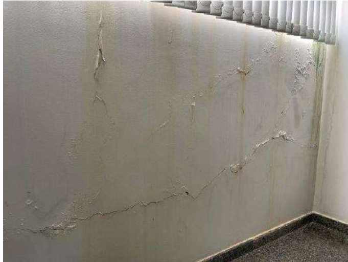
Foto 18 – Rachaduras e Infiltrações
