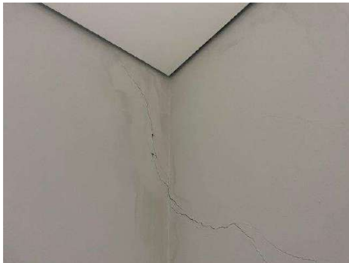
Foto 103 – Rachaduras e infiltrações em paredes
