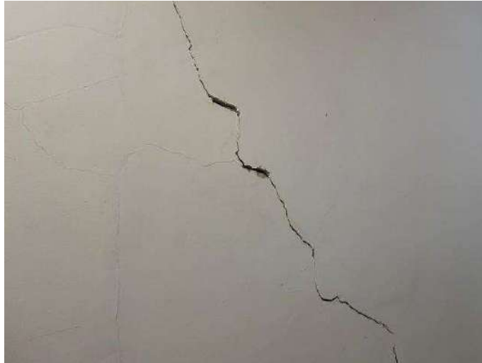
Foto 87 – Rachaduras nas paredes
