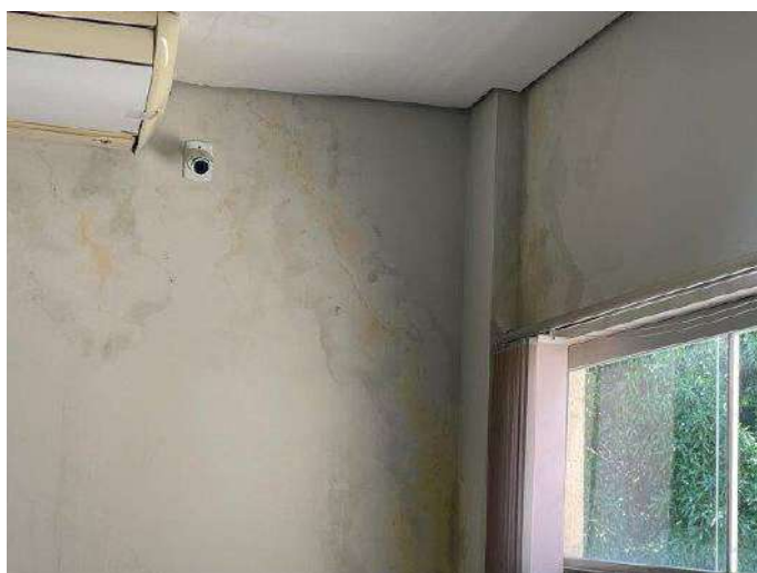
Foto 26 – Bolores e infiltrações espalhadas pelas paredes
