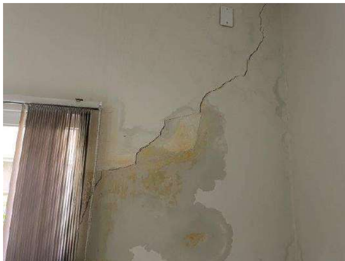
Foto 64 – Rachaduras e infiltrações nas paredes
