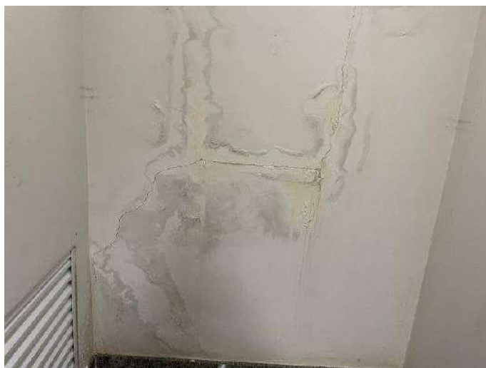
Foto 110 – Trincas e Infiltrações na Antecâmara 01
