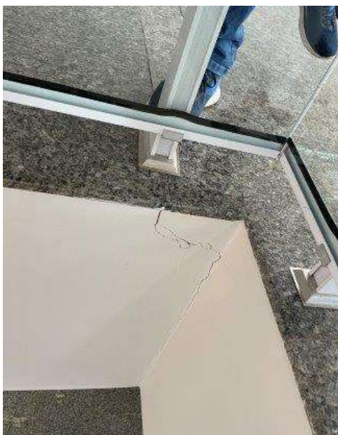
Foto 61 – Viga com fissura na região do Ambiente de Espera do Pav. Superior
