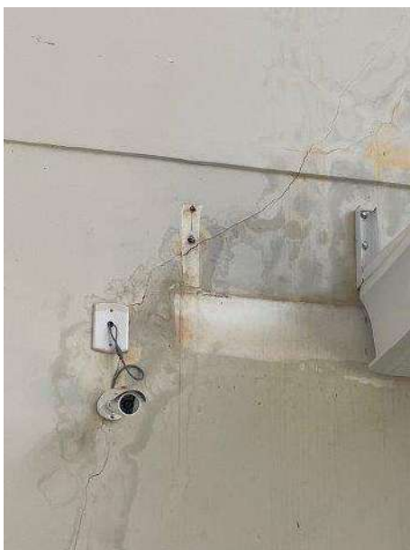
Foto 111 – Trinca na parede leste da Espera 01
