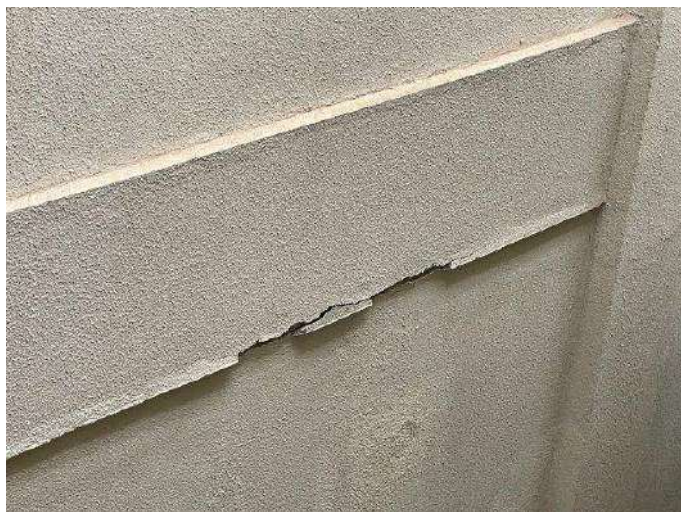
Foto 95 – Deslocamento de requadros de vigas do Jardim 4
