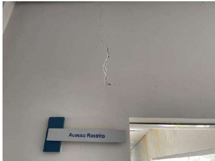
Foto 12 – Rachaduras das paredes
