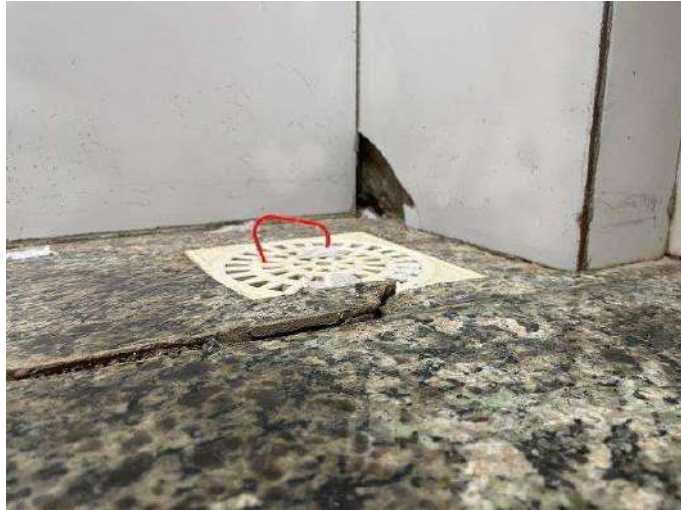
Foto 06 – Piso com desnível no sentido do recalque – Sanit. Masc. – Pav. Térreo
