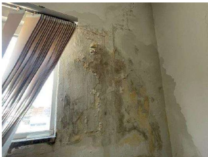
Foto 92 – Infiltrações e bolores nas paredes
