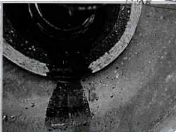
Vazamento de óleo da camara de óleo da bomba.
