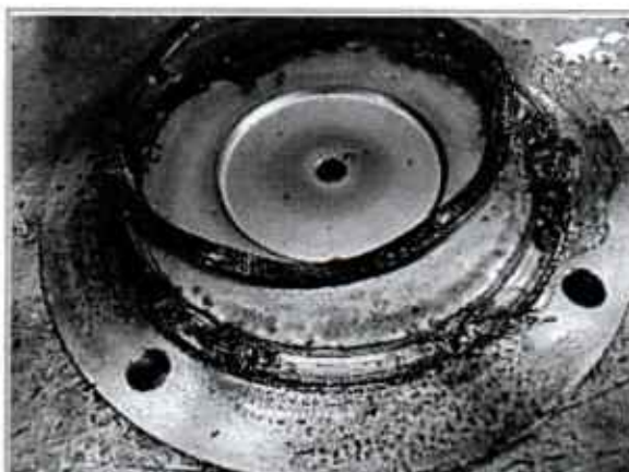
Anel O-ring Danificado.
