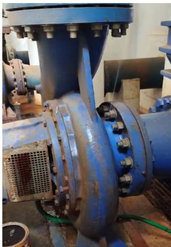
Figura 1 - Registro fotográfico do defeito identificado na carcaça da bomba em operação na EEAT da ETA II.
