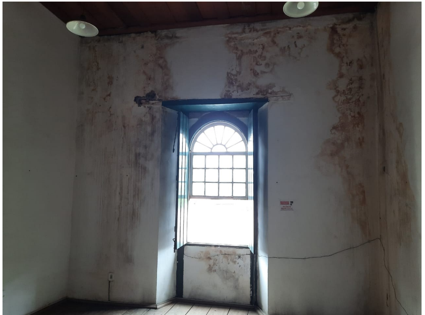
Fotografia a partir do interior do cômodo, cuja visada está indicada ao lado. Na imagem acima é possível perceber uma série de patologias nas paredes, em sua maioria decorrentes de infiltrações provenientes do telhado e da esquadria. Foto: Sayonara Pinto.
