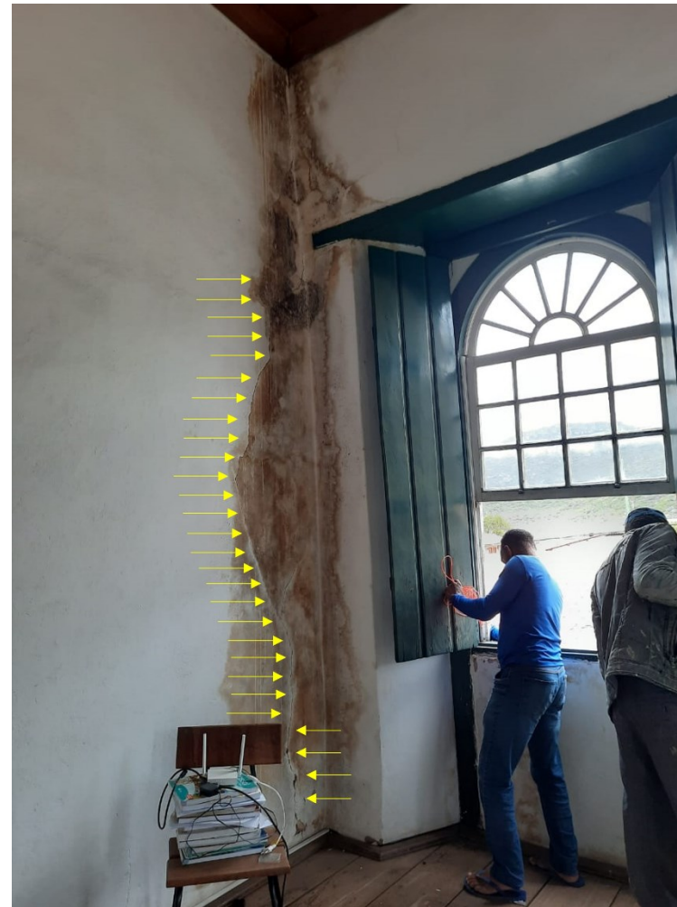
Fotografia da interseção entre a parede externa e a parede de divisa entre cômodos, conforme vista indicada ao lado (outro cômodo). Percebe-se a existência de diversas fissuras (indicadas pelas setas) e concentração de manchas de infiltração de água, embora em menor grau, proveniente do telhado. Foto: Sayonara Pinto.
