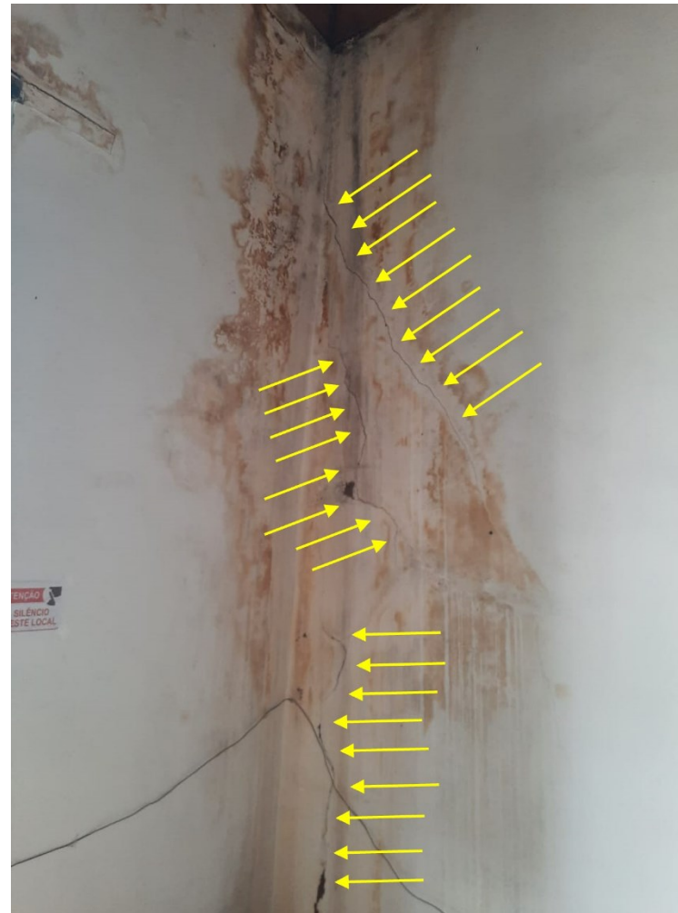
Fotografia da interseção entre a parede externa e a parede de divisa entre cômodos, conforme vista indicada ao lado. Percebe-se a existência de diversas fissuras (indicadas pelas setas) e concentração de manchas de infiltração de água proveniente do telhado. Foto: Sayonara Pinto.
