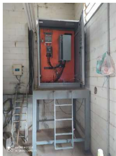
Figura 36: Casa de Energia vista Interna
