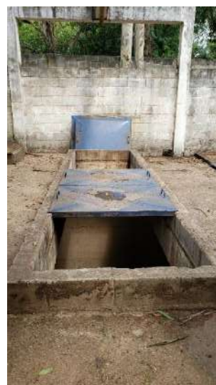
Figura 33: Bombeamento vista externa
