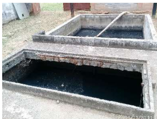
Figura 40: Bombeamento vista externa
