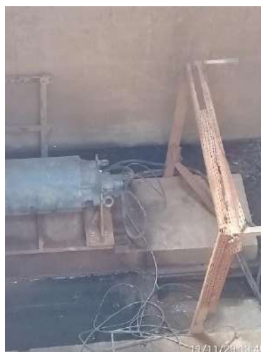
Figura 34: Bombeamento vista interna
