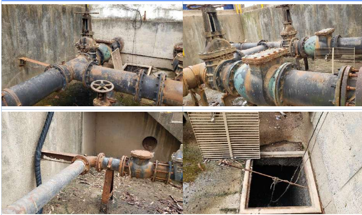
Figura 32: Barrilete Fonte: SANEPRO, 2020.
