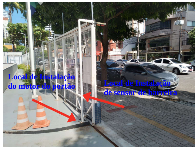
Imagem 02 – Local de instalação do motor e do sensor
