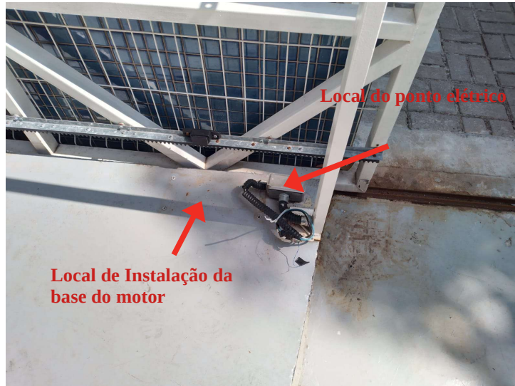
Imagem 05 – Local de instalação da base do motor e ponto elétrico
