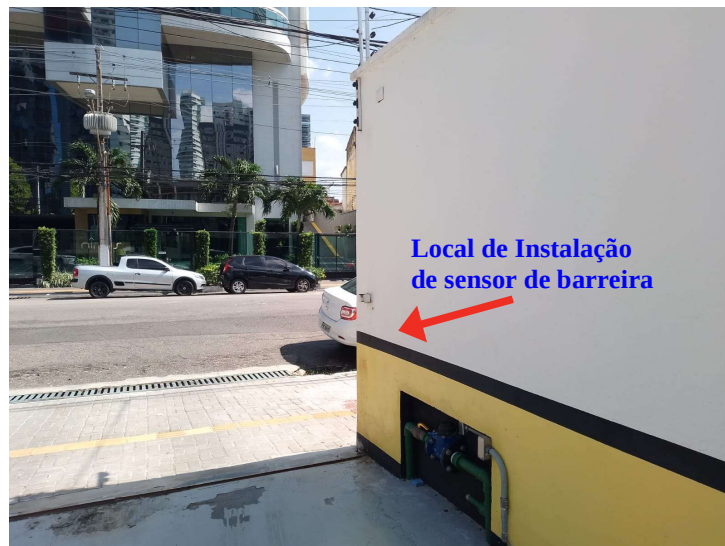
Imagem 09 - Local de instalação da base do motor e ponto elétrico
