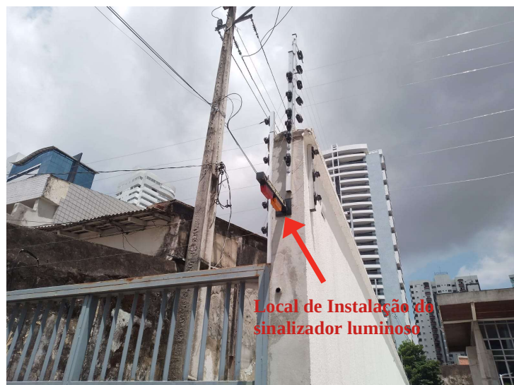
Imagem 10 - Local de instalação do sinalizador luminoso
