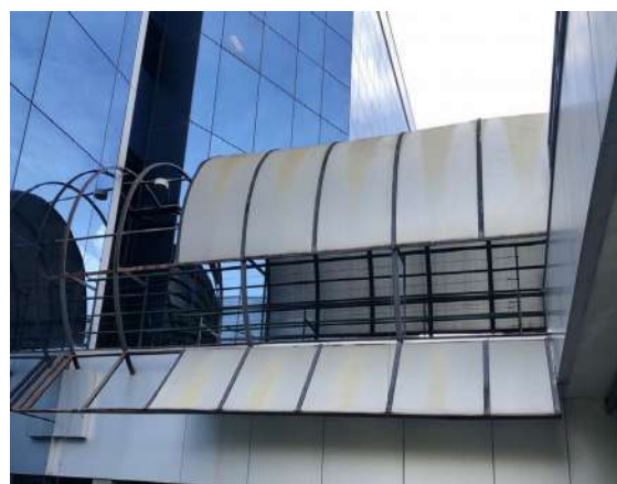
Figura 2: Duas abas sem a chapa de policarbonato, ocasionando a entrada de água em períodos chuvosos.
