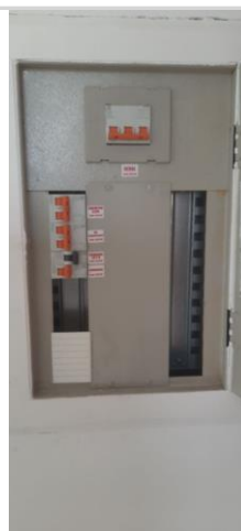
Quadro distribuição Sala 305
