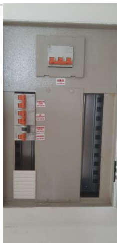
Quadro de distribuição Sala 304
