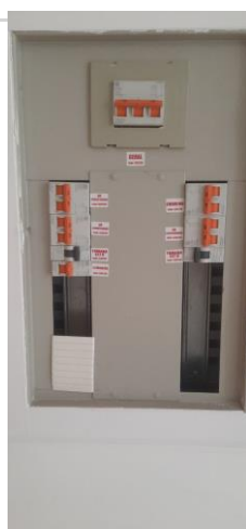
Quadro de distribuição sala 303
