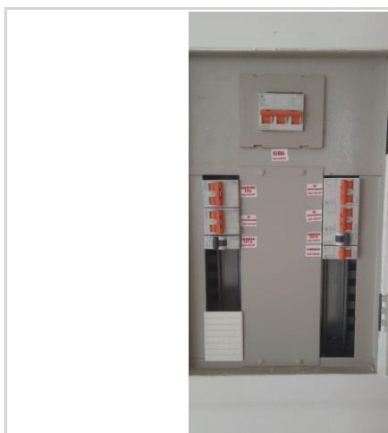
Quadro distribuição sala 302
