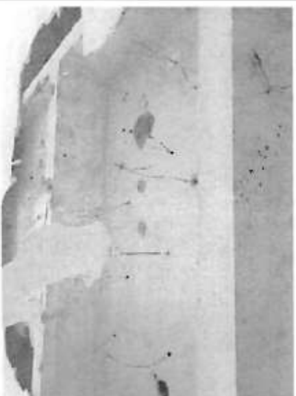
FOTO 10: Situação de parte do tampo de gesso | Sobreloja
