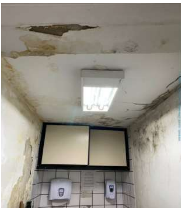
Figura 3 - Parede com infiltração
