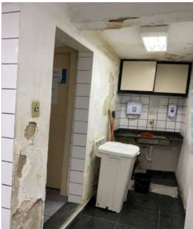
Figura1 – Parede com infiltração
