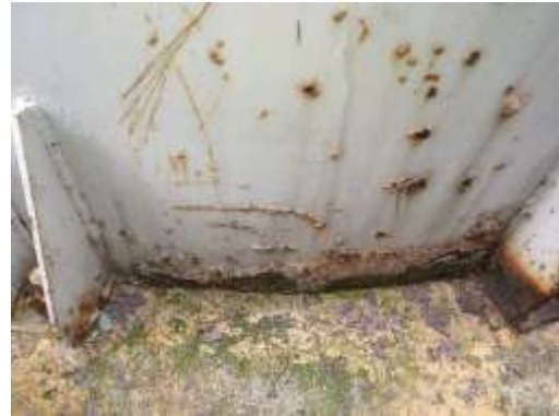
Foto nº 2 – Vista da fixação do castelo d'água na base de concreto, percebe-se avançado estado de corrosão.
