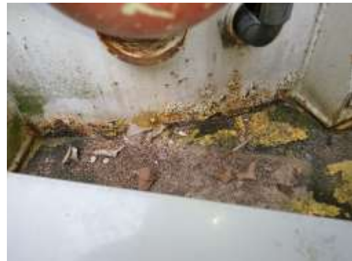
Foto nº 4 – Vista da fixação do castelo d'água na base de concreto, percebe-se avançado estado de corrosão.
