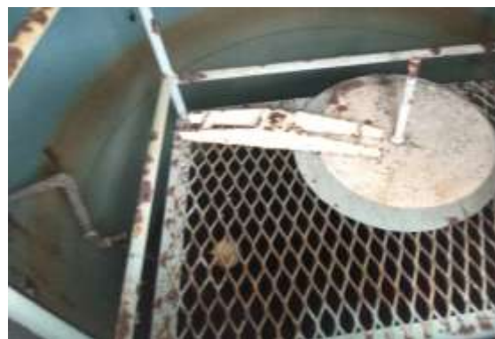
Foto nº 16 – Plataforma de acesso ao reservatório inferior em adiantado estado de corrosão.
