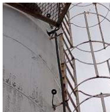
Foto nº 14 – Escada de acesso aos reservatórios, em adiantado estado de corrosão.
