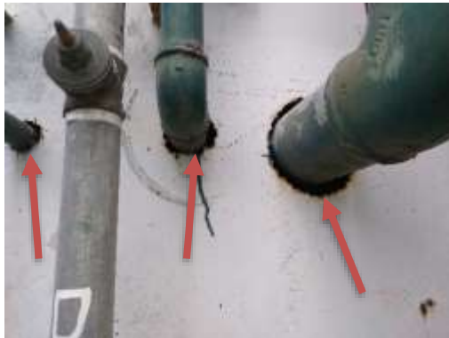
Foto nº 5 – Corrosão nos pontos de entrada de tubulação.
