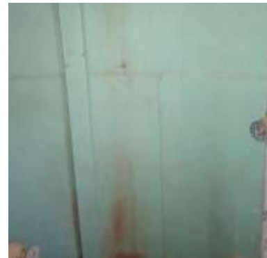
Foto nº 10 – Paredes internas do barrilete, com início de ferrugem.
