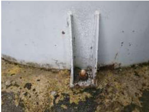
Foto nº 1 – Vista da fixação do castelo d'água na base de concreto, percebe-se avançado estado de corrosão.
