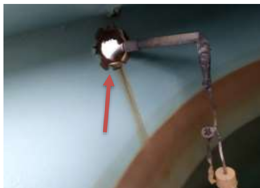
Foto nº 23 – Paredes internas do reservatório superior, percebe-se pontos localizados de corrosão.
