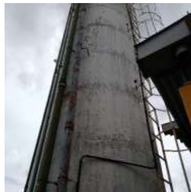
Foto nº 12 – Vista externa do castelo d'água, faz-se necessário nova pintura.
