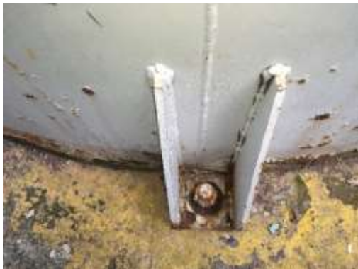
Foto nº 3 – Vista da fixação do castelo d'água na base de concreto, percebe-se avançado estado de corrosão.
