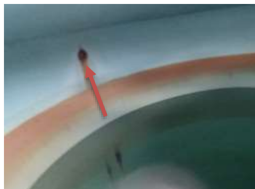
Foto nº 24 – Paredes internas do reservatório superior, percebe-se pontos localizados de corrosão.
