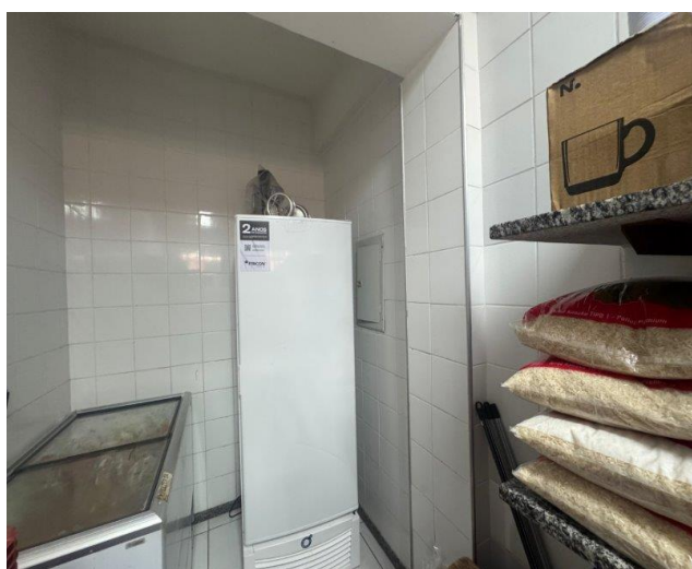
Foto 14 – Quadro elétrico da cozinha com necessidade de ser refeito e realocado
