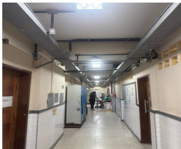
Foto 15 – Poluição visual nos corredores devido à infraestrutura aparente
