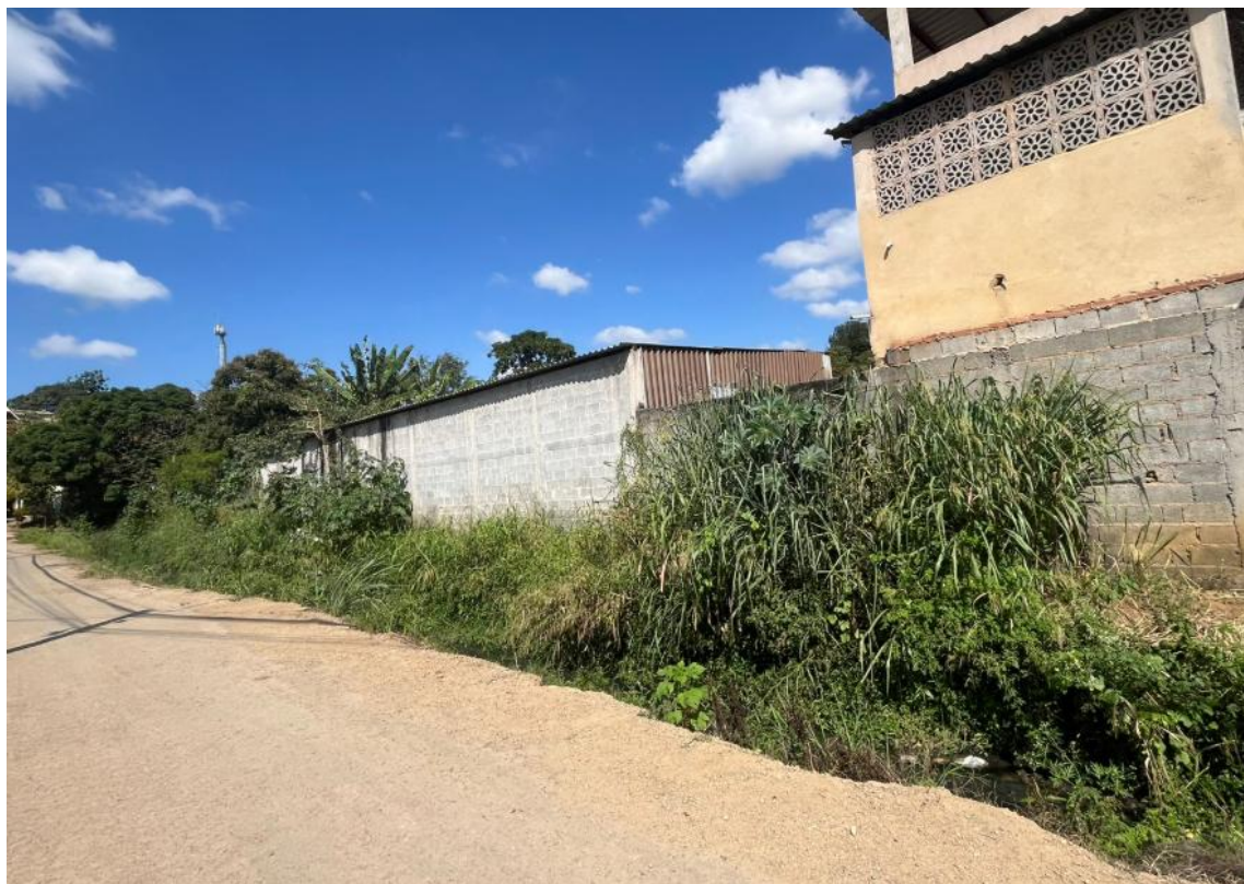
Imagem 17: Foto atualizada do local da obra – Local de passagem da galeria de drenagem.
